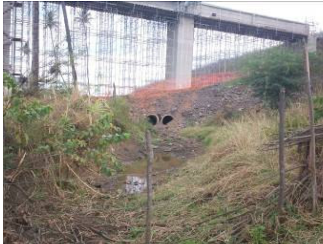
Foto 5.1.1-4 – Riacho dos Milagres (PE 01M): trecho sob influência das obras de transposição do curso d'água pela ferrovia.
