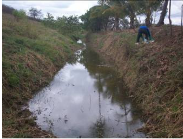
Foto 5.1.1-3 – Riacho dos Milagres (PE 01M): margens parcialmente retificadas no trecho a montante das obras.
