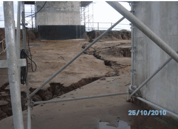
Foto 5 : 26/10/2010 Processos erosivos semelhantes em toda a área ensecada
