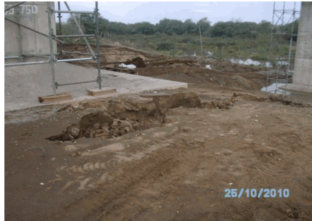
Foto 2 : 26/10/2010 Início de erosão na base de um dos pilares da ponte
