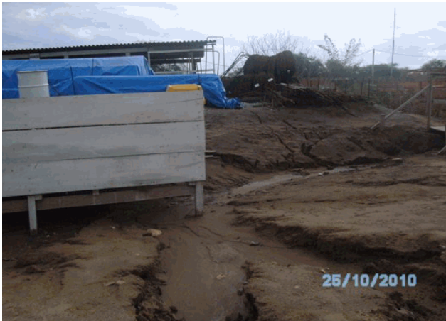
Foto 1 : 26/10/2010 Início de processo erosivo próximo da canteiro avançado da Ponte do Rio Pajeú
