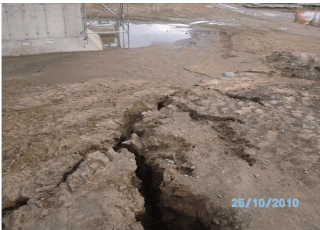
Foto 3 : 26/10/2010 Erosão no sentido do escoamento
