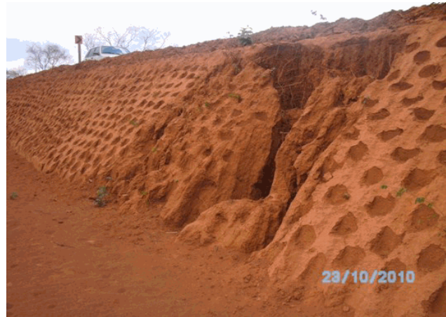
Foto 2 : 17/02/2011 Visão aproximada do foco erosivo. O Processo manteve-se estável
