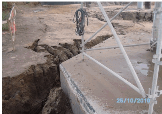
Foto 4 : 26/10/2010 Ravinas formadas na base de um dos pilares ponte do Rio Pageú
