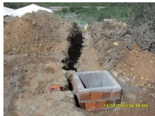
Foto 4-46 Caixa de gordura acoplada ao sistema de efluentes.
