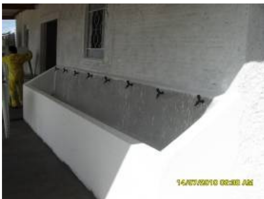
Foto 4-61 Lavatório para higienização antes das refeições.
