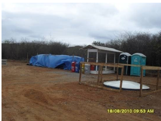
Foto 4-51 Fossa séptica localizada no canteiro provisório do Lote 3.
