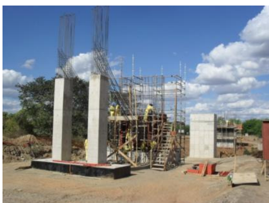
Foto 3-11 Várias pontes encontram-se em execução em praticamente todos os Lotes mobilizados até o momento.
