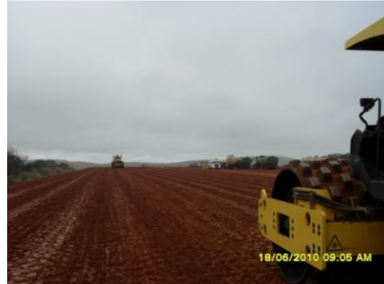
Foto 3-6 Terraplanagem nos locais onde já ocorreu a limpeza da faixa de domínio.
