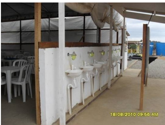
Foto 4-55 Lavatório para as mãos, instalado nas proximidades do refeitório.
