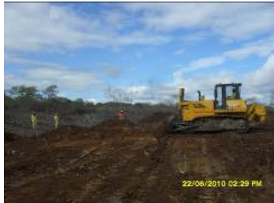
Foto 4-4 A limpeza e o destocamento da faixa de domínio é executada com trator esteira.
