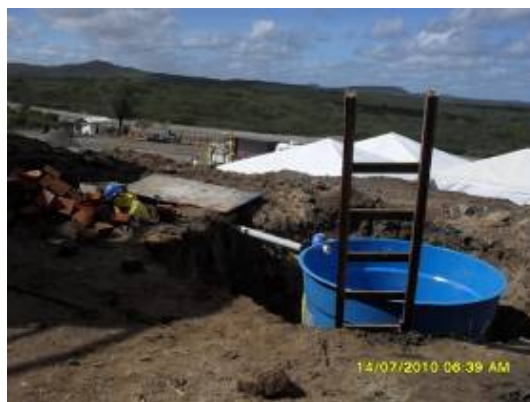
Foto 4-45 Instalações de fossas sépticas de acordo com a necessidade nos Lotes.
