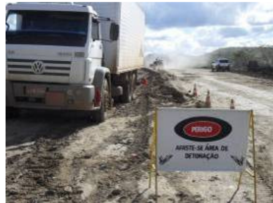
Foto 4-16 Placas de sinalização provisória nas vias de acesso, quando necessárias.
