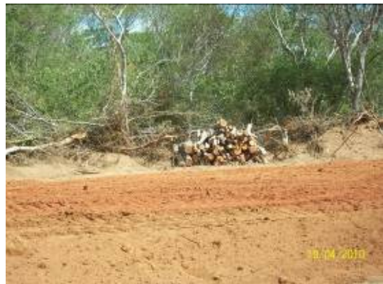
Foto 4-6 O enleiramento é realizado dentro da faixa de domínios, ao longo dos Lotes.
