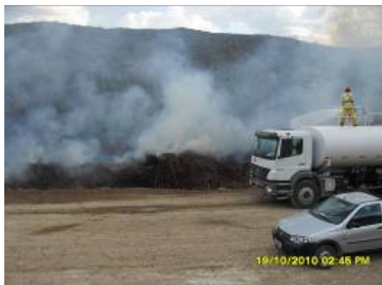
Foto 4-127 Fogo em grande proporção, combatido por funcionário da construtora.
