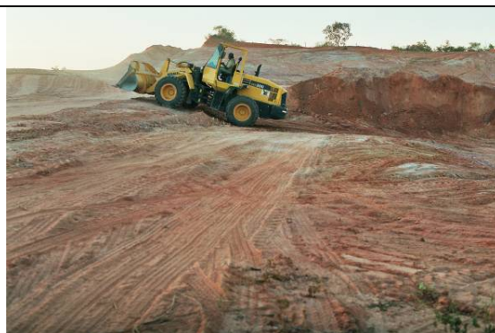
Foto 25_0278 (pto. 66): área de empréstimo para aterro da ferrovia da CFN já em construção, em arenitos rosados finos, alterados, da formação Mauriti.
