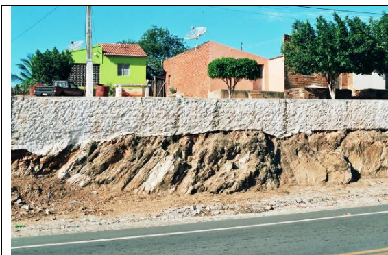
Foto 3A_0188 (pto. 48): afloramentos rochosos no domínio da Unidade Acopiara, próximo ao traçado da ferrovia.
