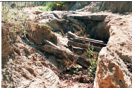
Foto 24A_0208 (pto. 54): aspecto de erosão no leito de estrada próximo ao local do traçado da ferrovia; a erosão desenvolveu-se em saprolitos incoesos de gnaise do Complexo Jaguaretama.
