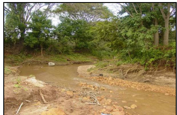
Foto 18 - Vista do riacho Boqueirão a jusante do local de coleta (EST3), onde está sendo instalada a ponte sob a Ferrovia Transnordestina.
