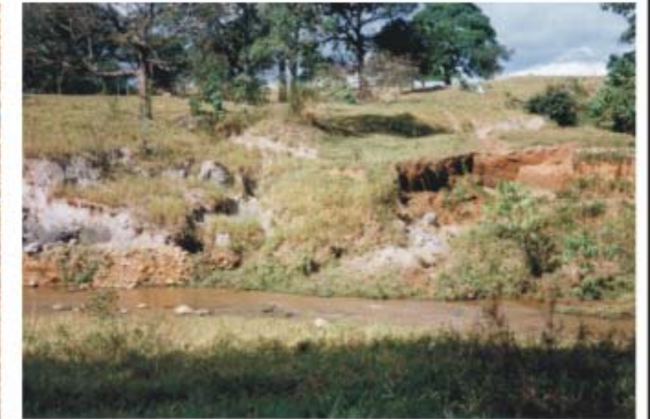
Desenvolvimento de processo erosivo na margem direita do Córrego Grande à jusante da ponte da BR-070.
