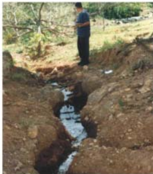
Detalhe do processo erosivo provocado pelo escoamento das águas da drenagem, após a travessia sobre a BR-070, com o Córrego Grande ao fundo.
