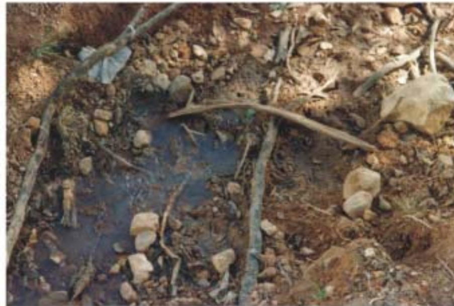
Detalhe do ponto de infiltração das águas da drenagem, contribuindo para a instabilidade do maciço adjacente ao Córrego Grande
