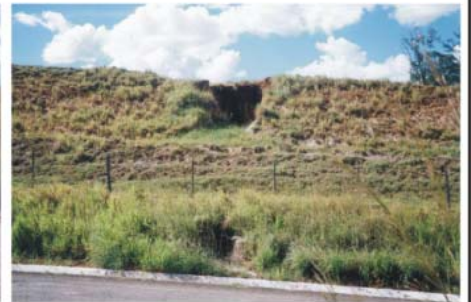
Detalhe de início de processo erosivo no talude de corte da GO-427.
