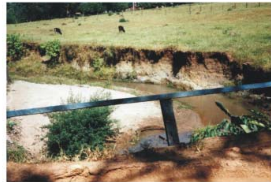
Detalhe da ponte sobre o Córrego Grande, próximo ao ponto de deságue do afluente. Destaque para a ausência de mata ciliar.
