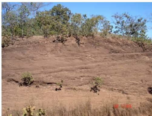
Figura 5.1-59 - Talude em saprolito. Apesar de alterada a rocha ainda guarda estruturas da rocha que podem deflagrar processos de desmoronamento (Coord.: 22L 606.551/8.391.826).
