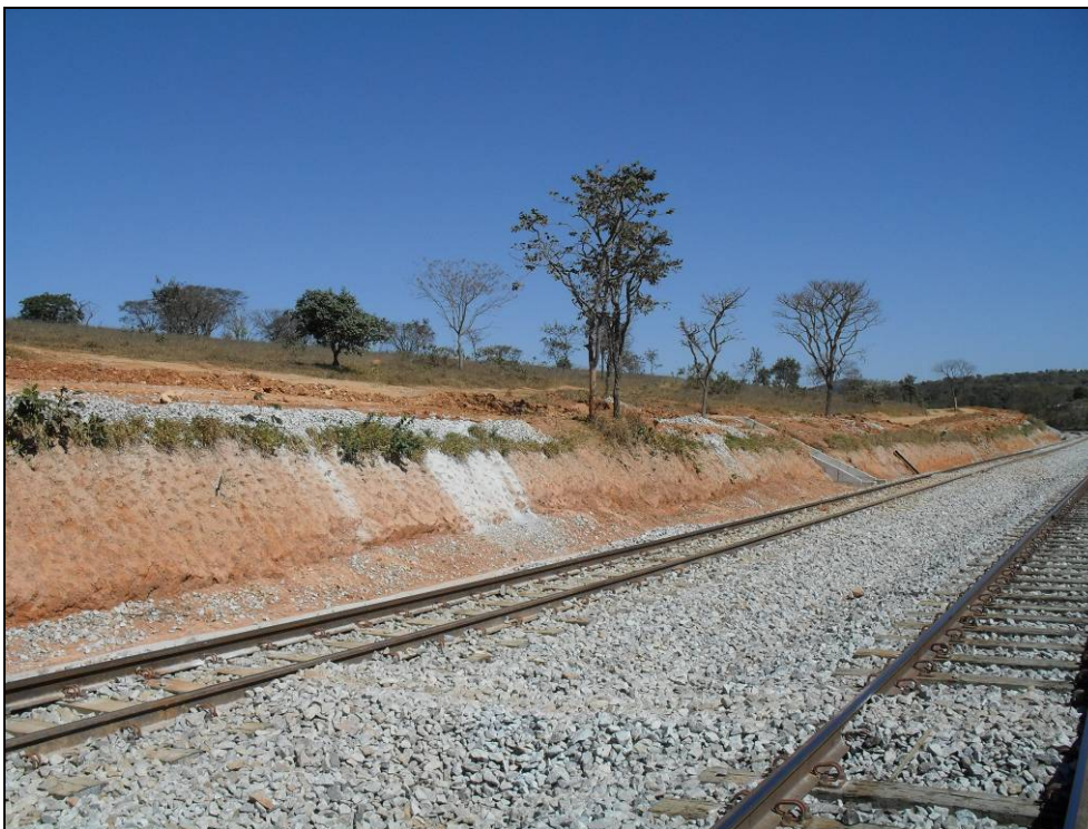
Foto 4 - Talude a ser recuperado na área de ampliação do Pátio Ferroviário de Hélio Torres.
