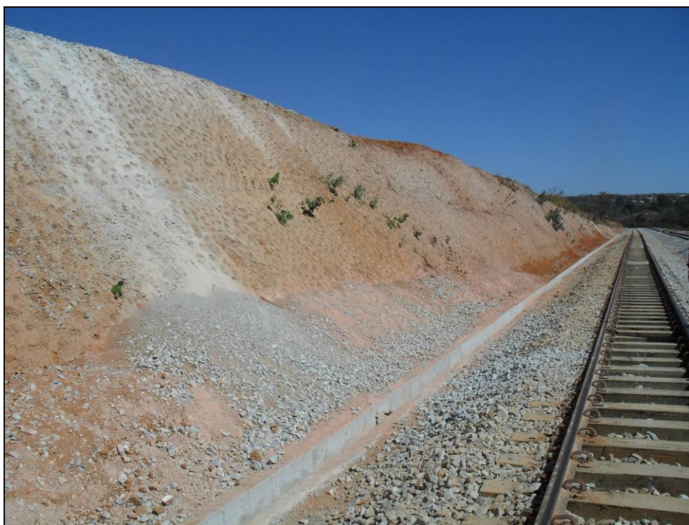
Foto 3 - Talude a ser recuperado na área de ampliação do Pátio Ferroviário de Hélio Torres.
