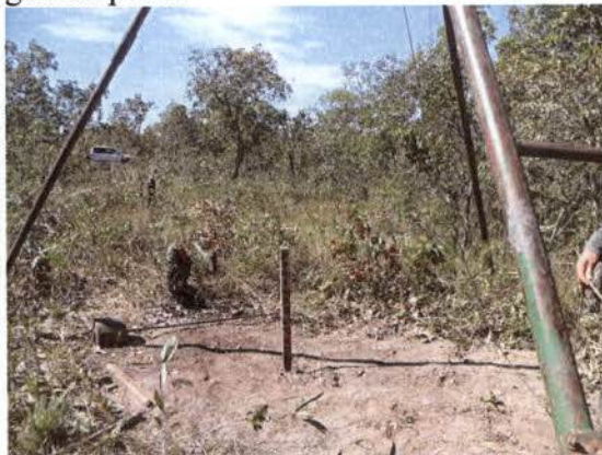
Figura 49 – Abertura de picada no lote 7 da FIOLE, em área com vegetação rala.
