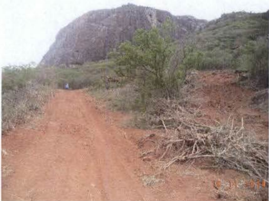
Figura 29 – Abertura de acesso no lote 5 da FIOI, evidenciado apenas o corte de galhos com menos de 5 cm de diâmetro.
