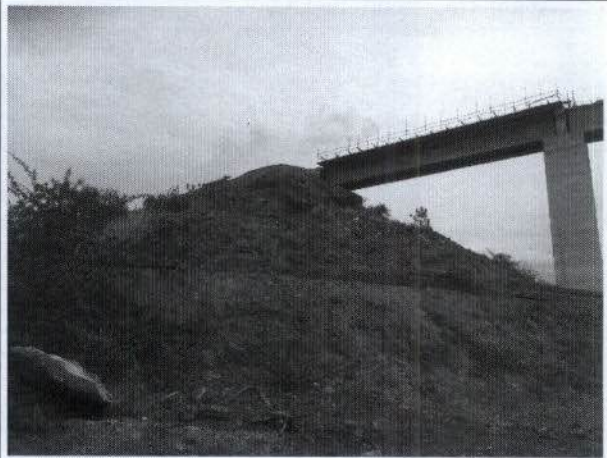
8. Talude da ponte 18 já hidrossemeado, mas com foco de erosão na base. Recomendado enrocamento.
