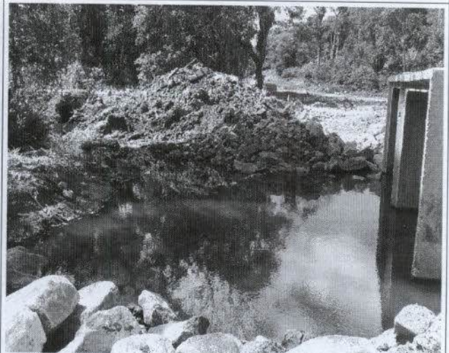
12. Expurgo em APP (Km 1442+400)
