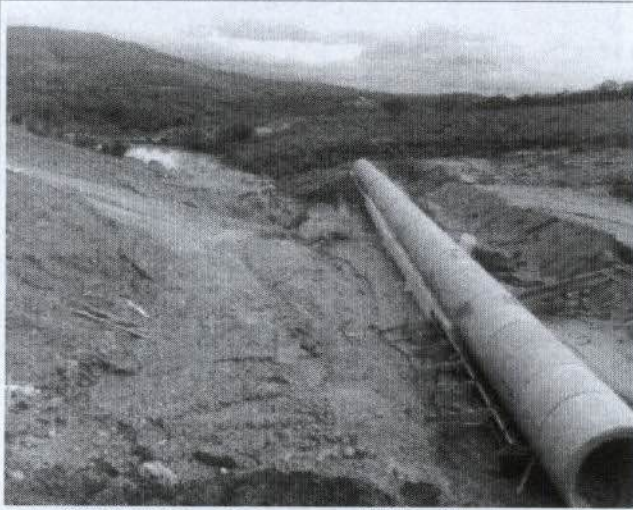
Foto 07 -Km 957+660 - erosão e carreamento de material próximo a obra de execução de bueiro
