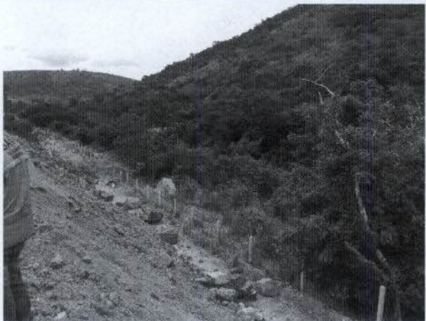
11. km 1342+140 próximo ao Rio de Contas com processo erosivo.
