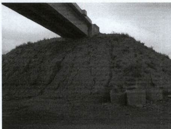
Foto 34. Saia de aterro com erosões.
