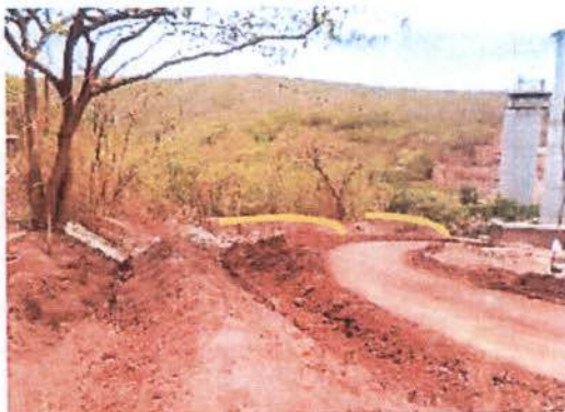
Construção canaletas e 02 bacias de infiltração e contenção (lado esquerdo) no viaduto Brejinho I. Data: 30/10/2013.
