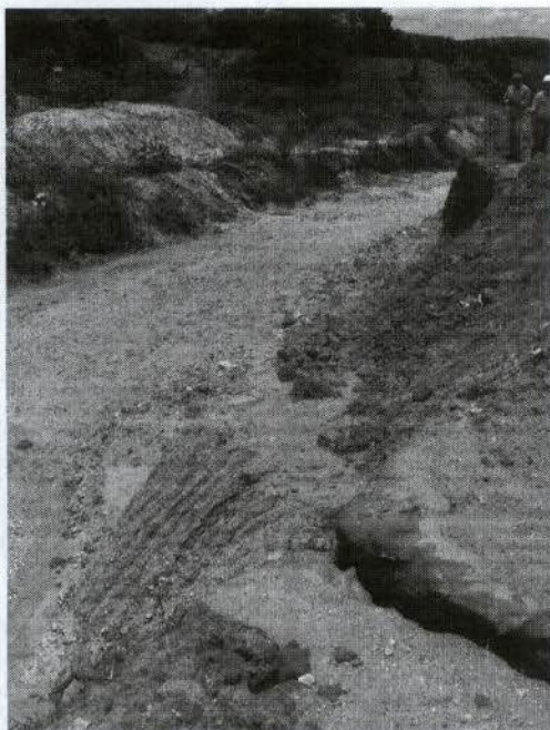
Foto 22. Erosão em corte e ausência de contenção de sedimentos.
