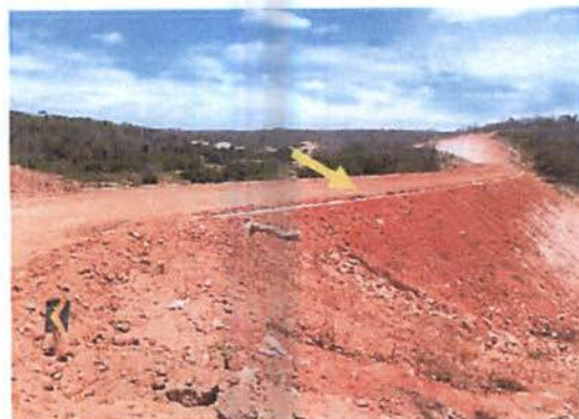
Km 982+440 - Correção da erosão e construção da drenagem definitiva no local (indicada pela seta amarela). Data: 07/11/2013.
