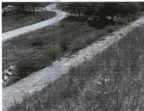
Foto 45. Erosão na banqueta.
