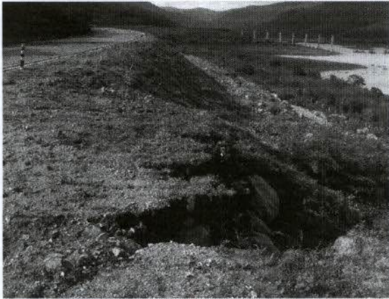
Foto 88. ura 13. Erosão em alargamento de aterro.
