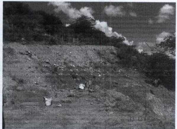
Figura 102. Aterro sujeito a erosões.
