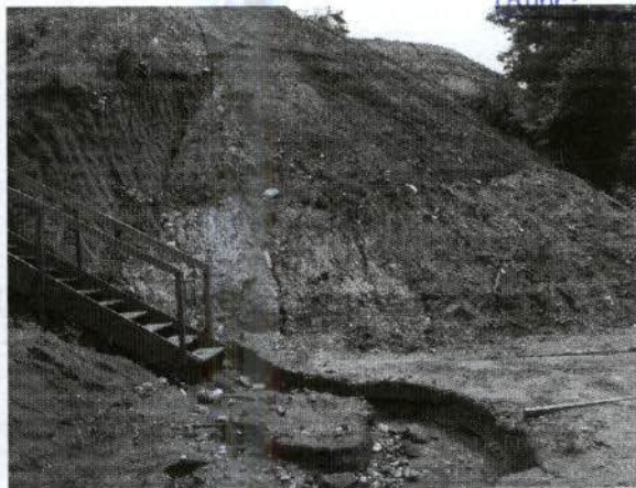
Foto 15. Aterro com erosões e ausência do sistema de drenagem definitivo.
