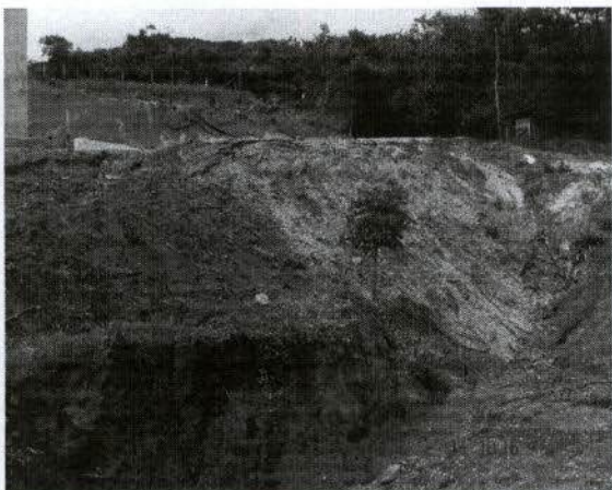
Foto 13. Aterro com erosões e ausência do sistema de drenagem definitivo.
