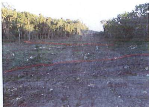
Bacias de contenção implantadas próximas da área alagada do km 1439+300.
