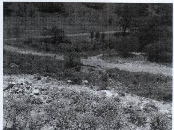
Foto 99. Erosão no acesso ao bueiro.
