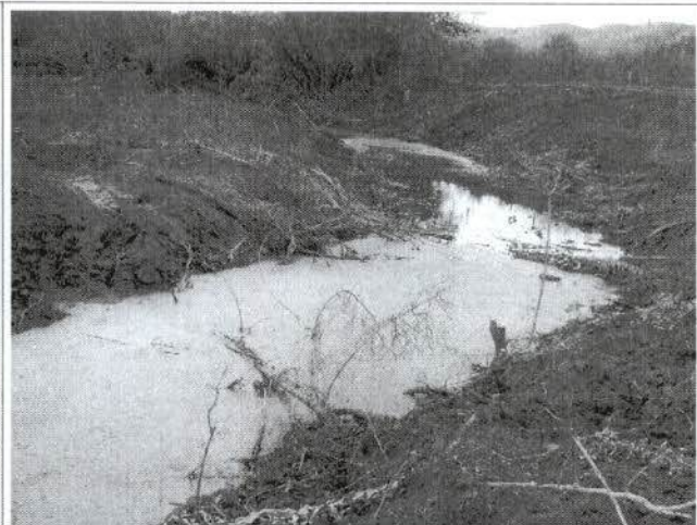
Intervenção de corpo hídrico, na altura do Km 1.306, sem sistemas provisórios de contenção de sedimentos suficientes. Parte do material resultante da supressão foi direcionado ao corpo hídrico.
