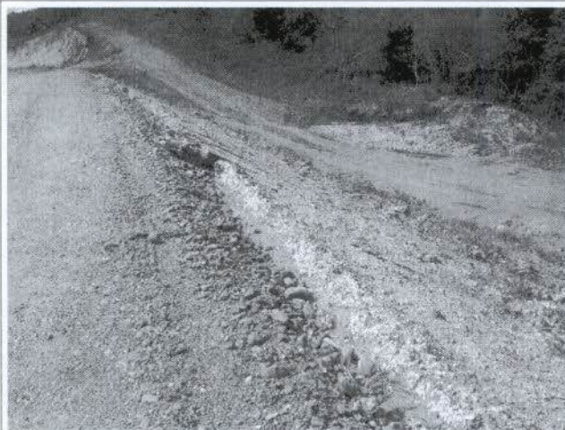
Hidrossemeadura não eficaz em aterro.
