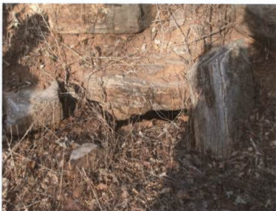
Foto 3. Provável sumidouro que permite o cavernamento no maciço.
