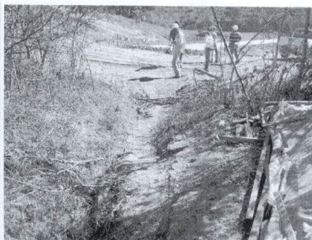
Figura 10: Vista do córrego de montante para jusante mostrando a obstrução do córrego
