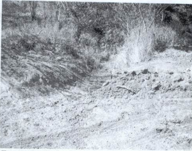
Figura 14: Vista de montante para jusante do córrego do brejinho 1, onde foi realizada a intervenção na calha do rio sem outorga.
