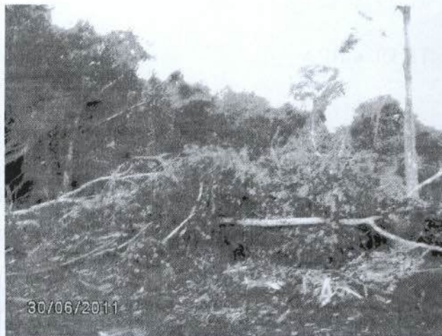
Figura 82: Vegetação de grande porte empurrada para lateral da faixa de domínio, sobre a vegetação viva, em desacordo com a metodologia aprovada no PBA
