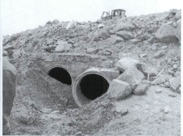
Figura 55: Galerias pluviais obstruídas, mesmo após estarem praticamente prontas
