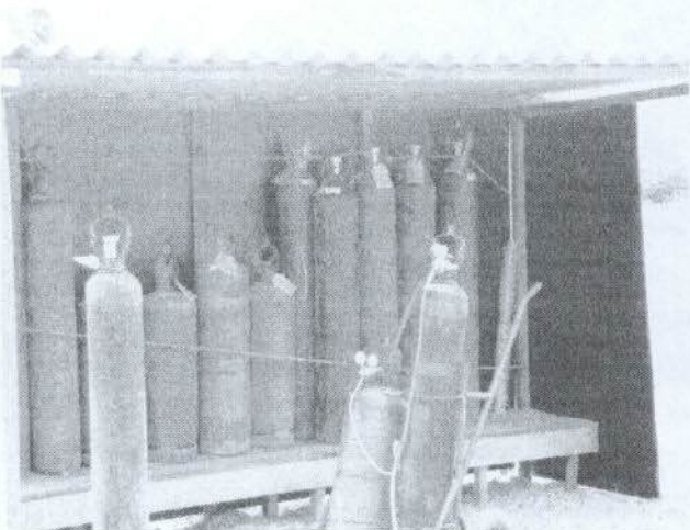
Figura 64: Estoque de acetileno, totalmente exposto sem nenhuma medida de segurança aplicável
