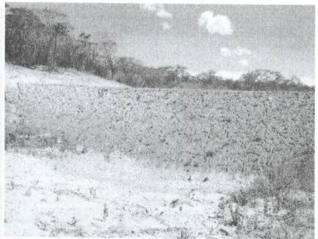
Figura 20: Barragem próxima a local onde haverá uma PN da ferrovia. Na área destacada pode-se notar que já houve afloramento de água no local
