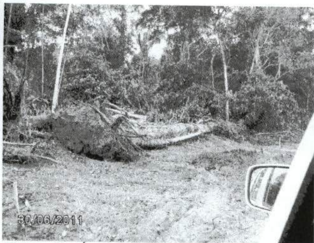
Figura 84: Árvore de grande porte, empurrada com trator de esteira, totalmente em desacordo com a metodologia, que previa utilização de corte por moto-serra, visando a preservação para utilização do material lenhoso
