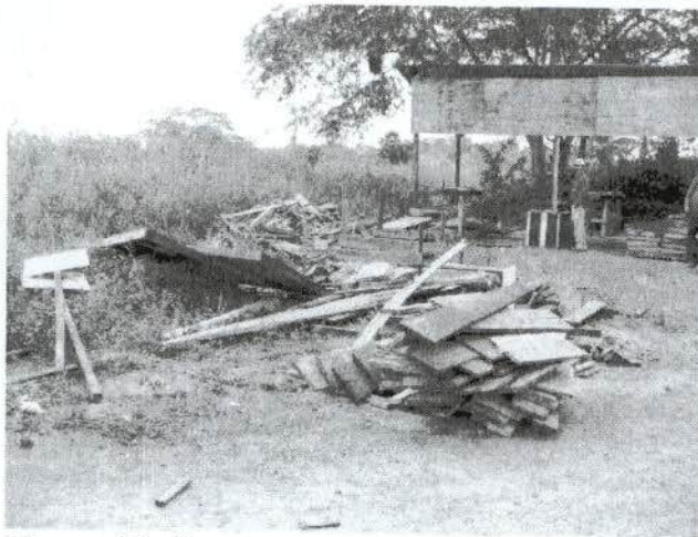
Figura 92: Pequena central de concreto construída na faixa de domínio, resíduos dispostos de maneira inadequada.
