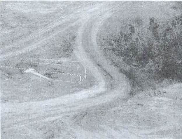
Figura 56: Galeria pluvial totalmente obstruída, mesmo após conclusão da galeria e do aterro, permitindo a passagem de veículo por outro caminho.
