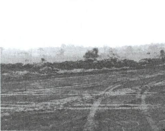
Figura 79: Início do trecho de obras, solo baste orgânico o qual foi apenas parcialmente raspado, havendo a necessidade de se guardar a maior quantidade possível de solo
