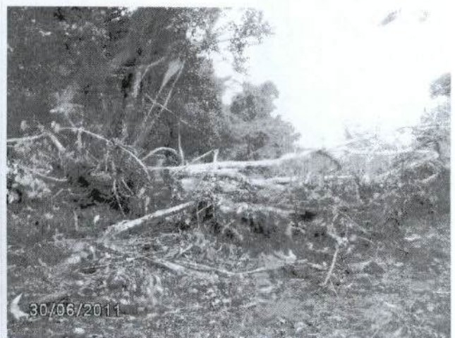
Figura 83: Vegetação empurrada para lateral da faixa de domínio, sobre a vegetação viva, em desacordo com a metodologia aprovada no PBA
