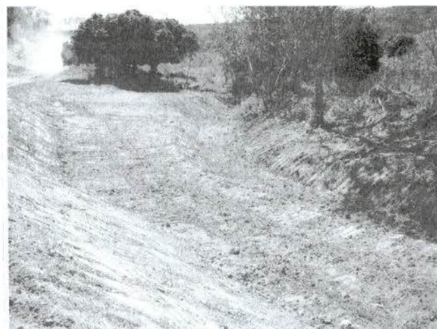
Figura 13: Vista de jusante para montante do córrego do brejinho 1, onde foi realizada intervenção na APP e na calha do rio, sem outorga.
