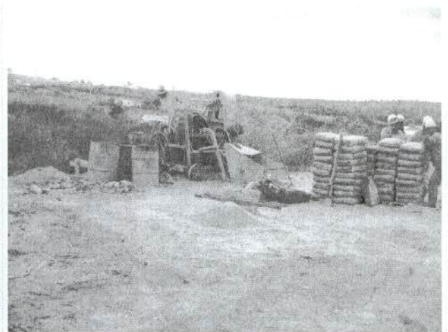
Figura 61: Pequena central de concreto, onde resíduos de concreto estão caindo diretamente sobre o solo
