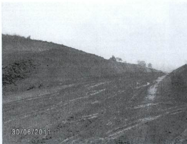
Figura 98: Taludes expostos, e apesar de já prontos, não há previsão para a revegetação e execução da drenagem superficial
