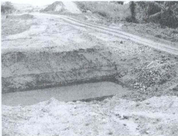
Figura 90: Córrego obstruído, sem o cuidado de se deixar uma drenagem de serviço para permitir o fluxo da água.
