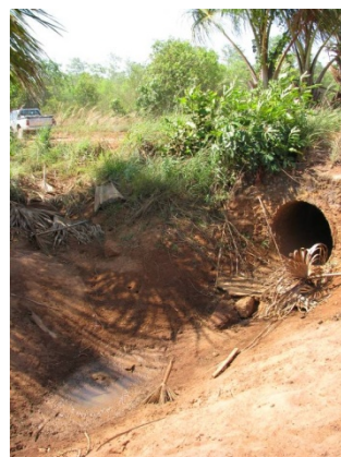
Jusante do ponto 3.
