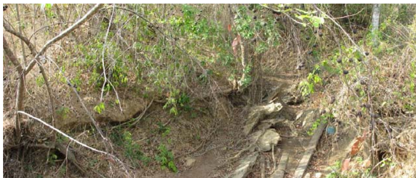
Jusante do ponto 64
