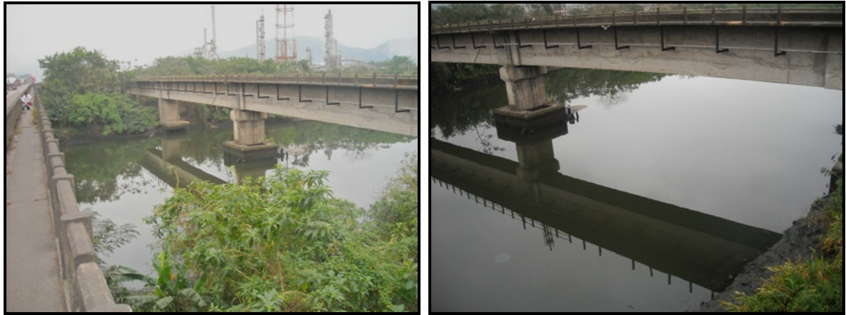
Figura 97 – Vegetação da APP e aspecto da água do Rio Cubatão, Município de Cubatão.
