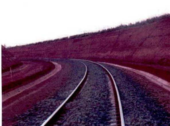
FIGURA 29 – Estaca 8231: canaleta de drenagem próxima à linha. Será implantada “canaleta” de laterita na base do corte.
