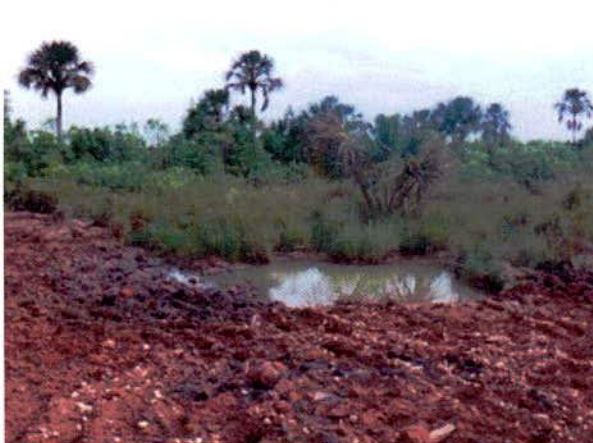
FIGURA 41 – Ponte sobre o Córrego Confusão: solo espalhado inadequadamente em APP. Notar interrupção do fluxo de água e elevação em relação ao terreno original.
