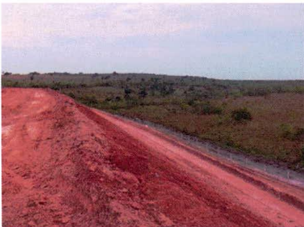
FIGURA 147 – Estacas 12.030 – 12.067: aterro de grandes dimensões em execução, sem início da hidrossemeadura – lado direito.
