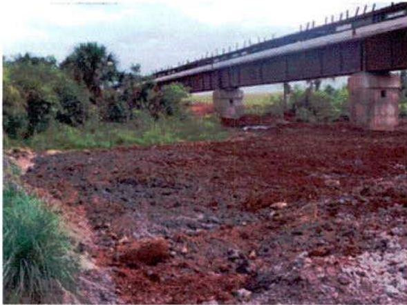
FIGURA 43 – Solo espalhado inadequadamente na APP do Córrego Confusão. Notar elevação em relação ao terreno original.
