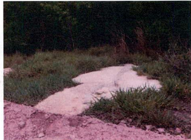
FIGURA 94 – Restos de concreto não removidos.
