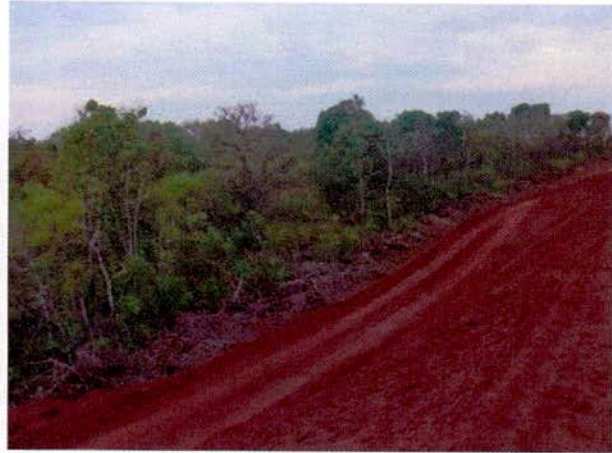
FIGURA 98 – Aterro nas proximidades da estaca 10.174: restos de vegetação não removidos e revolvidos junto à camada orgânica de solo – lado direito da linha.
