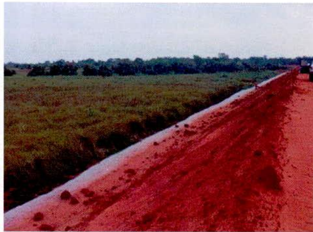
FIGURA 76 – Estaca 9918: aterro em várzea com aplicação de manta de “bidim” na base – lado esquerdo.
