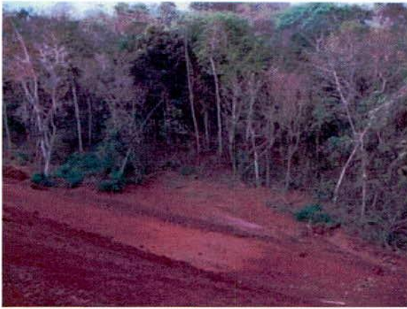
FIGURA 31 – Estaca 8686: aterro sem revegetação.
