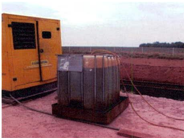
FIGURA 95 – Gerador e tanque de combustível (com bandeja) ao lado da área de implantação da Ponte sobre o Ribeirão Ponte de Pedra I.
