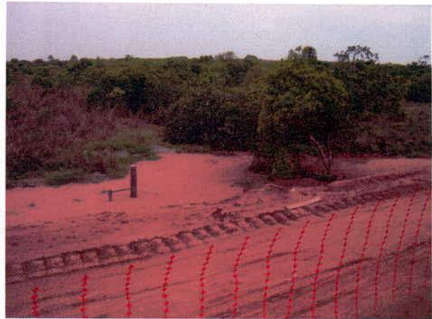
FIGURA 122 – Solo oriundo do aterro da ferrovia carregado para fora da faixa de domínio nas proximidades da Ponte sobre o Ribeirão Ponte de Pedra II – lado esquerdo.
