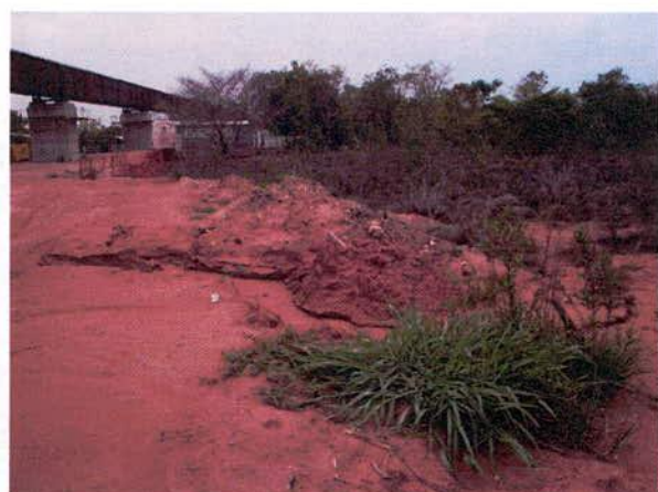
FIGURA 130 – Solo oriundo do aterro da ferrovia carregado para fora da faixa de domínio nas proximidades da Ponte sobre o Ribeirão Ponte de Pedra II – lado direito.
