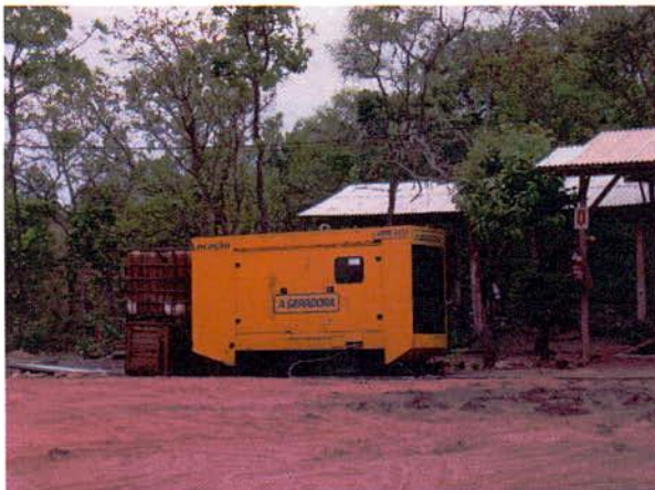
FIGURA 125 – Gerador e armazenamento inadequado de combustível (sem bandeja de contenção de vazamentos) na área de apoio.
