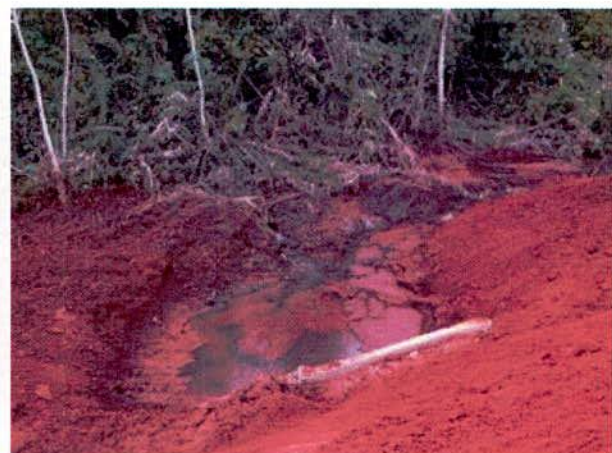
FIGURA 108 – Detalhe da saída da galeria com assoreamento – lado esquerdo.
