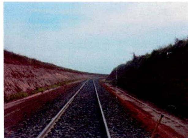
FIGURA 06 – Estaca 6100: talude de corte com revegetação mal sucedida.
