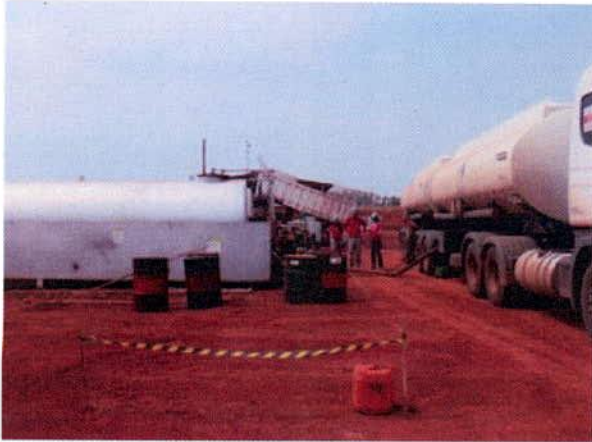
FIGURA 179 – Canteiro Contern: abastecimento dos tanques de combustível e armazenamento de tambores com óleo usado (graxa) diretamente sobre o solo.
