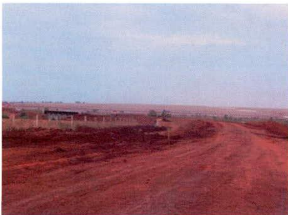
FIGURA 47 – Ponte sobre o Córrego Cachoeira ao fundo. Aterros sem revegetação.
