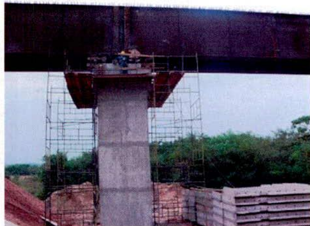
FIGURA 118 – Detalhe da utilização de dormentes de madeira para ancorar a estrutura metálica da ponte durante a soldagem.
