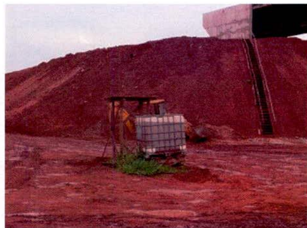
FIGURA 60 – Acondicionamento inadequado (sem bandeja para contenção de vazamentos) de combustível no “canteiro de obras” da Ponte sobre o Córrego Cachoeira.
