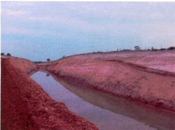
FIGURA 145 – Estaca 12.003: grande acúmulo de água em corte (verificar solução).
