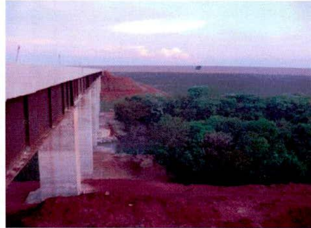
FIGURA 28 – Revegetação não finalizada nos encontros 1 e 2 da Ponte sobre o Rio Itiquira - lado esquerdo ferrovia (sentido crescente do estaqueamento).
