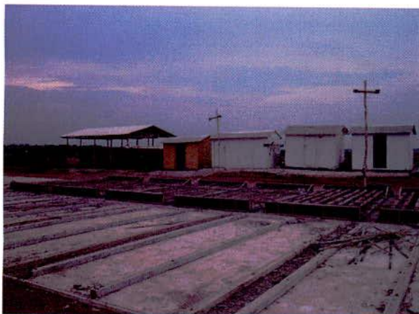
FIGURA 131 – Canteiro de pré-moldados de concreto instalado entre as Pontes sobre o Ribeirão Ponte de Pedra II e III.
