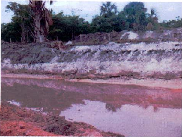
FIGURA 143 – Estaca 11.970: corte minando água e “solo mole” disposto em área de terceiro (ao fundo da figura).
