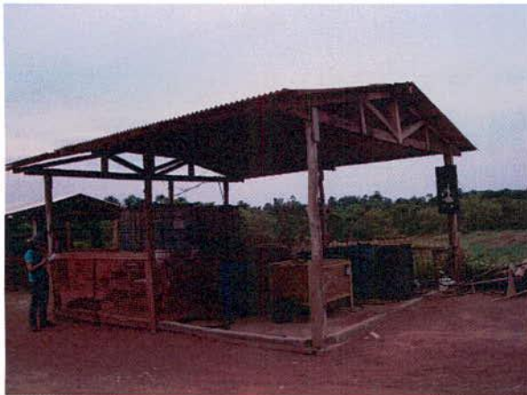
FIGURA 139 – Acondicionamento de combustível sob estrutura coberta, com solo impermeabilizado e canaletas de contenção de vazamentos.
