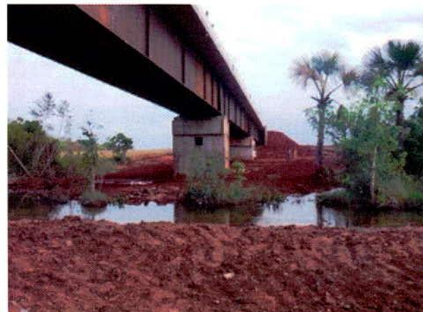
FIGURA 42 – Córrego Confusão sob a ponte ferroviária. Notar elevação em relação ao terreno original devido à disposição de solo em APP.
