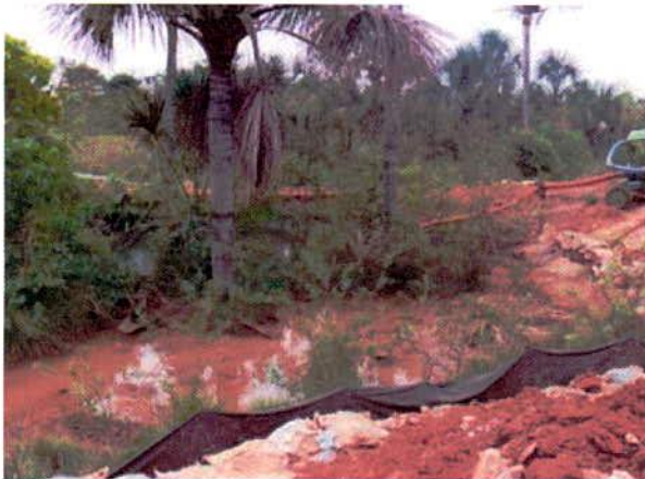
FIGURA 63 – Manta de “bidim” insuficiente para a contenção do assoreamento do curso d’água.
