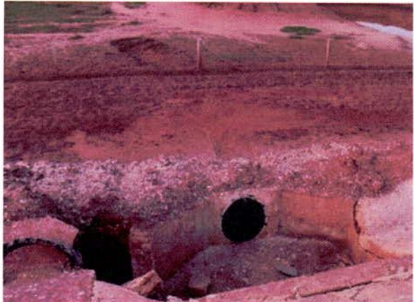
FIGURA 13 – Outra drenagem comprometida no aterro da estaca 6863 – lado direito.
