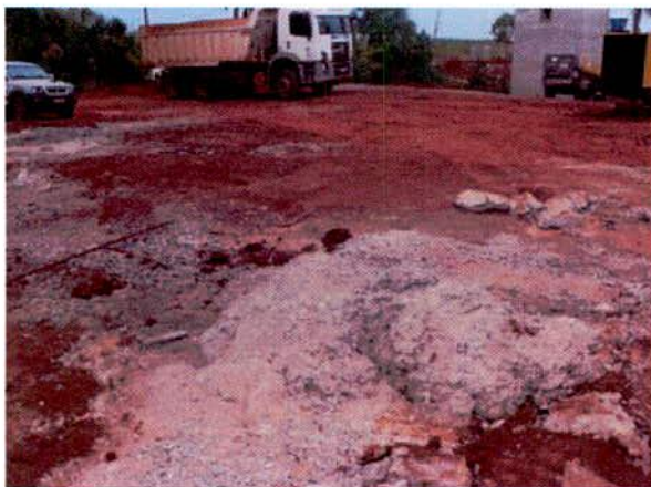
FIGURA 59 – Restos de concreto não removidos.
