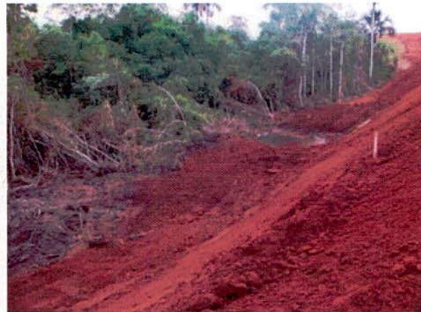
FIGURA 106 – Saída de galeria no aterro nas proximidades da estaca 10.283: situação semelhante ao aterro anterior.
