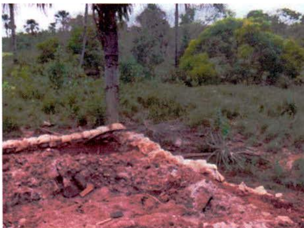
FIGURA 65 – Sacaria insuficiente para a contenção do assoreamento do curso d’água.
