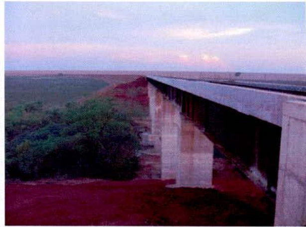
FIGURA 26 – Ponte sobre o Rio Itiquira – lado direito ferrovia (sentido crescente do estaqueamento). Revegetação não finalizada.
