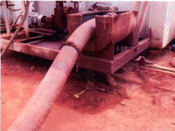
FIGURA 181 – Detalhe do abastecimento inadequado, com vazamento e consequente contaminação do solo.
