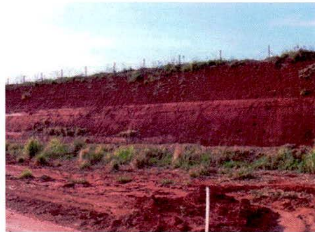
FIGURA 04 – Estaca 6000: talude de corte com revegetação mal sucedida.
