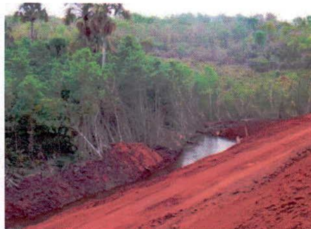
FIGURA 100 – Galeria nas proximidades da estaca 10.176: intervenção em APP, sem remoção dos restos de vegetação (revolvidos junto à camada orgânica de solo) – l. e..
