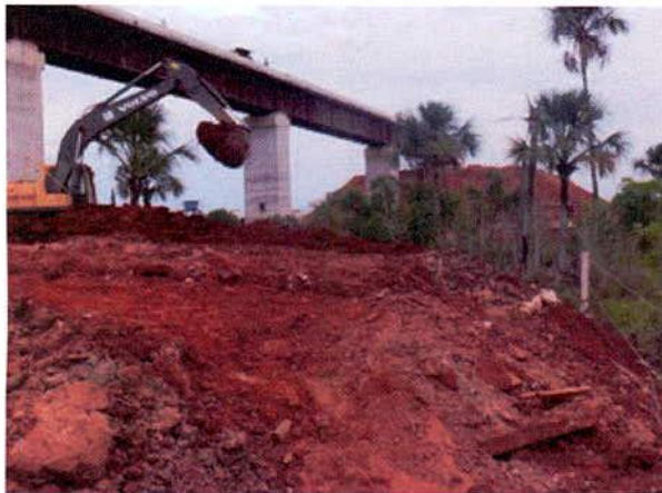
FIGURA 51 – Máquina retirando solo oriundo das escavações para implantação dos pilares que foi espalhado inadequadamente em APP – lado direito.
