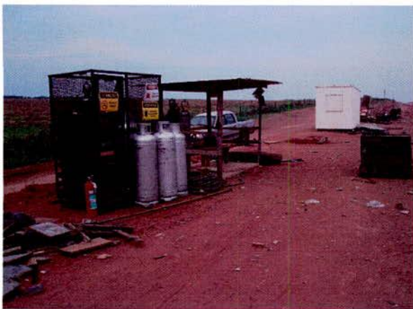
FIGURA 119 – Tanques de acetileno e oxigênio na área de apoio para a implantação da Ponte sobre o Ribeirão Ponte de Pedra II.
