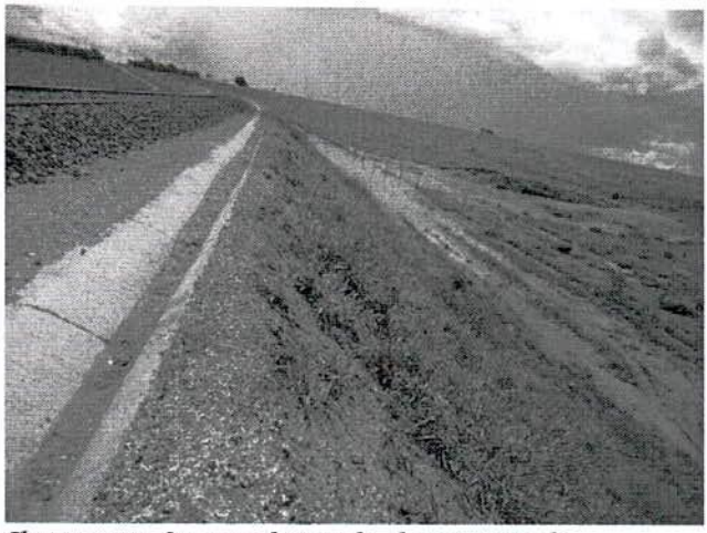
Ilustração 2: canaletas de drenagem de concreto.
