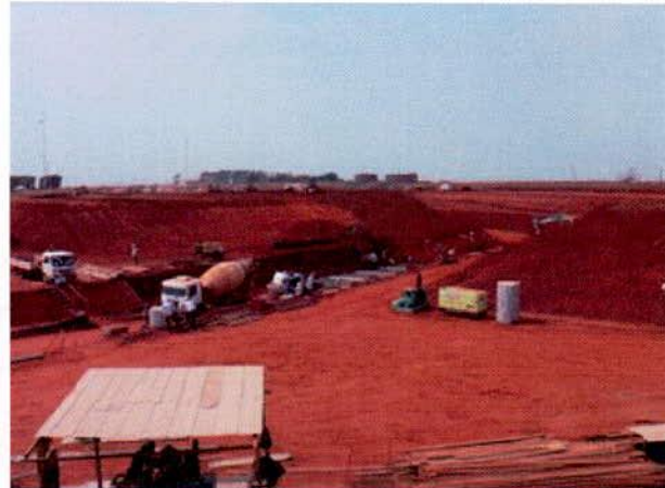
FIGURA 170 – Obras de execução do acesso rodoviário ao terminal, em desnível em relação à pera ferroviária (será implantada em viaduto neste ponto).
