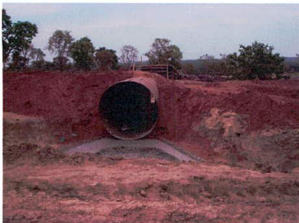
FIGURA 141 – PF em implantação na estaca 11.578. Falta remoção do solo excedente, reconformação e revegetação.
