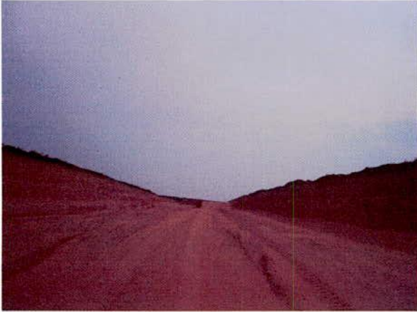
FIGURA 115 – Corte entre as estacas 11.030 – 11.065: solo arenoso, ALL irá elaborar procedimento específico para a revegetação dos taludes nesse trecho.
