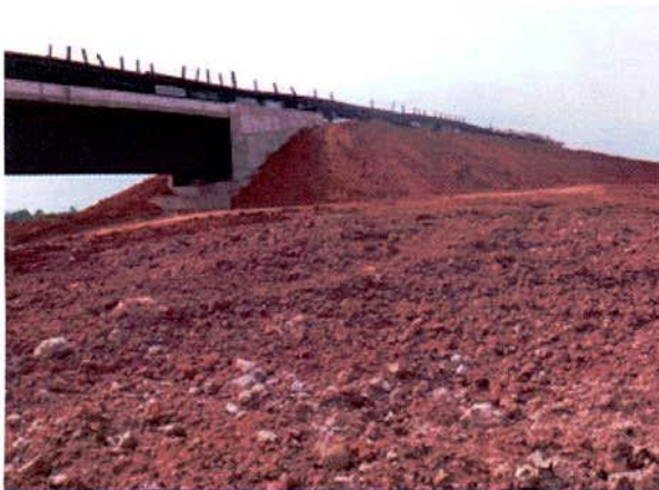
FIGURA 39 – Aterro do encontro 1 da Ponte sobre o Córrego Confusão não finalizado e revegetado – lado esquerdo da linha.
