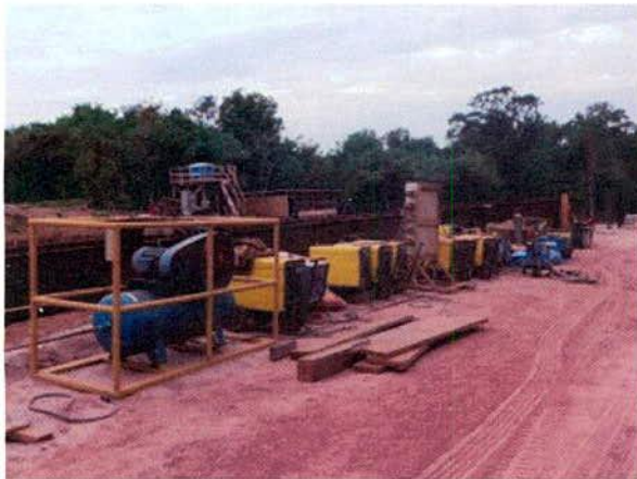
FIGURA 93 – Área de apoio para a implantação da Ponte sobre o Ribeirão Ponte de Pedra I – encontro 2.
