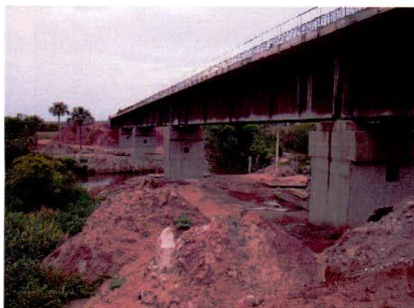
FIGURA 133 – Ponte sobre o Ribeirão Ponte de Pedra III (5 vãos) observada a partir do encontro 1 – lado esquerdo. Notar altura do solo “empilhado” à esquerda.
