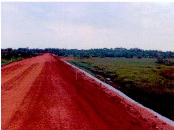
FIGURA 77 – Estaca 9920: aterro “cedeu”, deverá ser reconformado. Mata Ciliar do Ribeirão Ponte de Pedra ao fundo.
