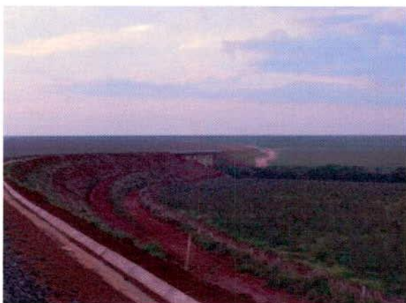
FIGURA 23 – Aterro de encabeçamento da Ponte sobre o Rio Itiquira. Revegetação não finalizada (ambos os lados).
