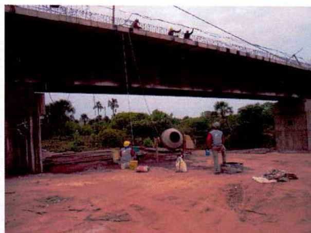
FIGURA 134 – Obras de implantação da Ponte sobre o Ribeirão Ponte de Pedra III observadas a partir do encontro 1 – lado direito.
