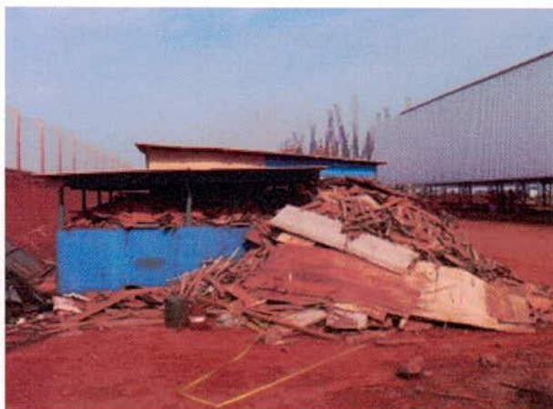
FIGURA 158 – Gestão de resíduos sólidos (madeira) inadequada na área de apoio à implantação das telhas.
