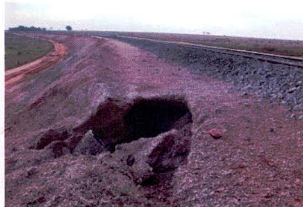
FIGURA 10 – Estaca 6863, lado esquerdo: sistemas de drenagem do aterro cederam, devendo ser refeitos.
