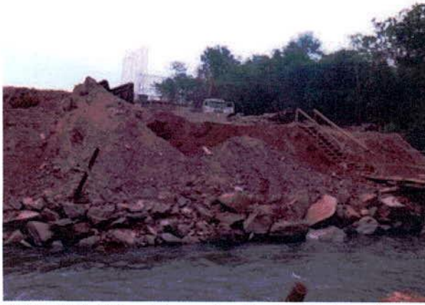
FIGURA 85 – Encontro 2 da Ponte sobre o Ribeirão Ponte de Pedra I, junto à calha natural do curso d'água. Deverá ser garantida passagem de fauna entre o encontro 2 e o rio.
