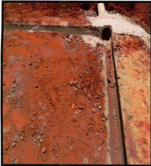
Canaletas direcionadas ao SAO
