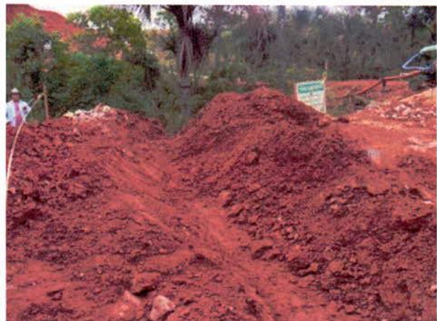
FIGURA 64 – Pilha de solo oriundo das escavações para implantação dos pilares espalhado inadequadamente em APP – lado direito – encontro 1.
