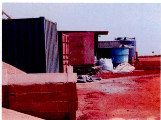
FIGURA 178 – Canteiro Contern: usina de concreto.
