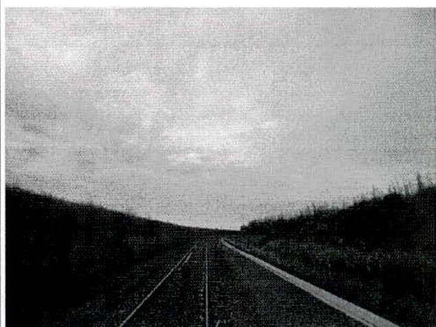
Ilustração 10: corte com a vegetação necessitando de reforço da hidrosseadura.
