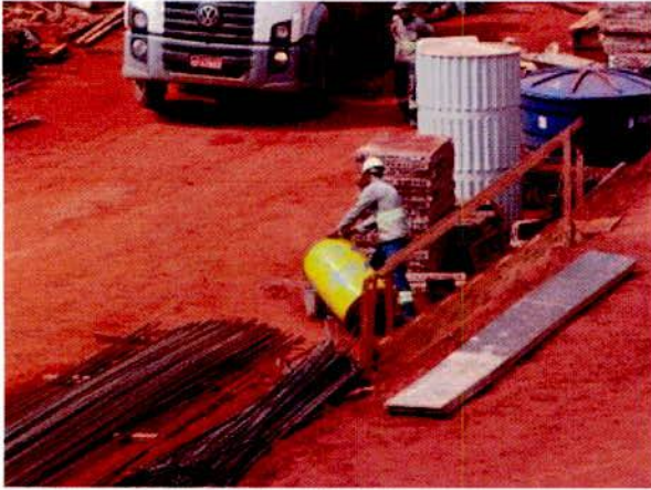
FIGURA 173 – Utilização de aditivo para concreto sem utilização de luvas pelo funcionário e com vazamento do produto no solo.
