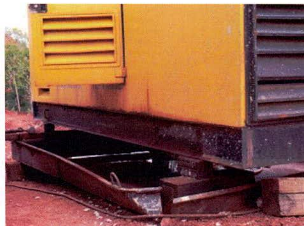
FIGURA 54 – Gerador próximo à margem do Córrego Cachoeira. Bandeja de contenção de vazamentos rompida.
