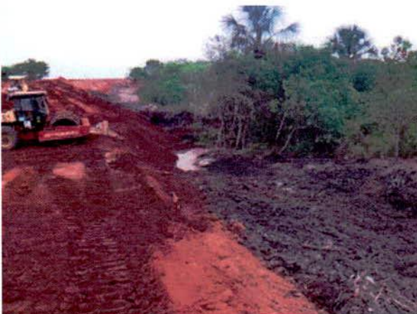
FIGURA 113 – Implantação de galeria na estaca 10.590: assoreamento do curso d'água e restos de vegetação misturados à camada orgânica do solo.
