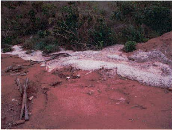
FIGURA 137 – Restos de concreto não removidos na área de implantação da Ponte sobre o Ribeirão Ponte de Pedra III.
