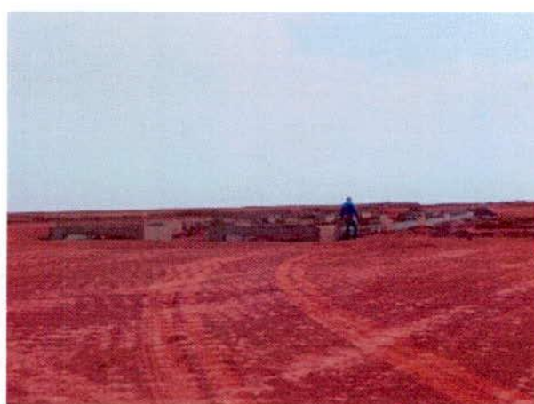
FIGURA 166 – Implantação das 2 “balanças de pesagem de entrada” no lote da ALL no terminal.
