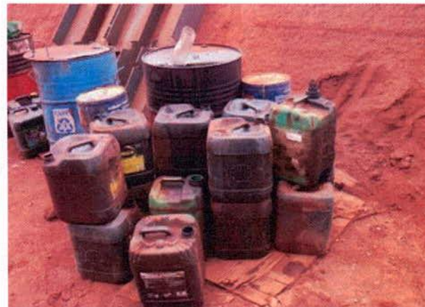
FIGURA 184 – Galões de produtos diversos (marca Shell, provavelmente derivados de petróleo) dispostos inadequadamente.
