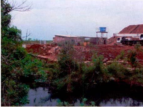
FIGURA 55 – Sacaria disposta para evitar processo erosivo e assoreamento – encontro 2. Notar barracão em APP (ao fundo).
