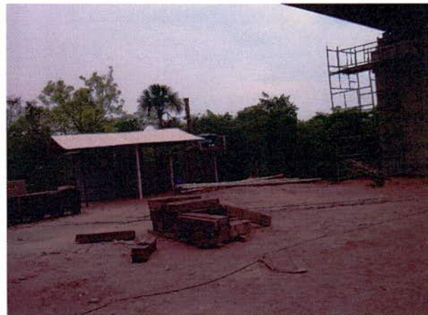
FIGURA 126 – Sanitários químicos e caixa d'água (sob estrutura de madeira) na APP do Ribeirão Ponte de Pedra.
