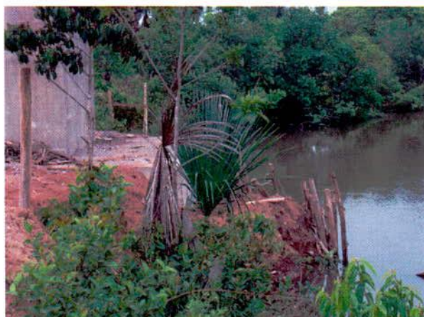
FIGURA 135 – Escoras de madeira entre o aterro e o curso d'água. ALL deverá avaliar retirada das escoras.
