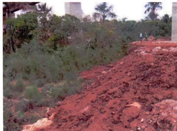
FIGURA 66 – Pilha de solo: elevação em relação ao terreno natural e carreamento para a APP.
