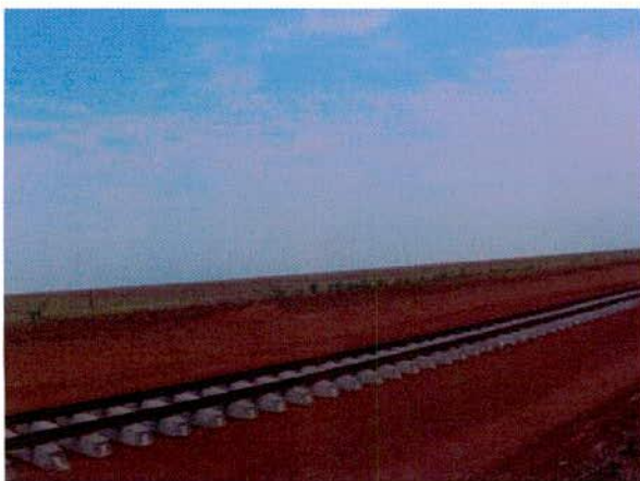
FIGURA 35 – Corte pequeno recém executado e não revegetado – estaca 109.100.
