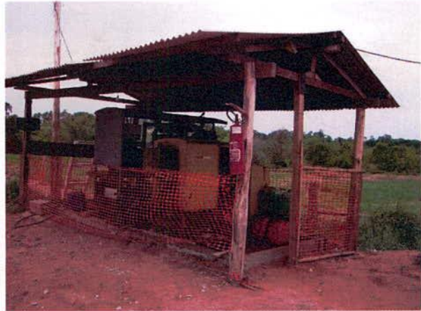
FIGURA 138 – Geradores sob estrutura coberta, com solo impermeabilizado e canaletas de contenção de vazamentos.
