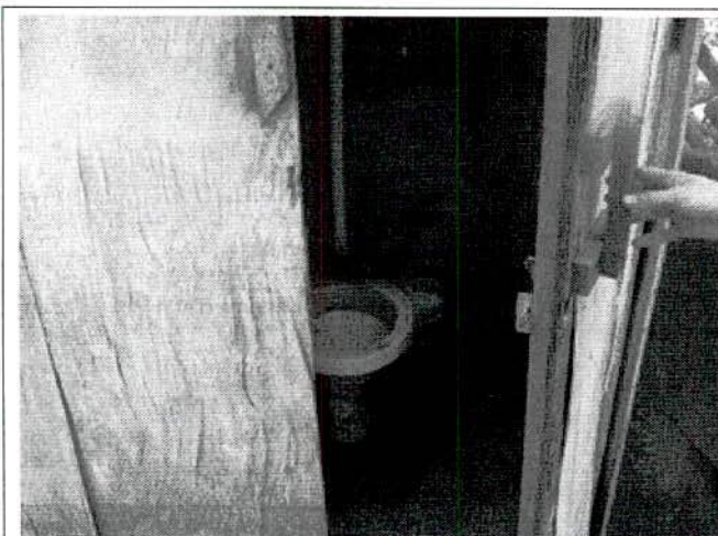
FIGURA 81 – Detalhe do sanitário irregularmente implantado ao lado da tulha (com fossa negra).
