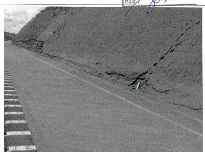
FIGURA 98 – Canaletas de drenagem obstruídas e talude não revegetado.
