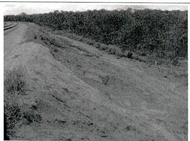
FIGURA 100 – Processo erosivo com interferência em área de terceiros no local de implantação de Passagem de Fauna – PF.
