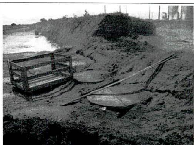
FIGURA 82 – Assoreamento das fossas sépticas implantadas para o tratamento dos efluentes gerados nos sanitários da tulha.
