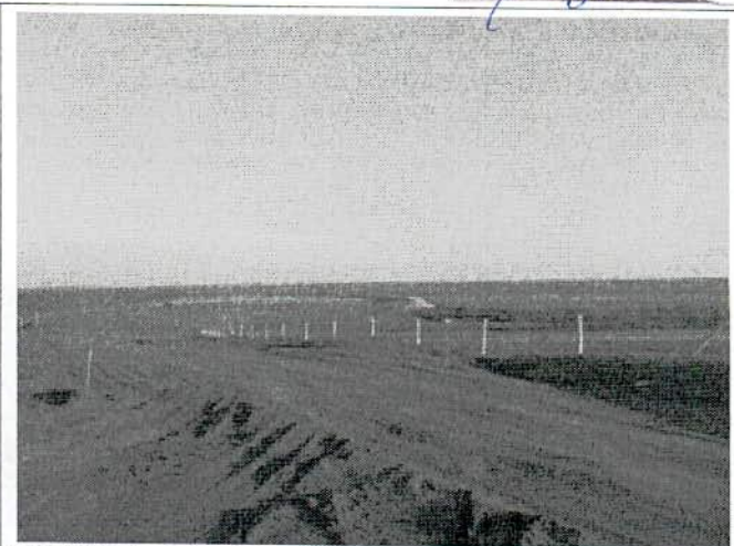
FIGURA 62 – Obras do Seg II na chegada à Ponte sobre o Rio Itiquira.
