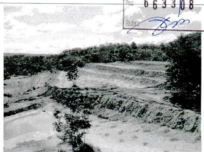
FIGURA 92 – Estaca 981, lado direito: área onde a ALL realizou recuperação de processo erosivo pré-existente.
