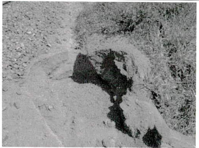
FIGURA 62 – Segmento I: processo erosivo já instaurado na plataforma ferroviária recém concluída – estaca 97 (lado direito no sentido crescente do estaqueamento).
