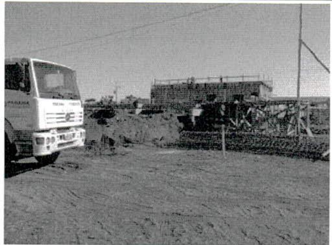
FIGURA 12 – Tombador de caminhões – nível inferior.
