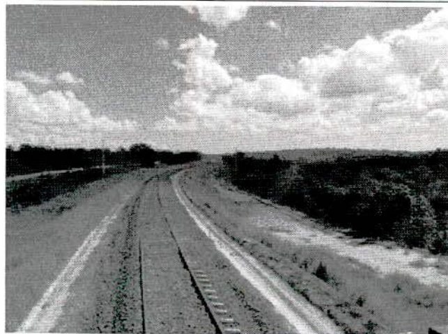
FIGURA 89 – Processo erosivo à direita da linha – estaca 755.
