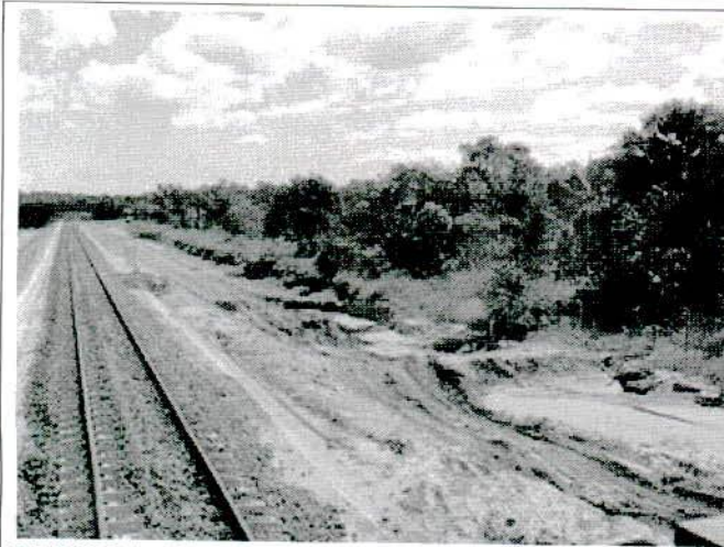
FIGURA 91 – Processo erosivo à direita da linha – estaca 961. ALL implantou “bacias de drenagem” para dissipar a energia.
