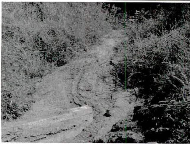
FIGURA 63 – Segmento I: processo erosivo já instaurado na estaca 98 (lado esquerdo no sentido crescente do estaqueamento).
