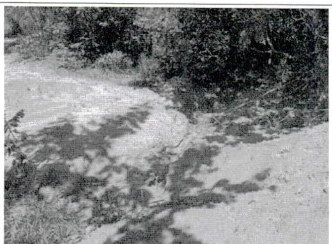
FIGURA 70 – Segmento I: processo erosivo na estaca 128. Neste ponto será instalado dissipador de energia.
