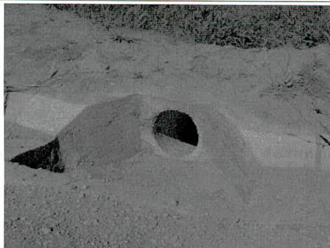
FIGURA 35 – Bueiro de 50cm de diâmetro, para escoamento das canaletas de drenagem da plataforma.
