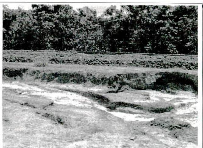
FIGURA 76 – Segmento I: processo erosivo no Pátio de Carregamento da fábrica de dormentes – estaca 158.
