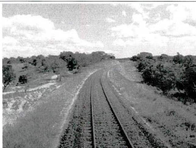
FIGURA 87 – Estaca 685: processo erosivo à esquerda já reconformado, faltando revegetação.
