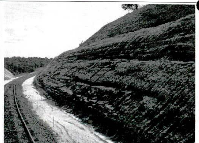
FIGURA 90 – Ravinamento de talude na estaca 920.
