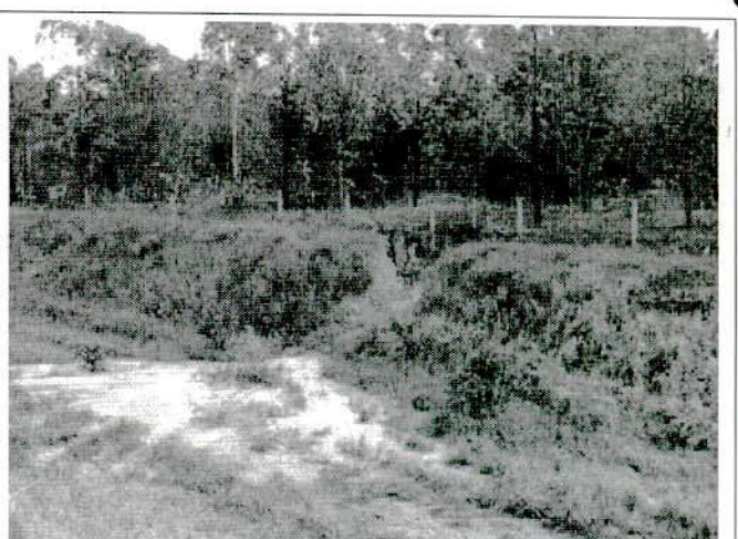
FIGURA 78 – Segmento I: processo erosivo à direita da linha – estaca 272.
