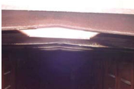
Acúmulo de material nas travessas do teto.
