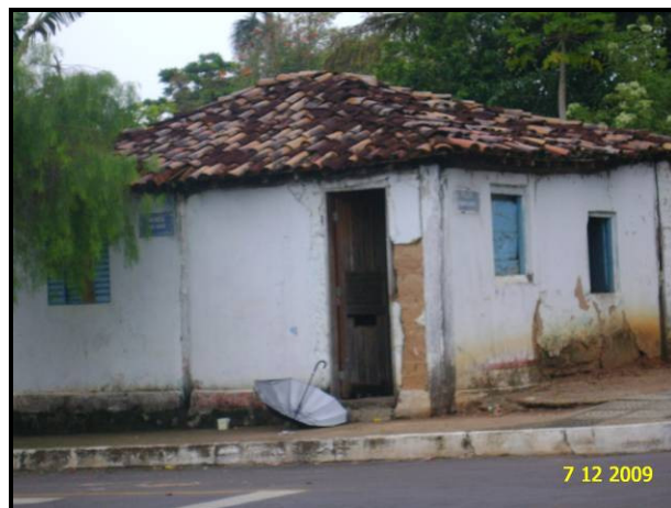
Figura 175 - Casa em condições precárias herdada do período da mineração no município.
