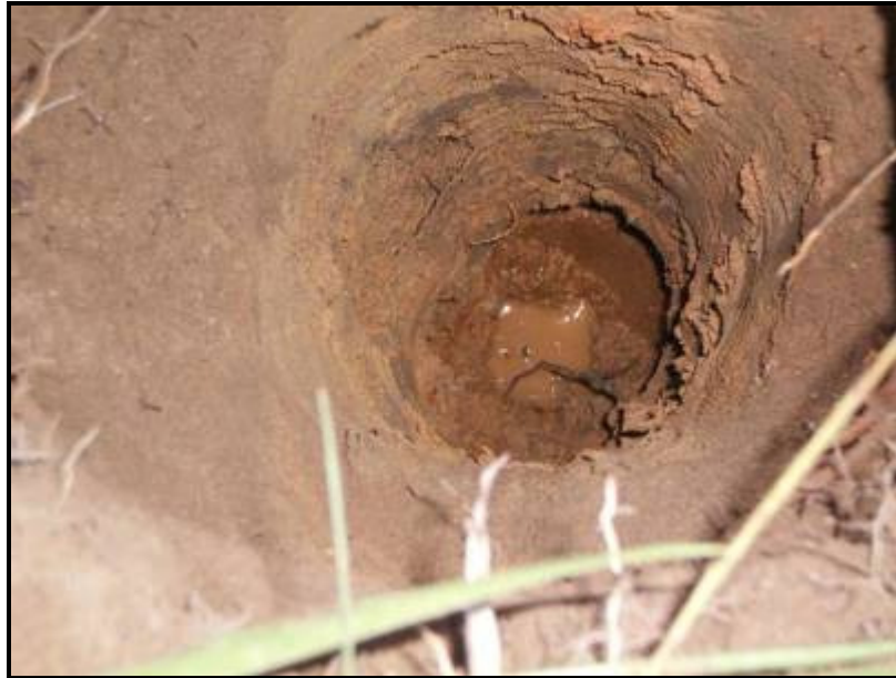
Figura 78 – Detalhe da sondagem ST-15, com visão da entrada de água.
