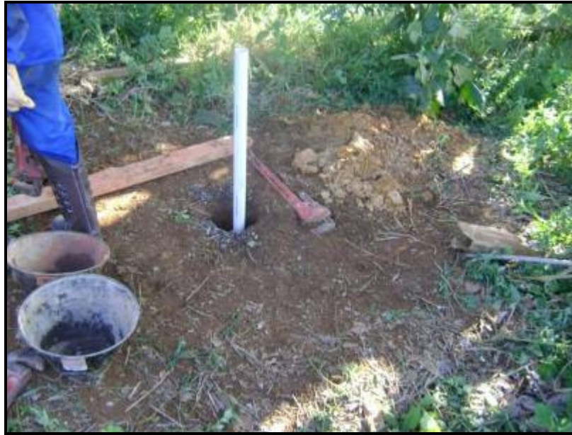
Figura 145 – Tubulação do poço PP-01.
