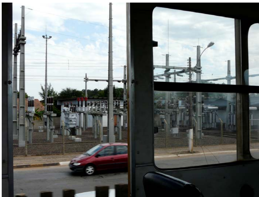
Figura 17.7-30 – Subestação Fátima de Energia Elétrica no Município de Canoas, Foto PC155
