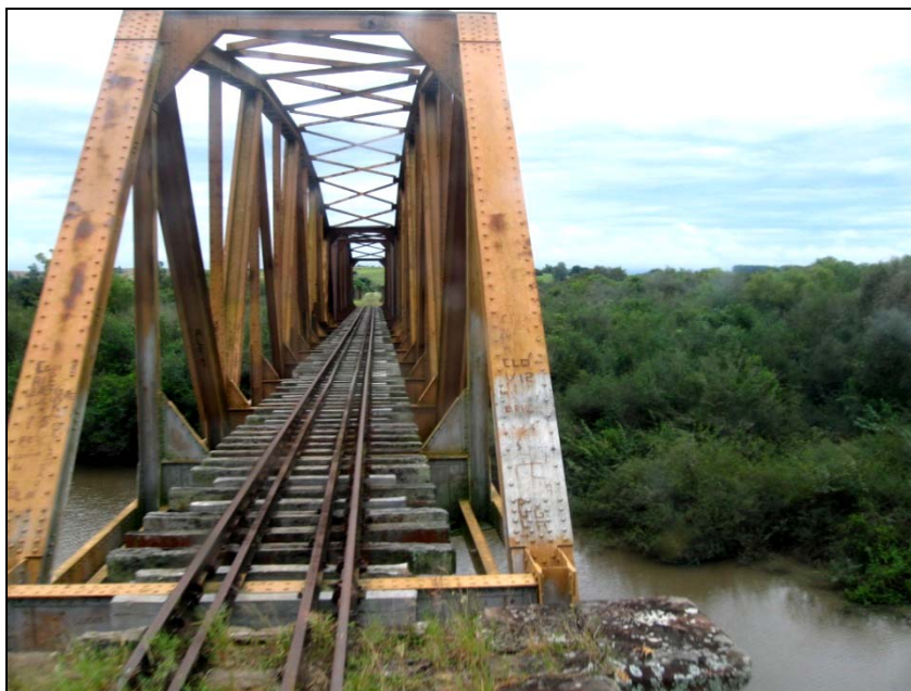
Figura 15.7-32 – Ponte com Proteção Lateral no Município de Dilermando de Aguiar, Foto OA178.
