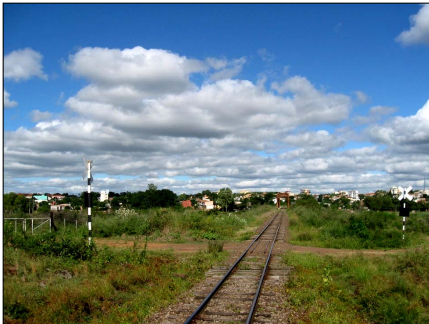
Figura 15.7-18– Passagem de Nível Próxima à Área Urbana do Município de Alegrete, com a Presença de Placas com Sistema de Controle em Bom Estado de Conservação, Foto PN502.
