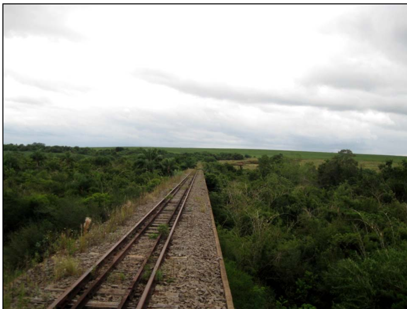
Figura 15.7-33 – Ponte sem Proteção Lateral no Município de São Luis Gonzaga, Foto OA228.
