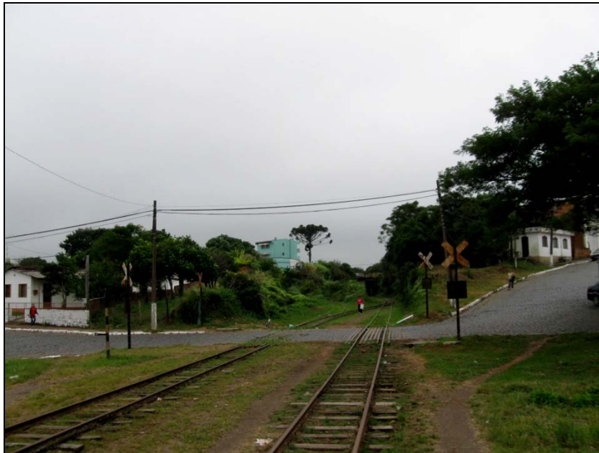
Figura 15.7-10 – Passagem de Nível em Área Urbana do Município de Santiago, com a Presença de Placas como Sistema de Controle em Estado de Conservação Ruim – Placas Enferrujadas, Foto PN419.
