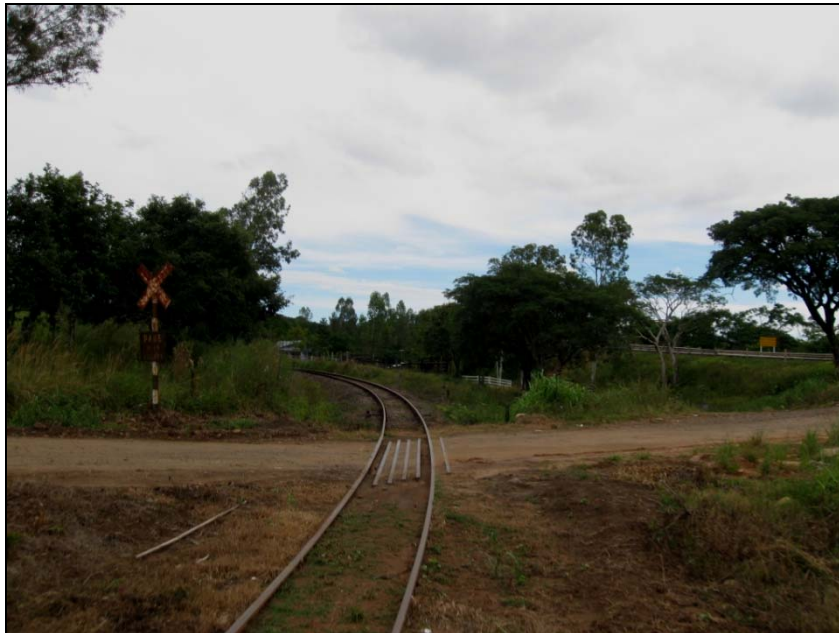
Figura 15.7-9 – Passagem de Nível em Área Rural do Município de Jaguari, com a Presença de Placas como Sistema de Controle em Estado de Conservação Ruim – Placa Enferrujada, Foto PN380.
