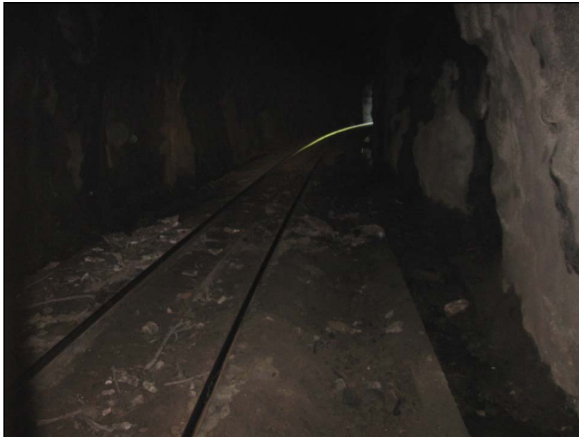
Figura 15.7-29 – Detalhe de Infiltrações no Interior do Túnel nº 7, no Município de Guaporé, Foto OA100.
