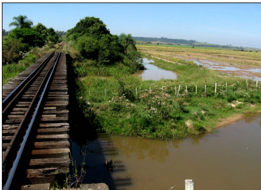
Figura 15.7-40 – Ponte sem Proteção Lateral no Município de Cachoeira do Sul, Foto OA420.
