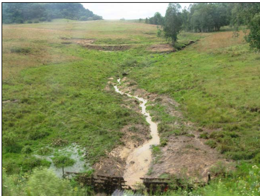
Figura 8.7-24 – Sistema de Drenagem (Galeria) em Estado Ruim de Conservação (Curso D'água com Erosão), Município de São Pedro do Sul, Foto SD2543
