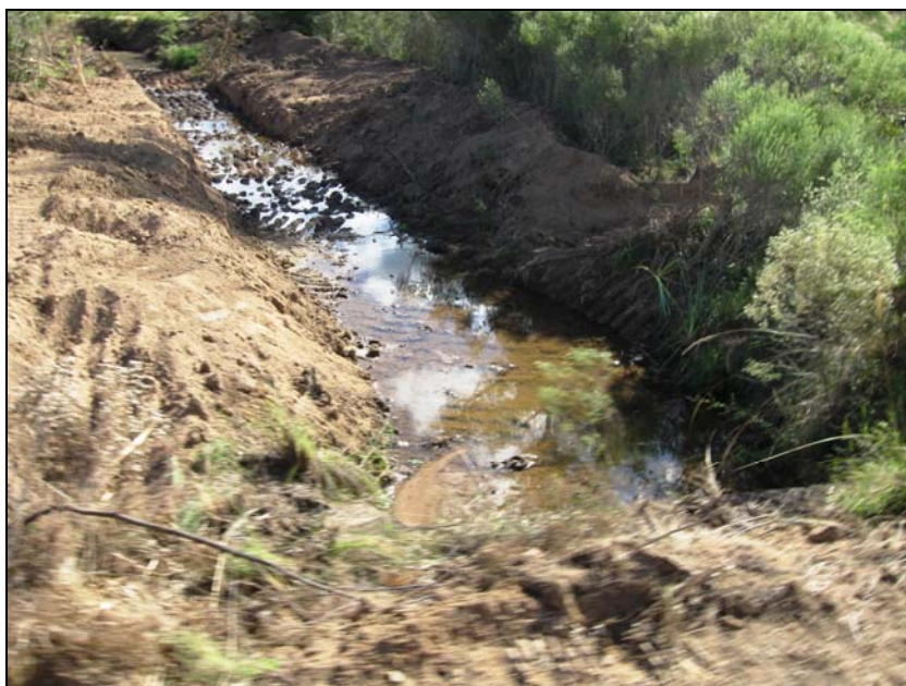
Figura 8.7-32 – Sistema de Drenagem (Galeria) em Estado Médio de Conservação (Assoreado), Município de São Gabriel, Foto SD3775
