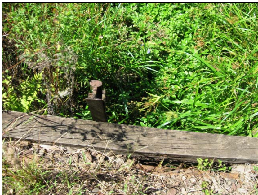
Figura 8.7-38 – Sistema de Drenagem (Galeria) em Estado Médio de Conservação (Falta Limpeza), Município de Restinga Seca, Foto SD4190
