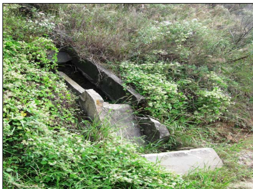
Figura 8.7-33 – Sistema de Drenagem (Escada Vertical) em Estado Ruim de Conservação (Quebrado), Município de São Gabriel, Foto SD3729
