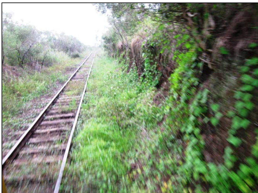
Figura 8.7-27 – Sistema de Drenagem (Canaletas Laterais) em Estado Ruim de Conservação (Ausentes ou Obstruídas), Município de Bossoroca, SD2867
