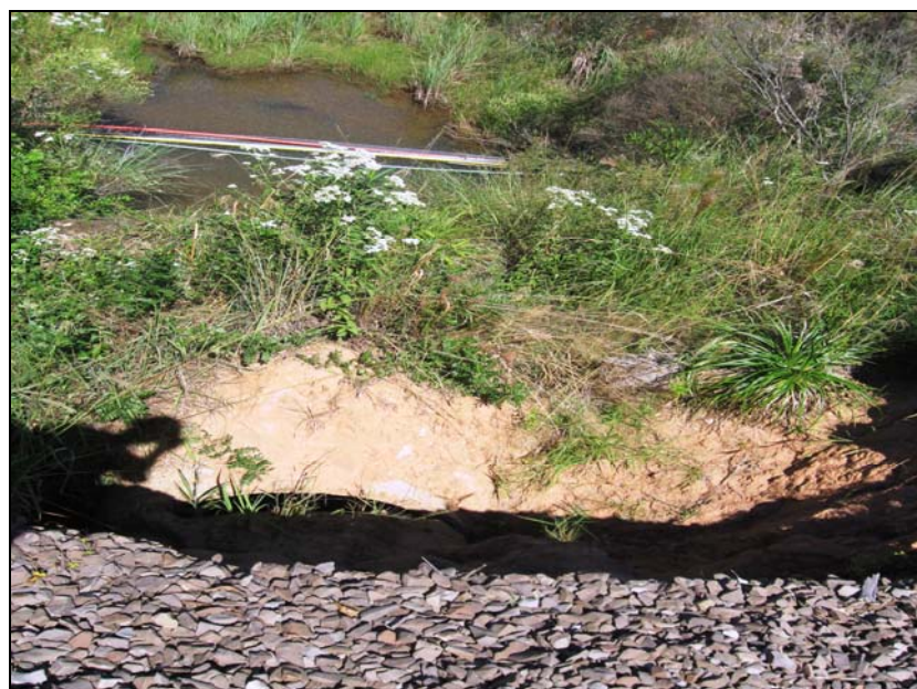
Figura 8.7-39 – Sistema de Drenagem (Galeria) em Estado Ruim de Conservação (Aterro com Erosão), Município de Cachoeira do Sul, Foto SD4249
