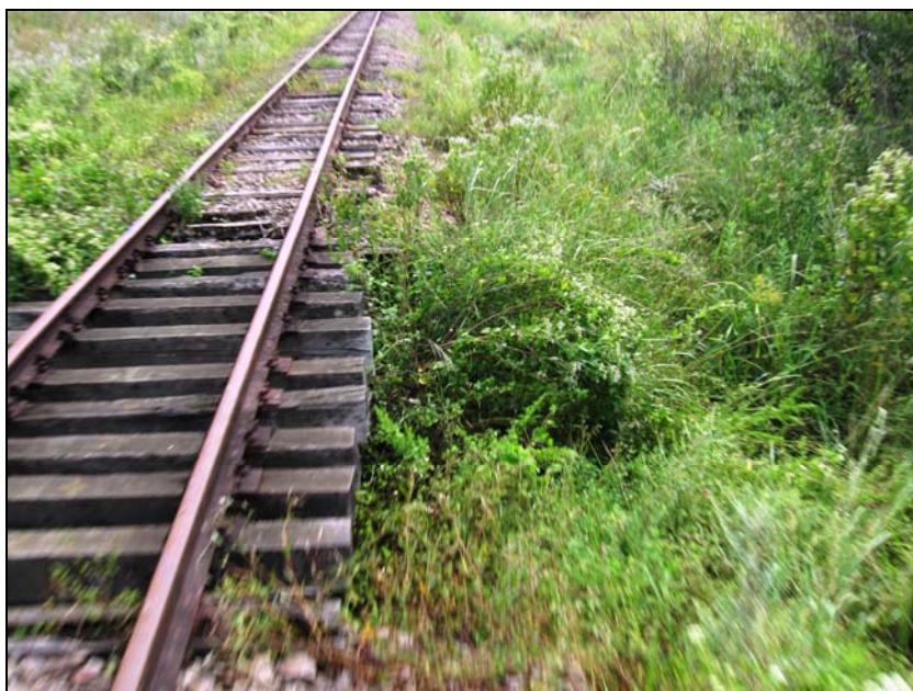
Figura 8.7-23 – Sistema de Drenagem (Ponte) em Estado Médio de Conservação (Falta de Limpeza), Município de Mata, Foto SD2591
