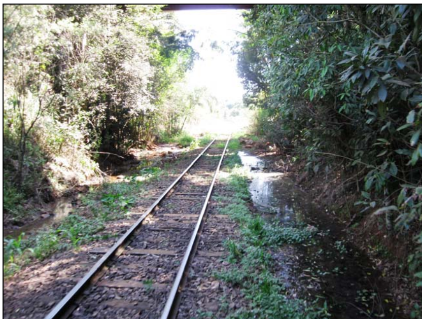
Figura 8.7-6 – Sistema de Drenagem (Canaletas Laterais) em Estado Ruim de Conservação (Ausentes ou Obstruídas), Município de Casca, Foto SD1819
