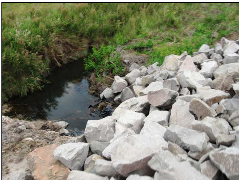
Figura 8.7-30 – Sistema de Drenagem (Galeria) em Estado Ruim de Conservação (Queda de Lastro), Município de Alegrete, Foto SD3406
