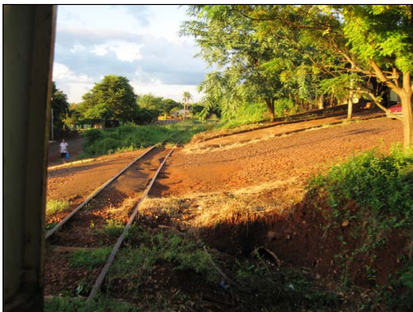
Figura 8.7-14 – Sistema de Drenagem (Tubo) Entupido Gerando Alagamento e Queda de Lastro, Município de Giruá, SD2196
