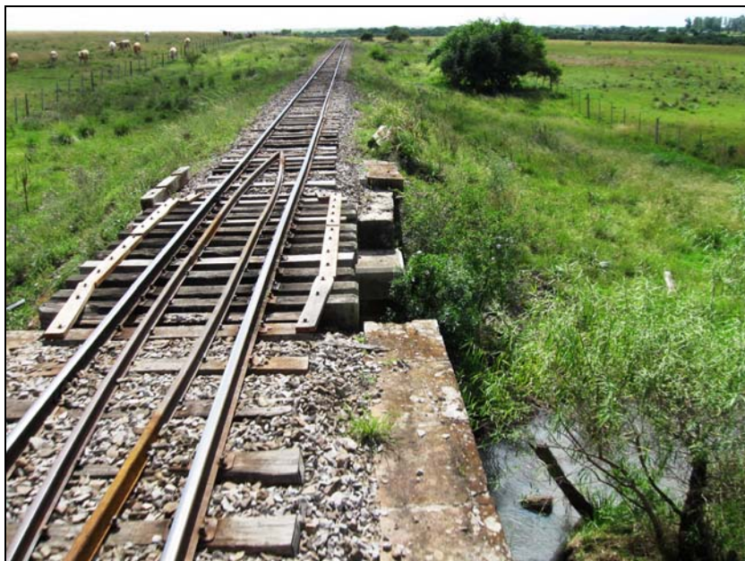
Figura 8.7-29 – Sistema de Drenagem (Galeria) em Estado Médio de Conservação (Curso D'água com Erosão), Município de Uruguaiiana, Foto SD3040
