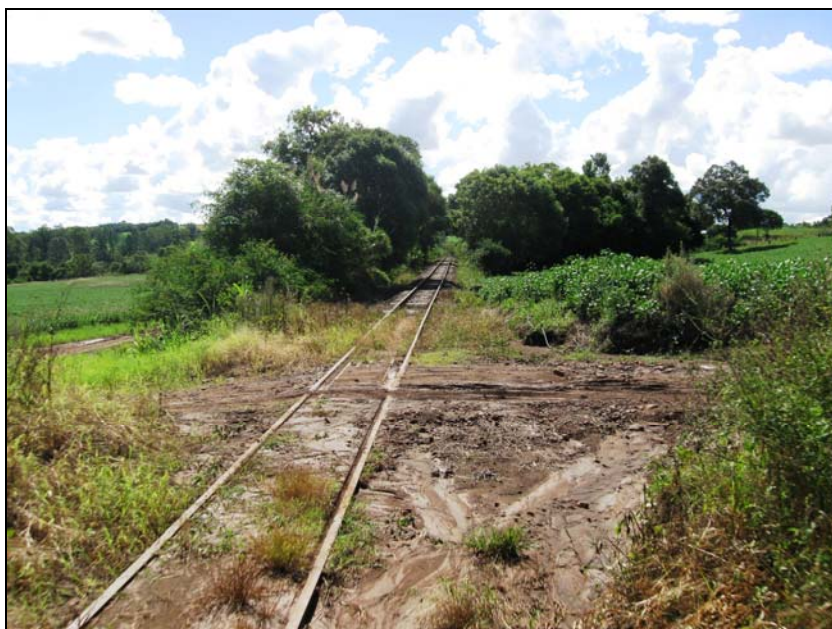
Figura 8.7-12 – Sistema de Drenagem (Ausente) em Estado Ruim de Conservação (Arreamento de Sedimento), Município de Ijuí, Foto SD2103
