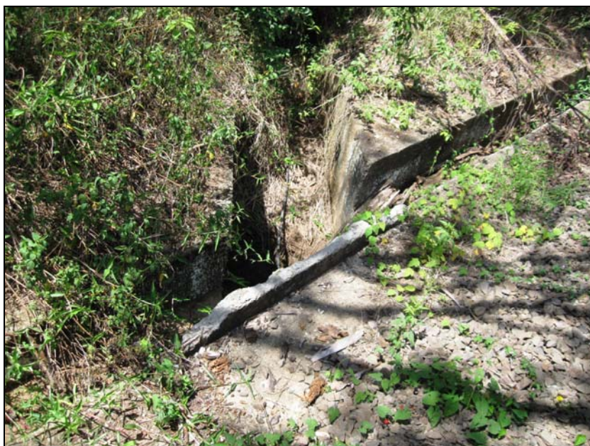
Figura 8.7-5 – Sistema de Drenagem (Galeria) em Bom Estado de Conservação, Município de Roca Sales, Foto SD1600
