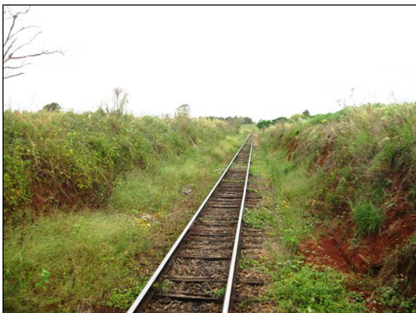
Figura 8.7-18 – Sistema de Drenagem (Ausente), Município de Tupanciretã, SD2329
