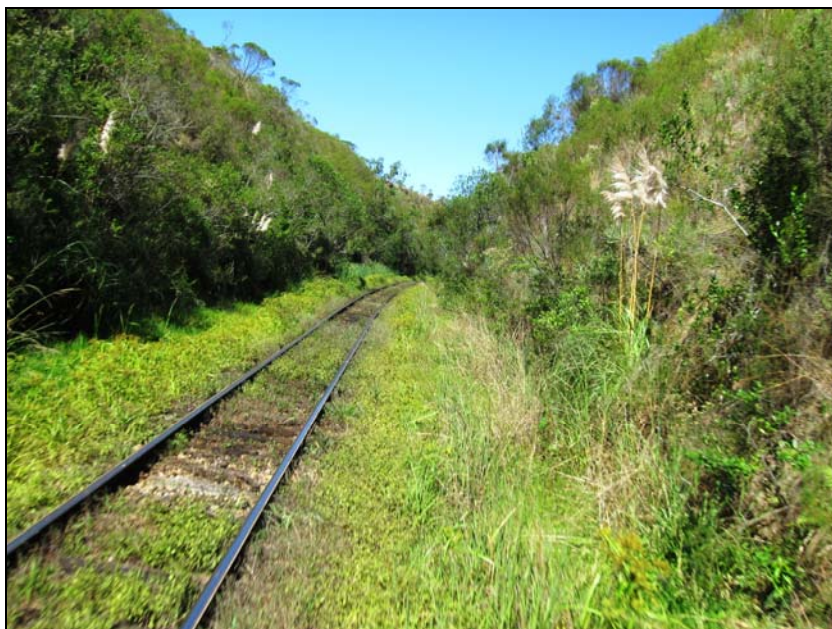
Figura 8.7-36 – Sistema de Drenagem (Canaletas Laterais) em Estado Ruim de Conservação (Ausentes ou Obstruídas), Município de Pinheiro Machado, Foto SD3986.
