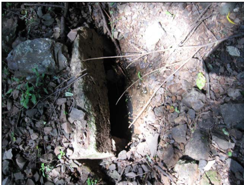
Figura 8.7-2 – Sistema de Drenagem (Galeria) em Médio Estado de Conservação (Parcialmente Entupido), Município de Ipê, Foto SD1391
