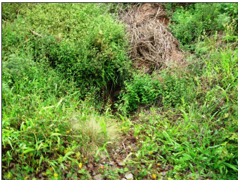
Figura 8.7-17 – Sistema de Drenagem (Galeria) em Estado Médio de Conservação (Falta de Limpeza), Município de Julio de Castilhos, SD2367
