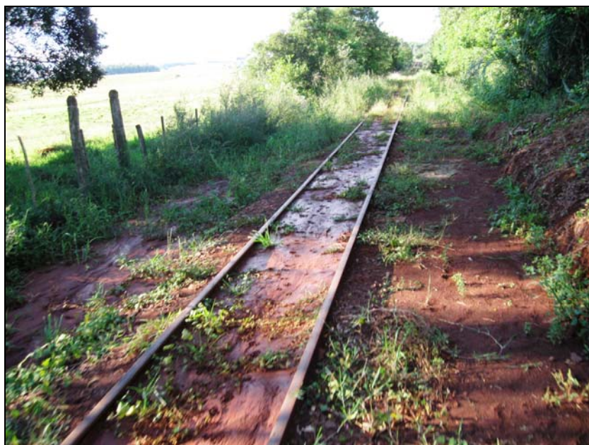
Figura 8.7-15 – Sistema de Drenagem (Ausente) Gerando Deposição e Alagamento, Município de Santo Ângelo, SD2166
