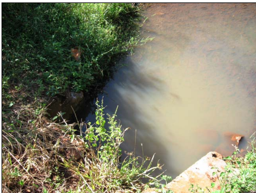
Figura 8.7-11 – Sistema de Drenagem (Galeria) em Estado Médio de Conservação (Parcialmente Entupido), Município de Catuípe, Foto SD2122
