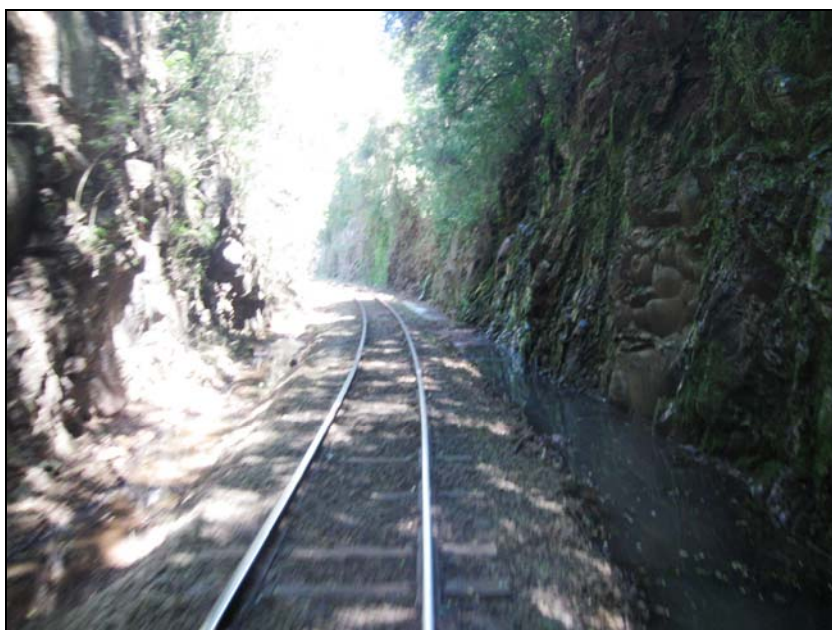
Figura 8.7-3 – Sistema de Drenagem (Galeria) em Estado Ruim de Conservação (Entupido), Município de Vila Flores, foto SD1416.
