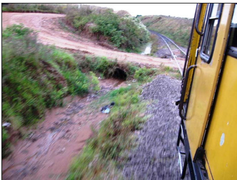
Figura 8.7-21 – Sistema de Drenagem (Tubo) em Estado Ruim de Conservação (Parcialmente Entupido), Município de Santa Maria, SD2449
