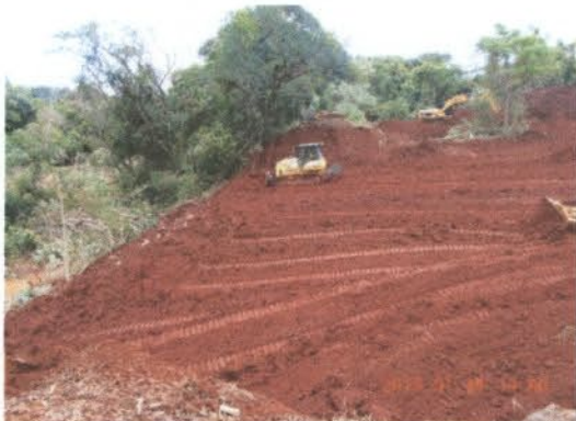
Foto 3 – Destaque para o trabalho das máquinas realizando a terraplanagem do terreno. A esquerda, fragmento florestal inalterado pelas obras.
