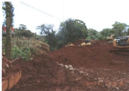
Foto 2 – Detalhe para a região onde houve a completa perda da via férrea pelo deslocamento de massa.
