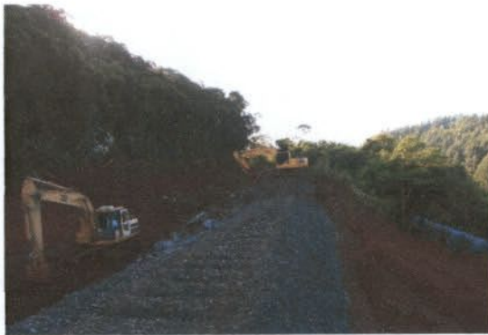
Foto 1 – Restruturação do lastro após primeiro deslizamento de terra. Detalhe para a diferença no corte do relevo do lado direito da fotografia.
