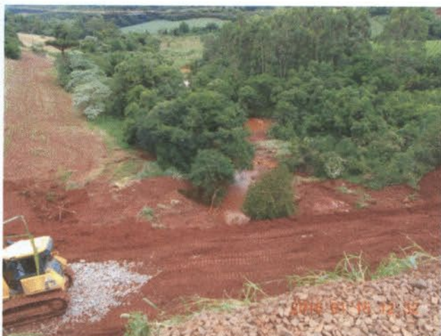
Foto 7 - Detalhe da rede de drenagem coincidindo para a área de preservação permanente, com grande assoreamento decorrente da movimentação de massa.
