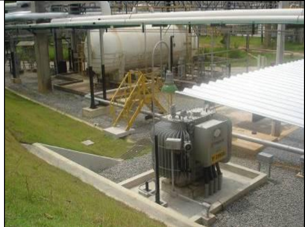
Foto IV.5.3.6-7 - Instalações elétricas. Fonte: PETROBRAS.
