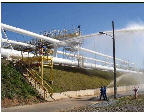
Foto IV.5.3.6-5 - Testes das instalações do sistema de proteção e combate a incêndio. Fonte: PETROBRAS.
