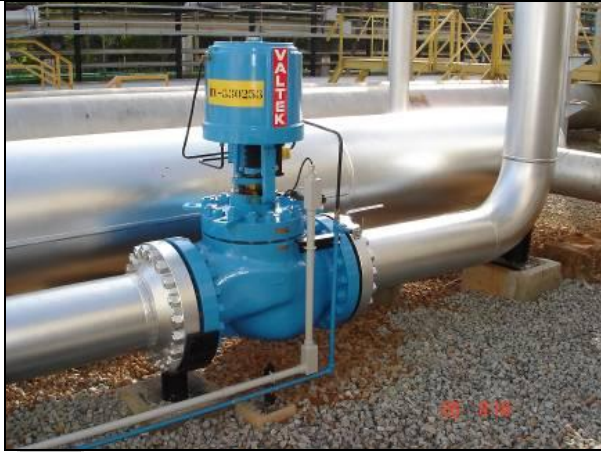
Foto IV.5.3.6-6 - Instalações de instrumentação, automação e controle. Fonte: PETROBRAS.
