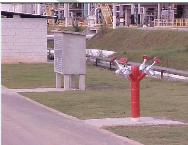
Foto IV.5.3.6-4 - Sistema de proteção e combate a incêndio: hidrante e abrigo de mangueira de incêndio. Fonte: PETROBRAS.
