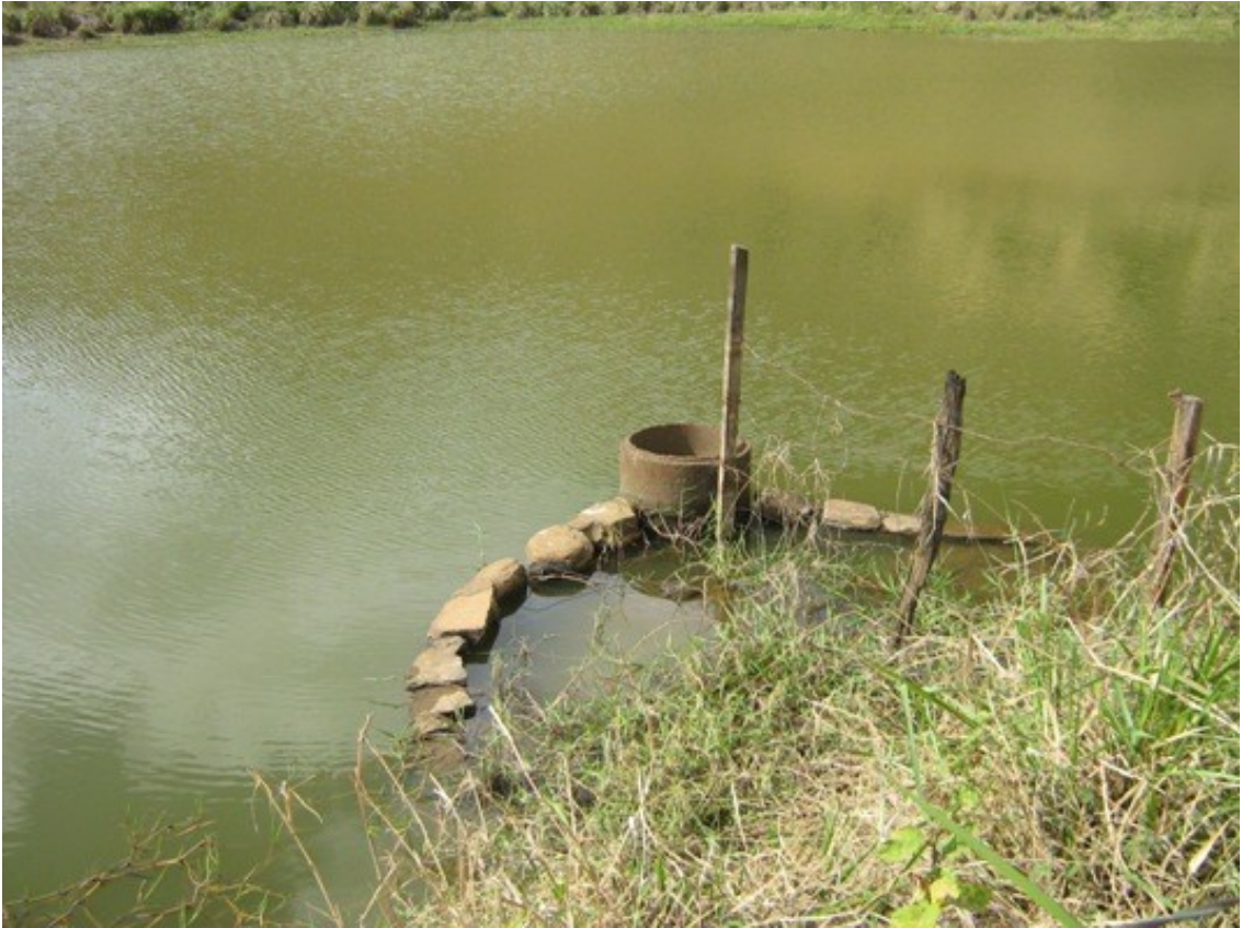
FOTO 299 – Açude sem vertimento - Ponto 3076.
