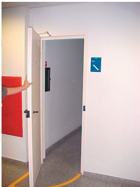
Figura 46 - PCF em corredor
