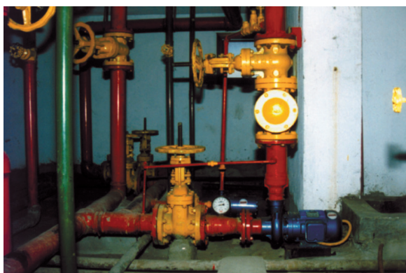
Figura 60 - Bomba de incêndio e acessórios hidráulicos
