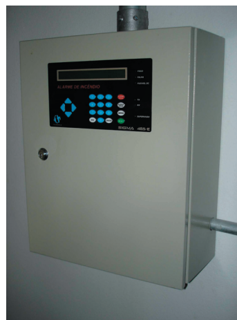
Figura 54 - Central de alarme
