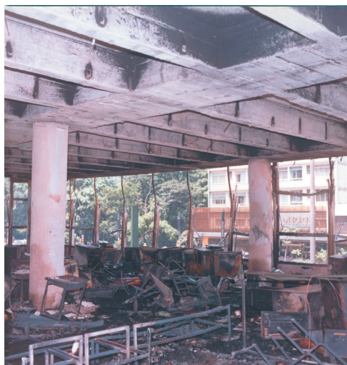
Figura 15 - Incêndio no pavimento
