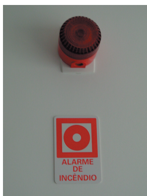
Figura 53 - Detalhe de sirene
