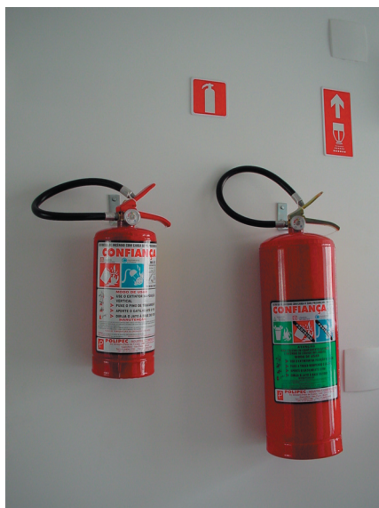
Figura 9 – Extintor de incêndio
