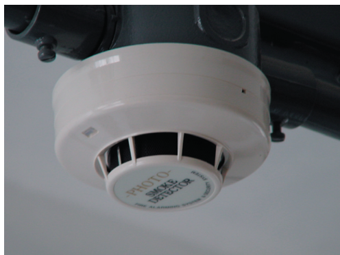
Figura 51 - Detetor de incêndio
