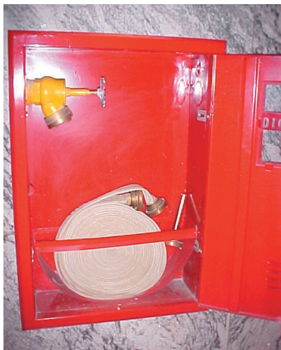
Figura 4 - Sistema de hidrantes
