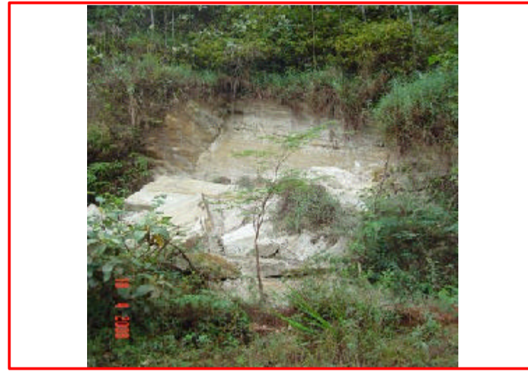
2 - Queda de blocos na região do vale do Rio Santo Antônio, vertente oriental da Serra do Espinhaço. O alto grau de intemperismo da rocha, a elevada declividade da vertente, associada a um corte à margem da estrada que atravessa a região favoreceu o surgimento do foco de erosão.
