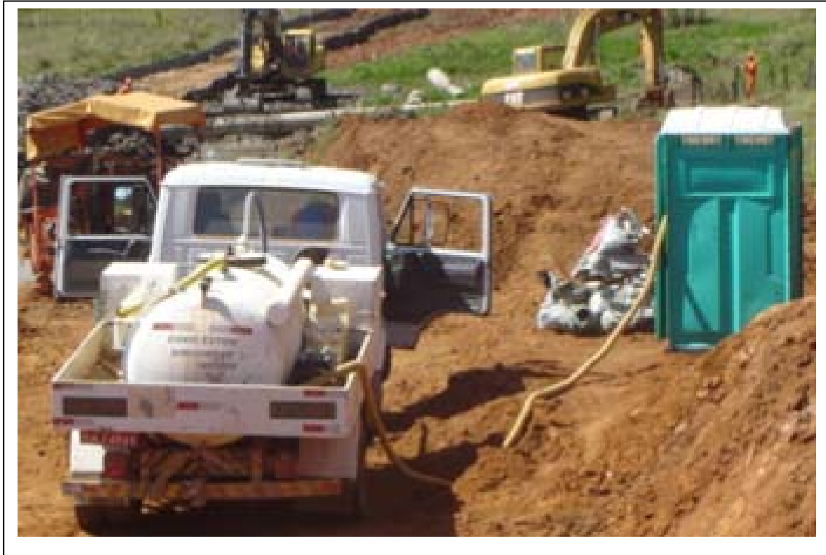
Foto 7 – Manutenção e limpeza de um banheiro químico
