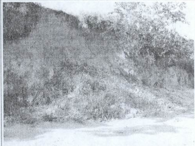
Foto 36: Km 156,5 - solapamento de talude lateral à faixa.
