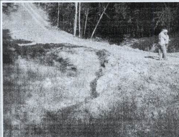
Foto 35: Km 157 - vazão insuficiente em meio corpo hídrico ocupado pela faixa.
