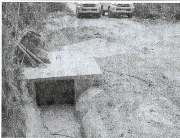
Foto 17: detalhe de caixa e canaleta definitiva.
