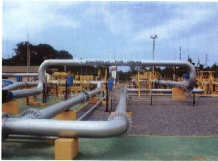
Foto 4. Interligação entre os gasodutos Pilar-Ipojuca e Gasalp na Estação de Ipojuca/PE.
