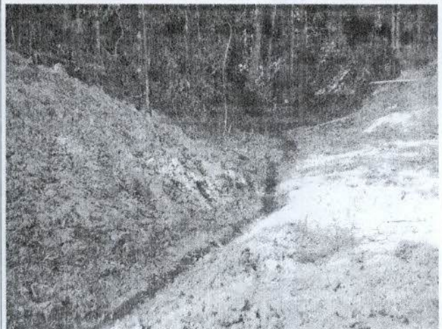
Foto 34: Km 157 – drenagem sob risco de assoreamento.
