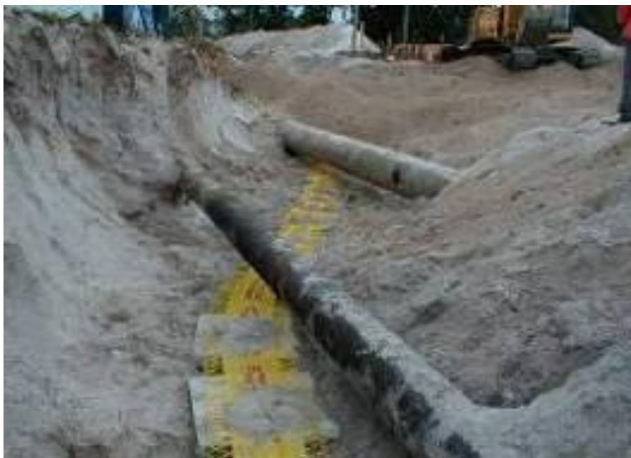
Figura 3.4-55 - Fita de Aviso - indicando que há outro duto instalado abaixo dos dutos aparentes. Fonte: Petrobras
