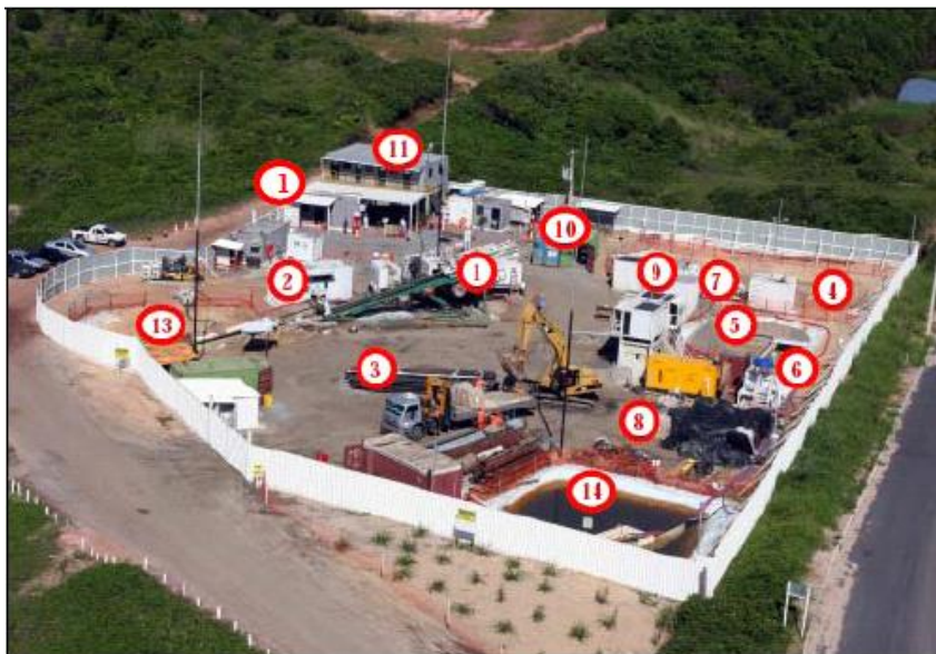
Figura 3.4-33 - Foto de canteiro de execução de furo direcional em Anchieta, ES. Projeto Gasoduto Sul-Capixaba. Os números equivalem aos identificados no desenho esquemático, apresentado na Figura 3.4-28. Fonte: Petrobras.
