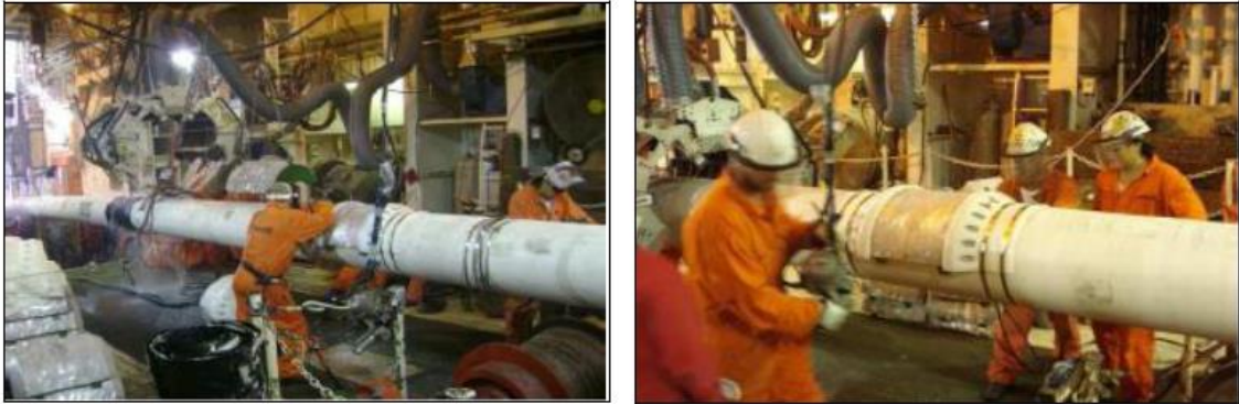
Figura 3.4-15 - Aplicação dos anodos de sacrifício e do inibidor de propagação de colapso ( buckle arrestor ). Fonte: Petrobras.
