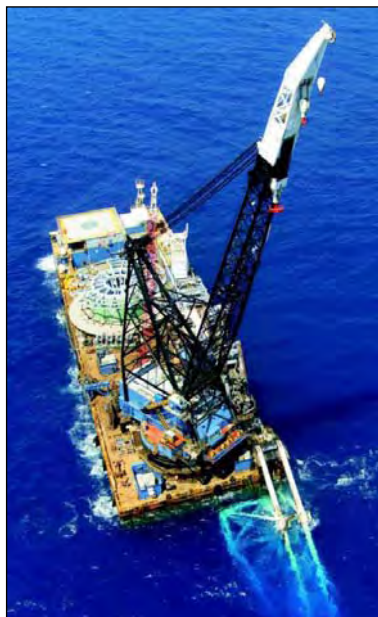
Figura II.2.4.2.1-7 – Embarcação Típica de utilização do método S-Lay do tipo Balsa.
