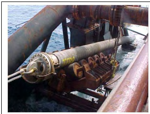
Figura II.2.4.2.1-3 – Passagem da cabeça de abandono sobre os roletes da embarcação Típica S-Lay.
