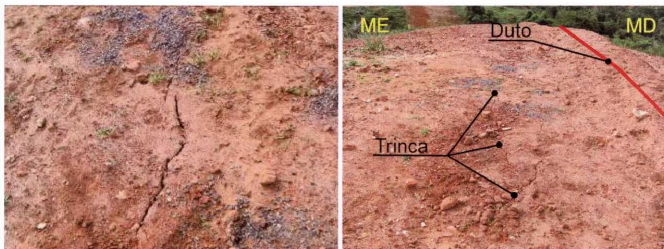
Figura 1 – trinca longitudinal a montante de uma dolina no km 448 +100m.
