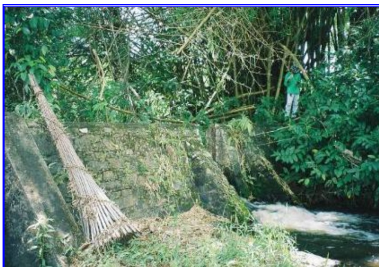
Foto 5.273- Ruínas da represa no Rio Cupioba. Foto Mirta Barbosa.
