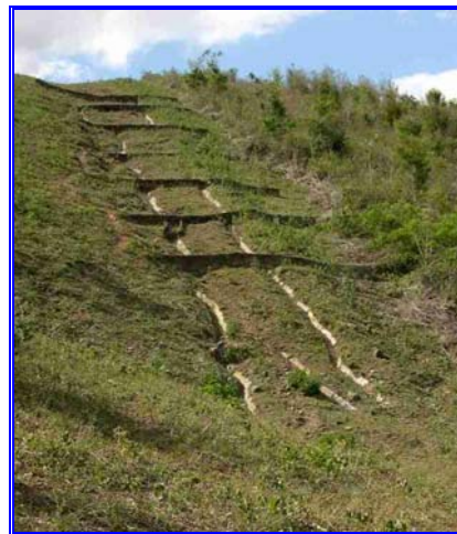
Foto 5.90- Área com problemas de conservação, coordenadas 425374 e 8435271. Foto BOURSCHEID
