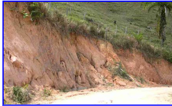
Foto 5.59- Área de migmatitos da unidade A3jo com ocorrência de processos erosivos e desmoronamentos até próximo à superfície do solo – Coordenadas E: 449838, N: 8495627. Foto BOURSCHEID
