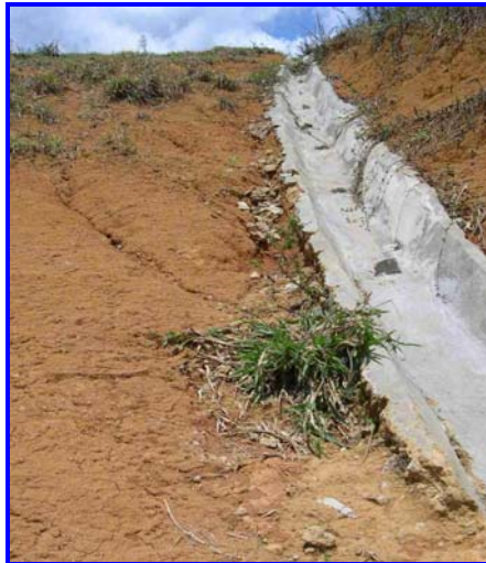
Foto 5.86- Área com problemas de conservação, coordenadas 431856 e 8461163. Foto BOURSCHEID
