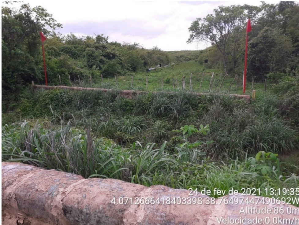
Figura 4.2-19 – Área de Preservação Permanente do rio Forquilha, travessia no km 38+700 do GASFOR II.
