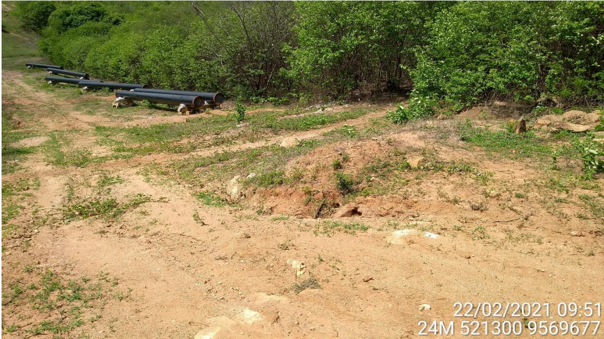
Figura 4.1-2 - Exemplo de processo erosivo na faixa do GASFOR II, localizado no km 59
