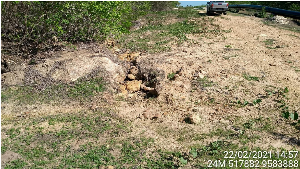
Figura 4.1-3 - Exemplo de processo erosivo na faixa do GASFOR II, localizado no km 74
