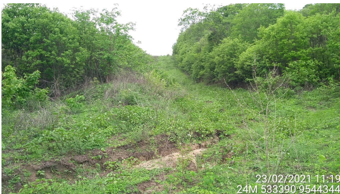
Figura 4.1-1 - Exemplo de processo erosivo na faixa do GASFOR II, localizado no km 28
