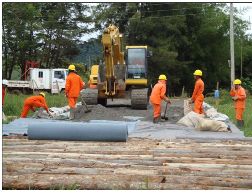
FOTO 6.2-87: Construção de estiva para passagem de máquinas e equipamentos, no km 216+580, coordenadas em UTM: N= 7.649.653/E= 638.698 (Fonte: Lenc, nov/09).
