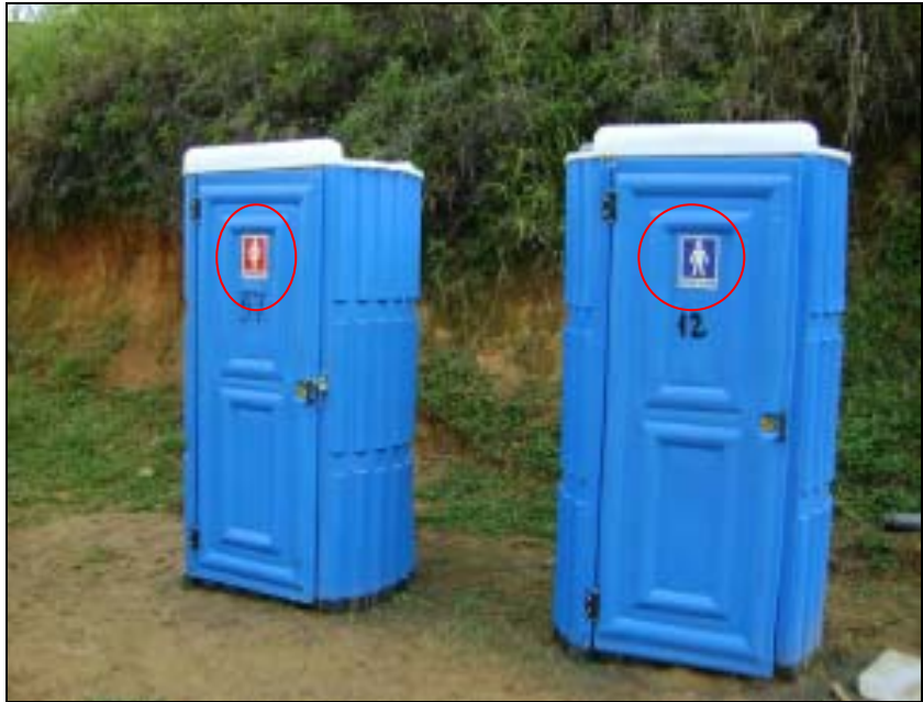
FOTO 6.1.1-120: Área de vivência no km 122; destaque para os banheiros químicos (feminino e masculino) dispostos para uso dos colaboradores, coordenadas em UTM N=7.567.738/E=655.688 (Fonte: Remma GDK, fev/10).
