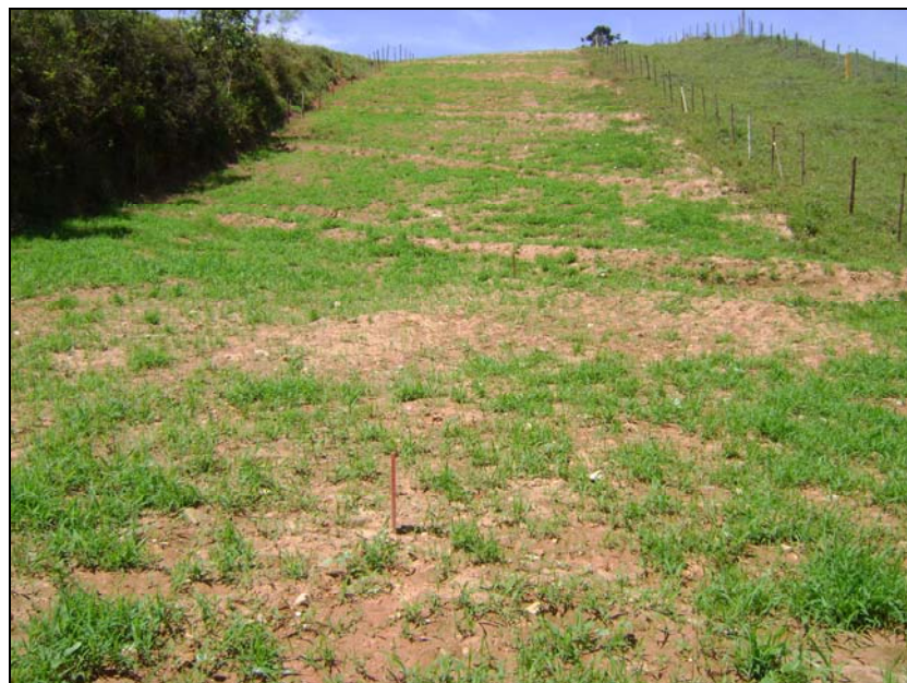
FOTO 6.3-40: Recomposição da vegetação na faixa no km 192, coordenadas em UTM N= 7.631.367/E= 648.379 (Fonte: Remma Construcap, nov/09).
