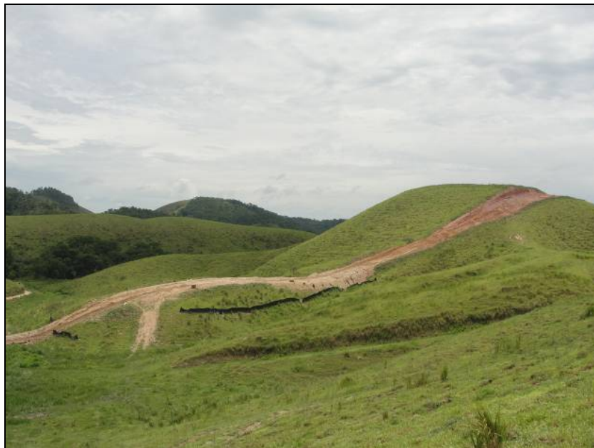
FOTO 6.2-23: Instalação de barreiras com manta geotêxtil visando evitar carreamento de sedimentos sólidos para APP, no km 16, coordenadas em UTM N= 7.509.315 /E= 612.678 (Fonte: Remma – Azevedo Travassos, dez/09)
