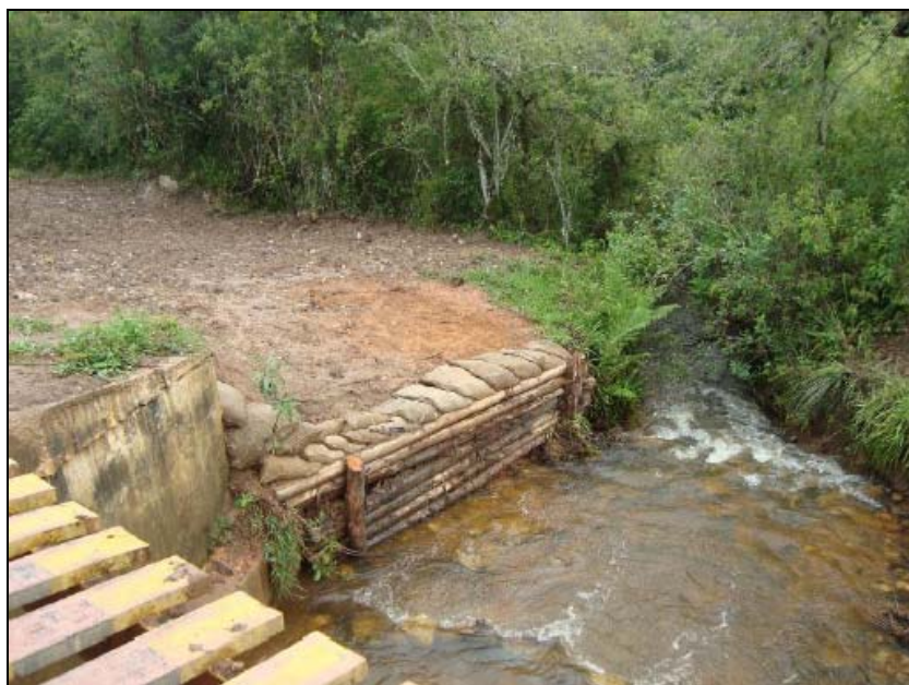
FOTO 6.2-65: Contenção às margens de curso d'água – APP, no km 252+888, coordenadas em UTM N= 7.680.710 /E= 622.679 (Fonte: Remma - Egesa, dez/09).
