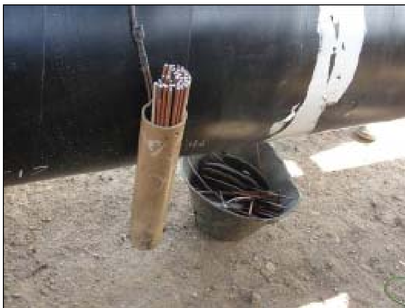
FOTO 6.1.2-40: Armazenamento adequado de discos e eletrodos utilizados nas atividades de solda, coordenadas em UTM N=7.545.961/ E=658.765 (Fonte: Remma Azevedo & Travassos, jan/10).
