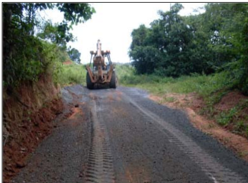
FOTO 6.3-100: Melhoria do acesso ao km 145 da faixa de servidão, coordenadas em UTM N= 7.589.538/E= 655.324 (Fonte: Remma – Construcap, fev/10).
