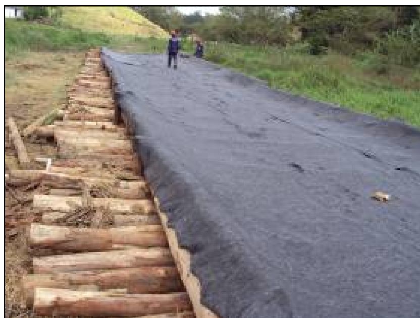
FOTO 6.2-83: Construção de estiva como estrutura preventiva em área de sensibilidade ambiental, no km 28, coordenadas em UTM: N= 7.510.257/E= 622.854 (Fonte: Remma Azevedo Travassos , set/09).
