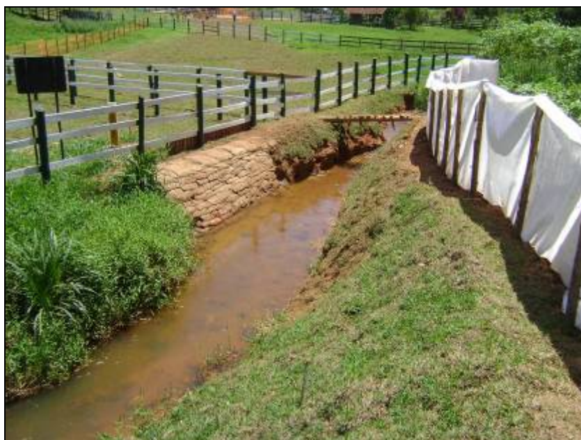
FOTO 6.2-61: Dique de contenção para recomposição da margem do curso d'água e telas-filtro para contenção de sedimentos sólidos, no km 192+800, coordenadas em UTM: N= 7.631.683/E= 648.344 (Fonte: LENC, out/09).
