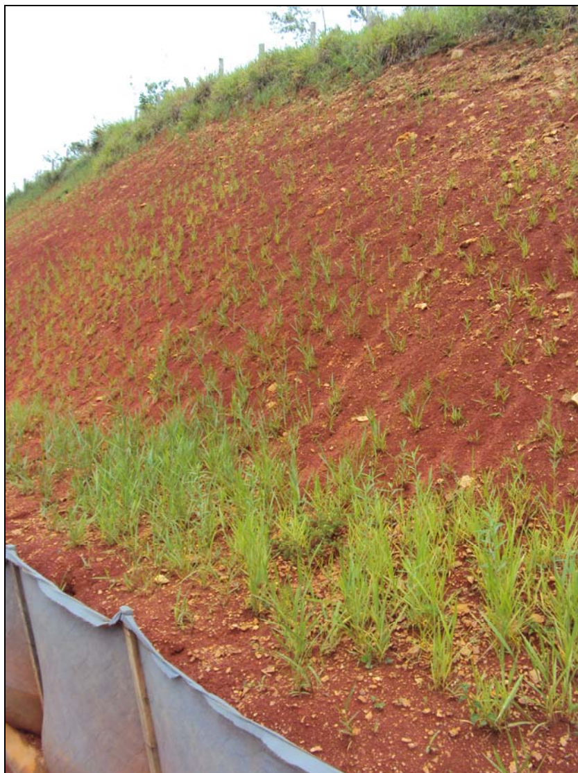
FOTO 6.3-45: Revegetação através de hidrossemeadura no talude de corte do canteiro operacional de Rio das Flores-RJ, coordenadas em UTM N= 7.556.706/E= 648.650 (Fonte: Lenc, nov/09).
