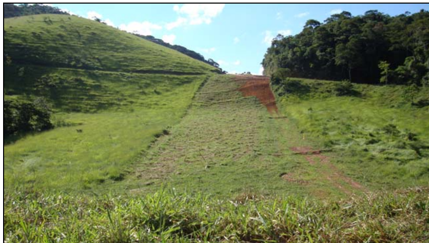
FOTO 6.3-79: Faixa de servidão com recomposição vegetal no km 104, coordenadas em UTM N= 7.550.968/E= 657.603 (Fonte: Lenc, mai/10).
