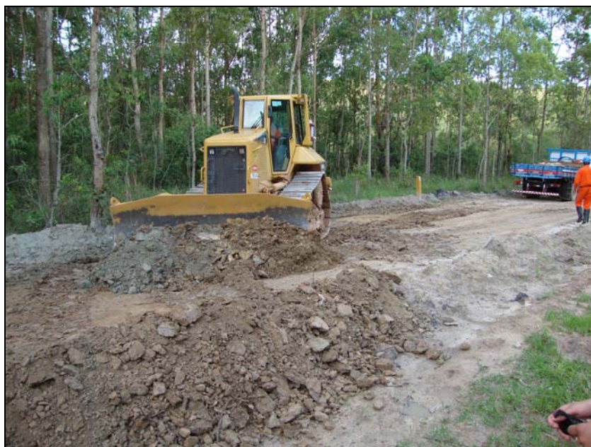
FOTO 6.2-100: Abertura de pista no km 243+780, coordenadas em UTM: N= 7.671.842/E= 624.916 (Fonte: Lenc, nov/09).
