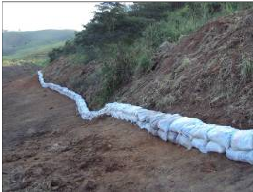
FOTO 6.2-15: Estrutura de contenção de sedimentos sólidos em saco de ráfia com solo, no km 37 + 180, coordenadas em UTM N= 7.516.069/E= 629.515 (Fonte: Remma Azevedo Travassos, jul/09).
