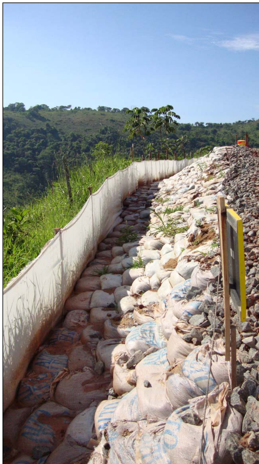
FOTO 6.2-31: Barreira de contenção de sedimentos com manta (silt fence) e sacos de rafia (solo-solo) no furo direcional do Rio do Peixe – km 134+293, coordenadas em UTM N= 7.579.567/ E= 656.406 (Foto: Lenc, jan/10).
