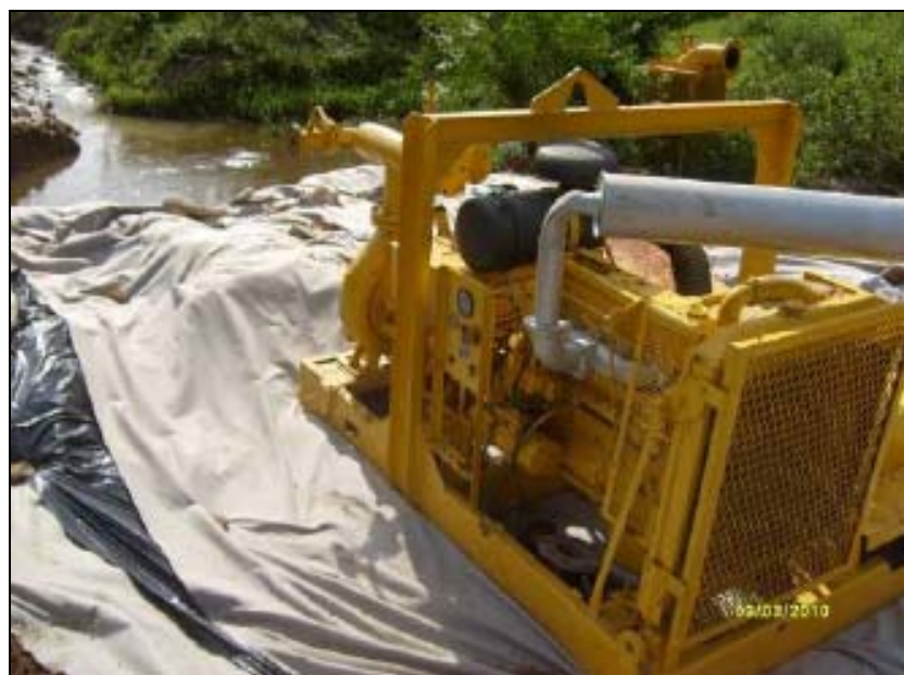
FOTO 6.1.2-55: Montagem da estrutura de captação da água para a realização do teste hidrostático no km 63+900, coordenadas em UTM N=7.529.813 / E= 649.074 (Fonte: Remma Azevedo & Travassos, mar/10).
