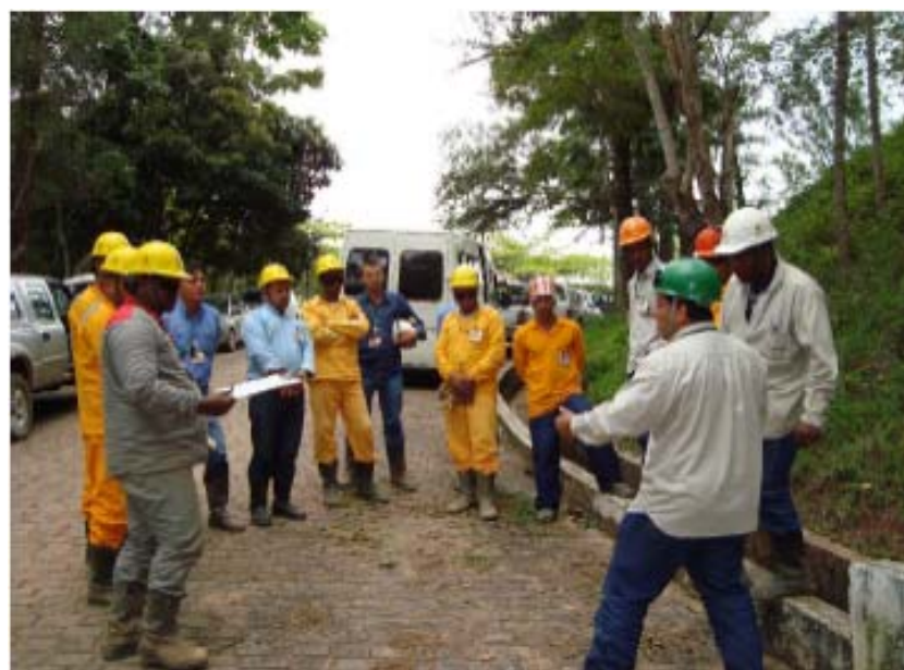
FOTO 6.4.1-3: Treinamento com a equipe de Supressão de Vegetação, antes do início das atividades no km 100, coordenadas em UTM N= 7.546.828/E= 658.649 (Fonte: Remma - Construcap, nov/09).
