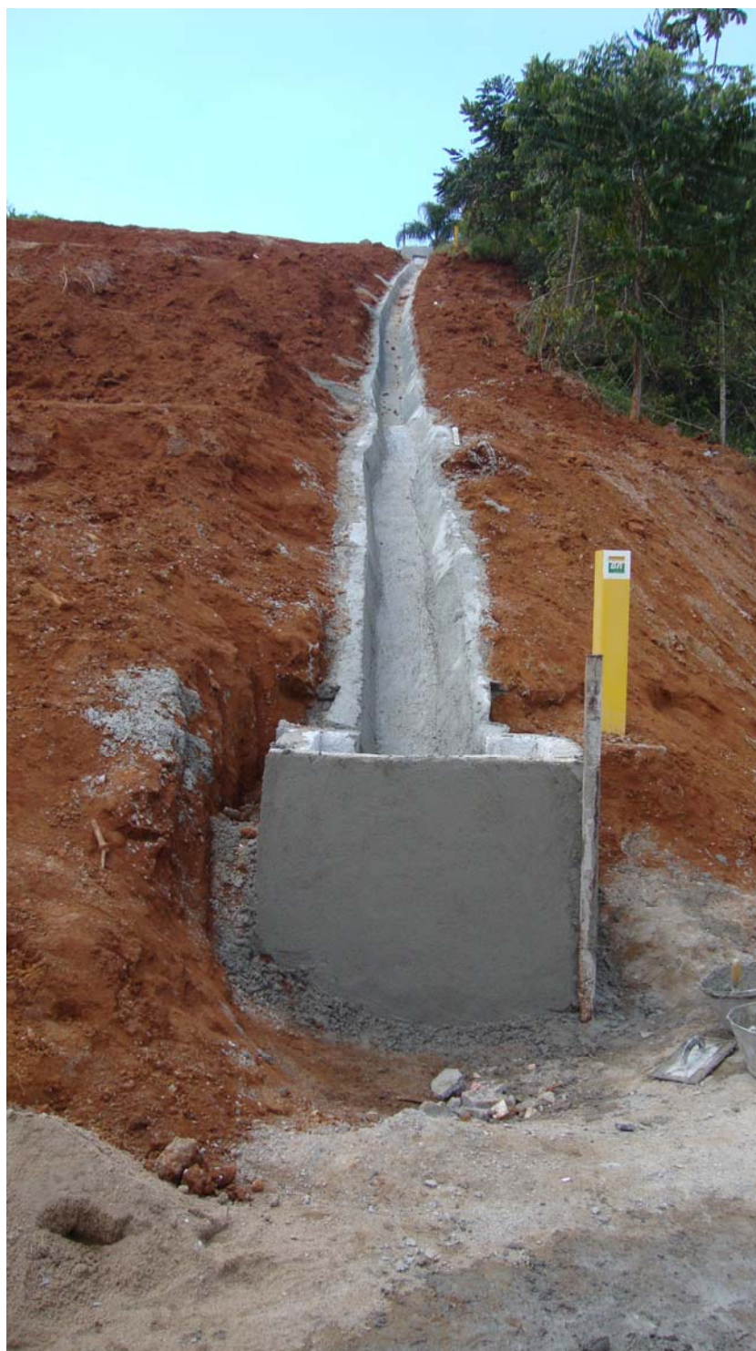
FOTO 6.3-39: Dispositivo definitivo de drenagem, canaletas de direcionamento de água na faixa de servidão no km 128, coordenadas em UTM N= 7.573.638/E= 655.583 (Fonte: Lenc, mai/10).
