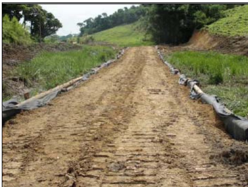
FOTO 6.2-89: Construção de estiva para passagem de máquinas e equipamentos, no km 65+110, coordenadas em UTM: N= 7.530.437 /E= 649.947 (Fonte: Remma – Azevedo Travassos, dez/09).
