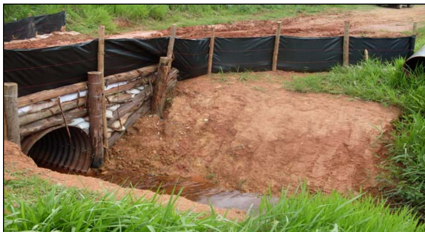
FOTO 6.2-60: Barreira de contenção com o objetivo de evitar o carreamento de sedimentos sólidos para o curso d'água, no km 162+380, coordenadas em UTM N= 7.605.537/E= 655.491 (Fonte: Remma - Construcap, nov/09).
