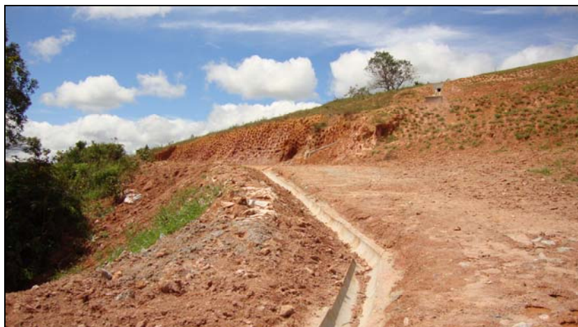
FOTO 6.3-35: Dispositivo definitivo de drenagem, canaletas de direcionamento de água na faixa de servidão no km 242, coordenadas em UTM N= 7.670.862/E= 625.295 (Fonte: Lenc, mar/10).
