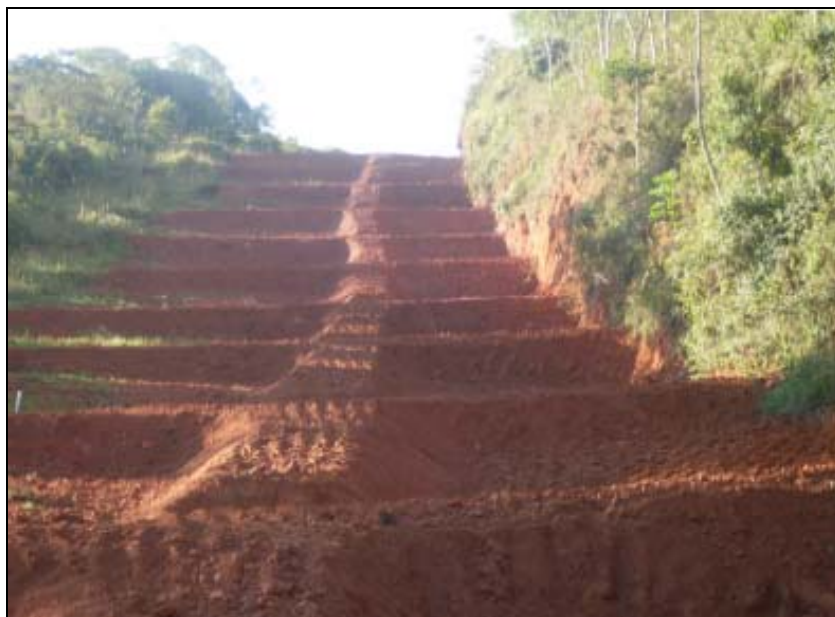
FOTO 6.3-30: Dispositivo definitivo de drenagem pluvial (leiras) no km 170, coordenadas em UTM N= 7.612.269/E= 653.447 (Fonte: Remma - Construcap, mar/10).
