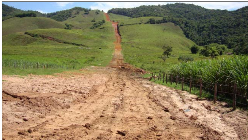
FOTO 6.1.2-6: Área de pastagem no km 125+750, raspagem da faixa realizada em toda a sua largura, coordenadas em UTM N=7.571.369/E=656.245 (Fonte: Lenc, mar/10).
