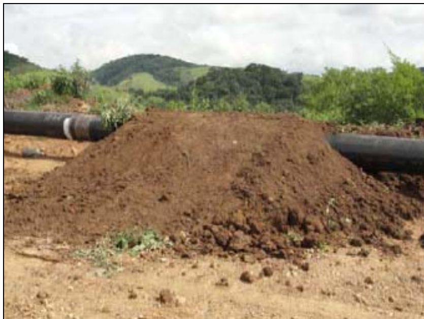
FOTO 6.1.2-42: Aterro para passagem de animais sobre a coluna soldada, coordenadas em UTM N= 7.527.348/E=645.431 (Fonte: Remma Azevedo & Travassos, mar/10).
