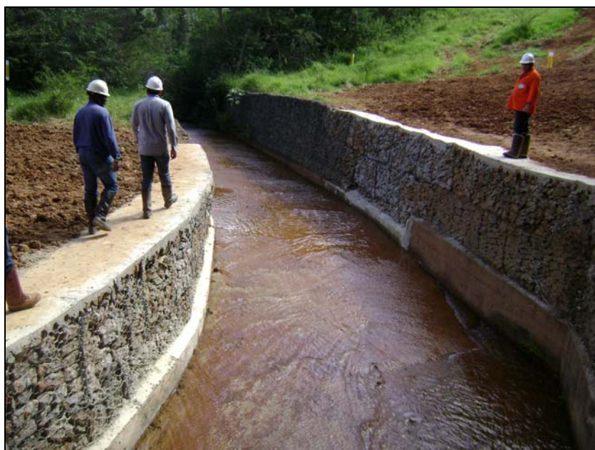
FOTO 6.3-76: Recuperação e contenção das margens do curso d'água (gabião) no km 137+295, coordenadas em UTM N= 7.582.239/E= 655.926 (Fonte: Lenc, mai/10).
