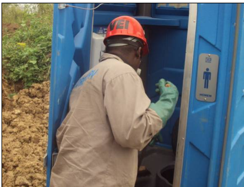
FOTO 6.4.4-12: Recolhimento de efluentes e limpeza de banheiros químicos localizados na frente de obra do km 72+204, coordenadas em UTM N= 7.533.947/E= 655.508 (Fonte: Remma – Azevedo Travassos, dez/09).
