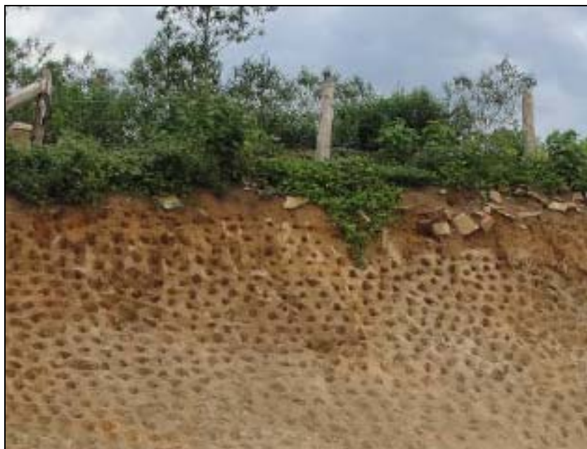
FOTO 6.2-12: Talude pronto para receber hidrossemeadura no km 25+380, coordenadas em UTM N= 7.509.475/E= 620.619 (Fonte: Remma - Azevedo Travassos, mar/10).
