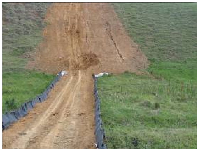
FOTO 6.2-82: Estiva com lateral para contenção de material carreado, no km 60+800, coordenadas em UTM: N= 7.527.987/E= 647.008(Fonte: Remma Azevedo Travassos, out/09).
