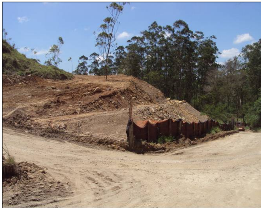
FOTO 6.1.2-12: Área designada para bota-fora (12C), no início da utilização, coordenadas em UTM N=7.510.064/E=622.009 (Fonte: Remma Azevedo&Travassos, mar/10).
