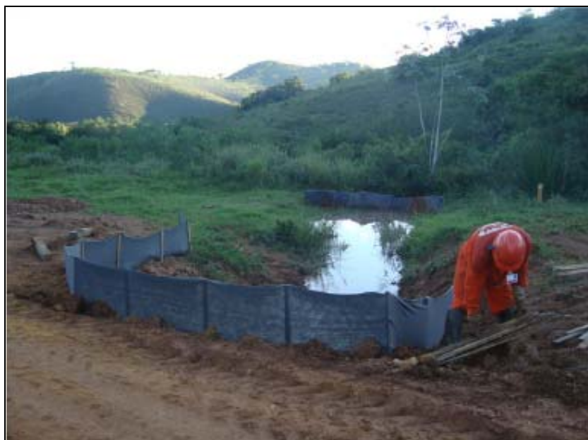
FOTO 6.2-81: Barreira de contenção (manta geotêxtil) às margens de curso d'água, no km 138+830, coordenadas em UTM N= 7.583.757/E= 655.843 (fonte: Remma – GDK, mar/10).
