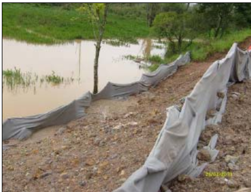
FOTO 6.2-71: Proteção de curso d'água contra carreamento de sedimentos sólidos com manta geotêxtil, km 27, coordenadas N= 7.510.235 / E= 621.877 (Fonte: Remma – Azevedo Travassos, fev/10).
