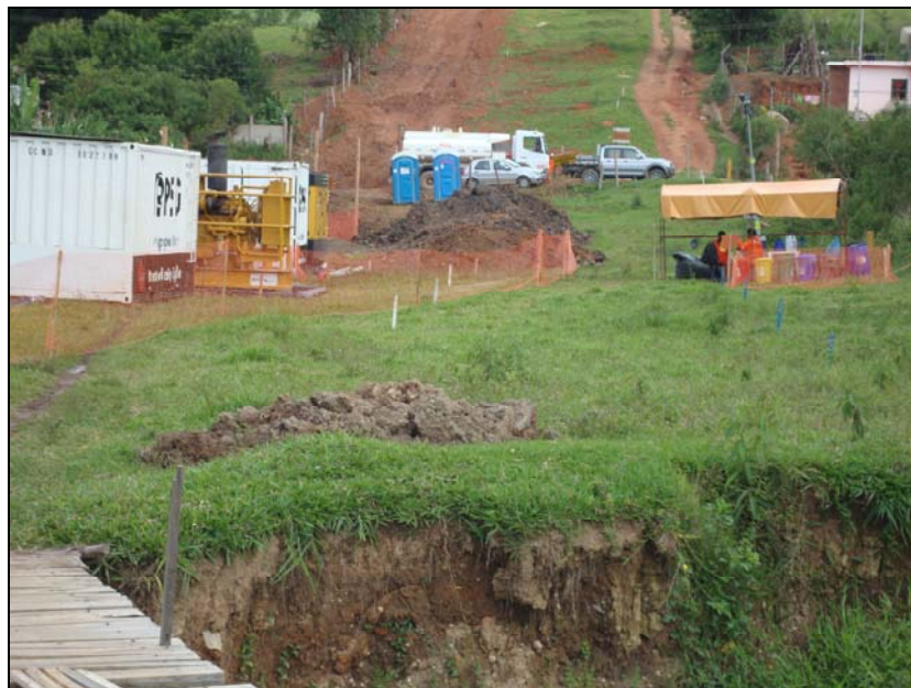
FOTO 6.4.4-21: Banheiro químico e kit de coleta seletiva localizados no km 254+600, coordenadas em UTM N= 7.682.281/E= 622.051 (Fonte: Lenc, dez/09).
