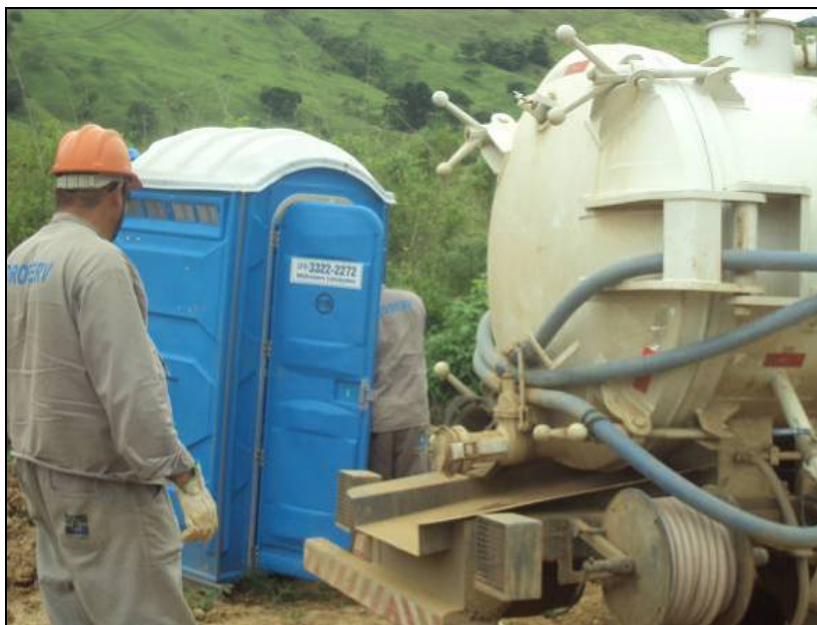
FOTO 6.4.4-11: Recolhimento de efluentes e limpeza de banheiros químicos localizados na frente de obra do km 72, coordenadas em UTM N= 7.533.807/E= 655.367 (Fonte: Remma – Azevedo Travassos, dez/09).
