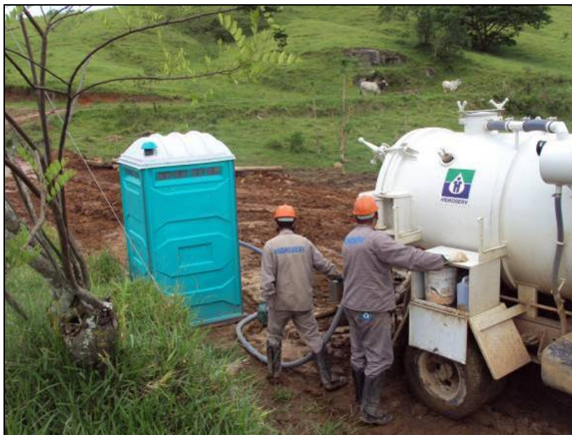
FOTO 6.4.4-10: Recolhimento de efluentes e limpeza de banheiros químicos localizados na frente de obra do km 52, coordenadas em UTM N= 7.524.224/E= 639.621 (Fonte: Remma – Azevedo Travassos, dez/09).
