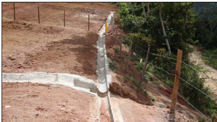
FOTO 6.3-38: Dispositivo definitivo de drenagem, canaletas de direcionamento de água na faixa de servidão no km 125, coordenadas em UTM N= 7.571.159/E= 656.360 (Fonte: Lenc, mai/10).
