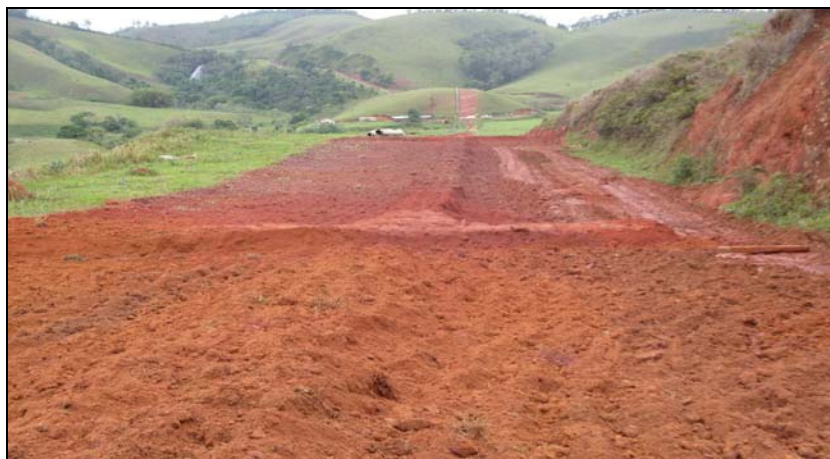
FOTO 6.3-2: Recomposição mecânica da faixa após as intervenções no km 149, coordenadas em UTM N= 7.593.463/E= 655.656 (Fonte: Remma Construcap, out/09).
