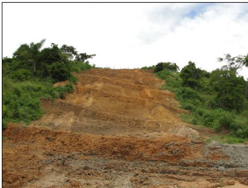
FOTO 6.2-110: Construção de leiras provisórias no km 63, coordenadas em UTM N= 7.529.353/E= 648.408 (Fonte: Remma – Azevedo Travassos, jan/10).
