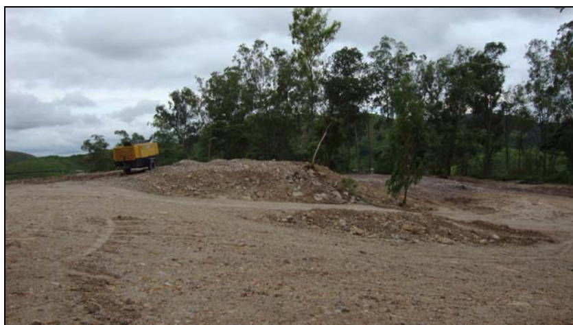
FOTO 6.1.2-11: Área designada para bota-fora (12B), em utilização, coordenadas em UTM N=7.510.141 / E=621.915 (Fonte: Lenc, mar/10).
