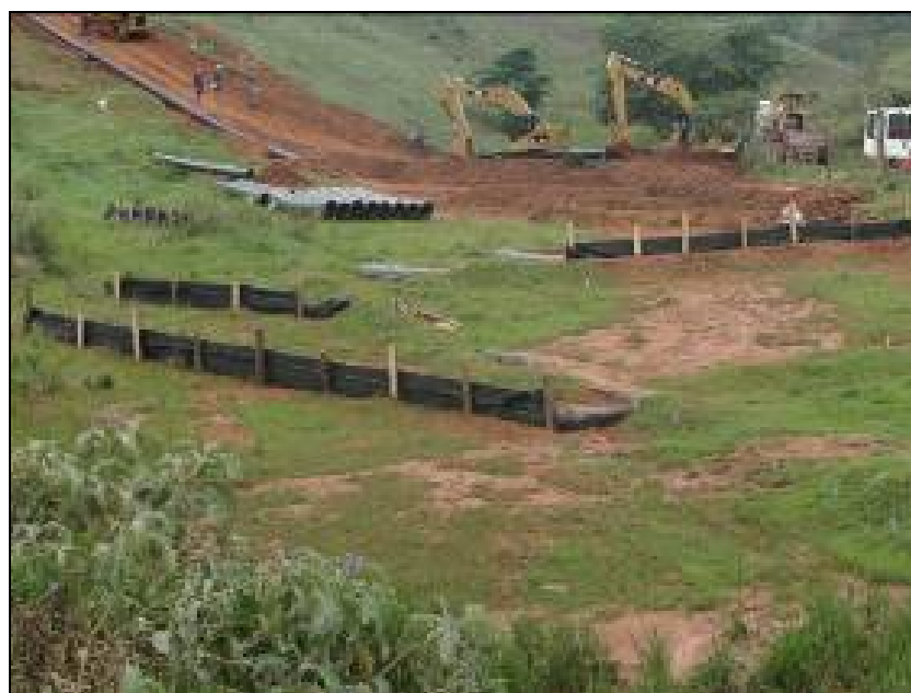
FOTO 6.2-18: Vista geral das estruturas de contenção de sedimentos sólidos com manta geotêxtil no km 84, coordenadas em UTM N= 7.544.022/E= 658.908 (Fonte: Remma Azevedo Travassos, out/09).
