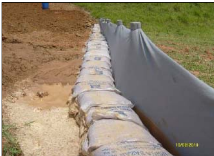
FOTO 6.2-36: Barreiras de contenção com manta geotêxtil para evitar o carreamento de sedimentos sólidos, no km 15, coordenadas em UTM N= 7.508.699/ E= 611.922 (Fonte: Remma – Azevedo Travassos, fev/10).
