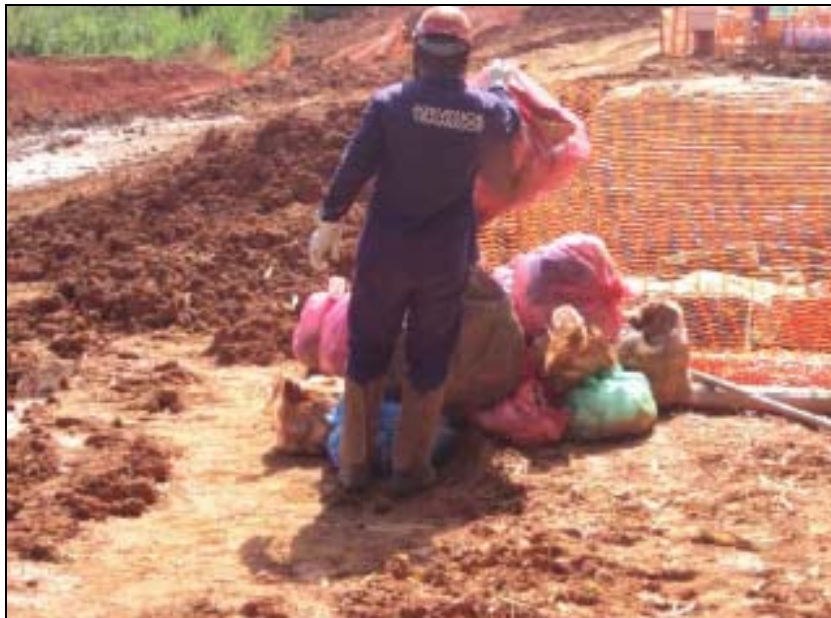
FOTO 6.4.3-48: Recolhimentos de resíduos no km 58/59 da faixa de servidão, coordenadas em UTM N= 7.527.003 /E= 644.503 (Fonte: Remma – Azevedo Travassos, mar/10).
