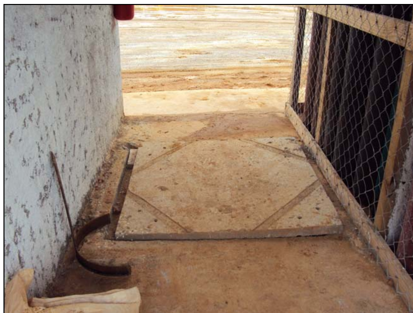
FOTO 6.1.1-70: Caixa de retenção, coordenadas em UTM N=7.556.706/E=648.650 (Fonte: Lenc, abr/10).
