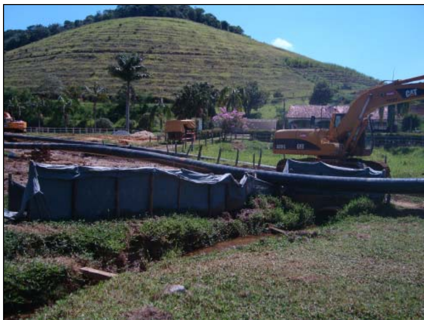
FOTO 6.2-74: Barreira de contenção de sedimentos sólidos para proteção de recurso hídrico, no km 135+080, coordenadas em UTM N= 7.580.070/ E= 656.332 (fonte: Remma - GDK, fev/10).
