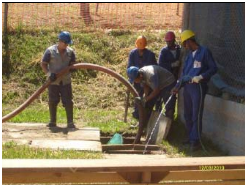
FOTO 6.1.1-78: Limpeza da fossa séptica, coordenadas em UTM N=7.536.965/E=659.432 (Fonte: Remma Azevedo & Travassos, fev/10).
