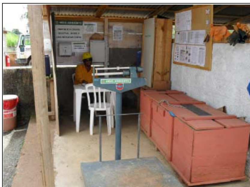
FOTO 6.4.3-38: Local de pesagem dos resíduos antes de serem acondicionados nas baias, no canteiro operacional de Juiz de Fora - MG, coordenadas em UTM N= 7.597.871/E= 661.013 (Fonte: Remma - Construcap, fev/10).
