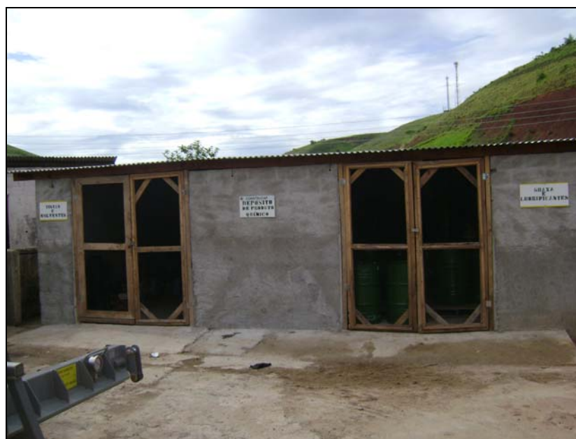
FOTO 6.4.3-18: Baias de armazenamento de produto químico no canteiro operacional de Juiz de Fora - MG, coordenadas em UTM N=7.599.146/E= 661.818 (Fonte: Lenc, jan/10).
