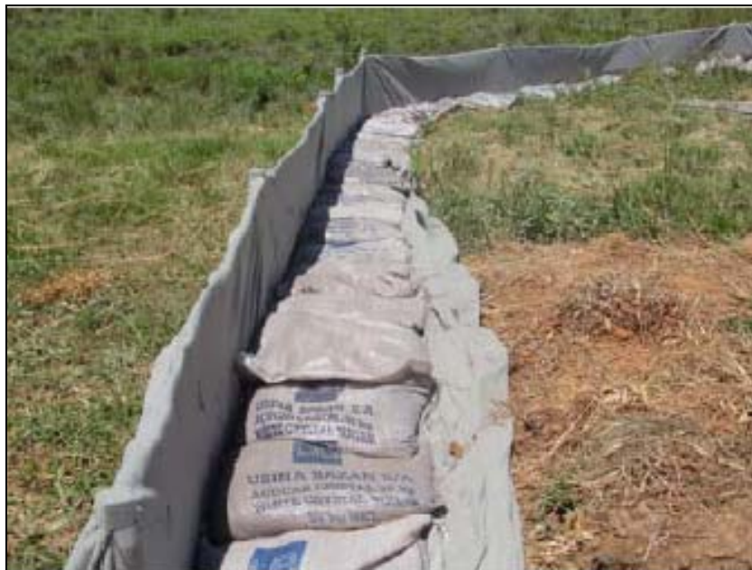
FOTO 6.2-35: Barreiras de contenção com manta geotêxtil para evitar o carreamento de sedimentos sólidos no km 27, coordenadas em UTM N= 7.510.235/ E= 621.877 (Fonte: Remma – Azevedo Travassos, fev/10).
