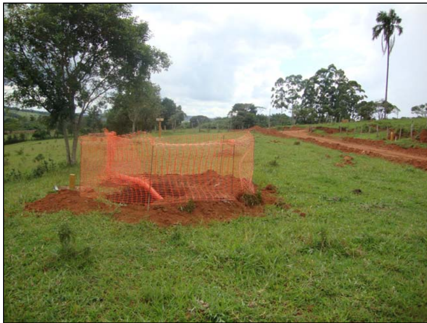
FOTO 7.1.3-1: Buraco protegido por tela de malha quadrada e vermelha no km 281+180m da faixa, coordenadas em UTM: N=7.706.630/E=614.991 (Fonte: LENC, mar/10).
