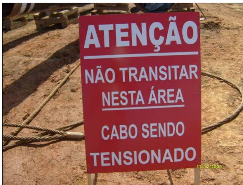
FOTO 7.1.5-1: Sinalização para o risco de acidentes com cabos, no km 69, coordenadas em UTM: E= 652.987 / N= 7.532.609 (Fonte: REMMA Azevedo & Travassos, dez/09).
