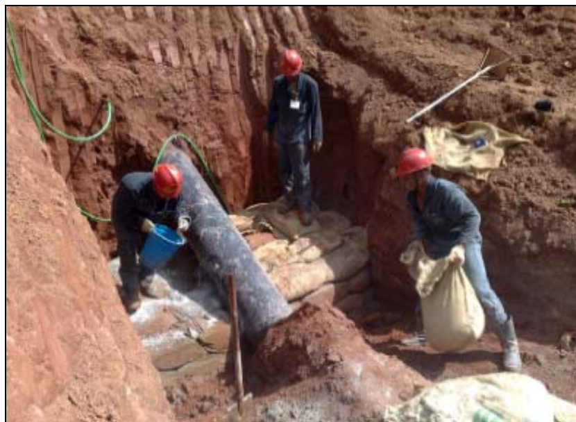
FOTO 6.1.2-51: Construção de dique com solo-cimento ensacado no km 100, coordenadas em UTM N=7.546.828 / E= 658.649 (Fonte: Remma Construcap, mar/10).
