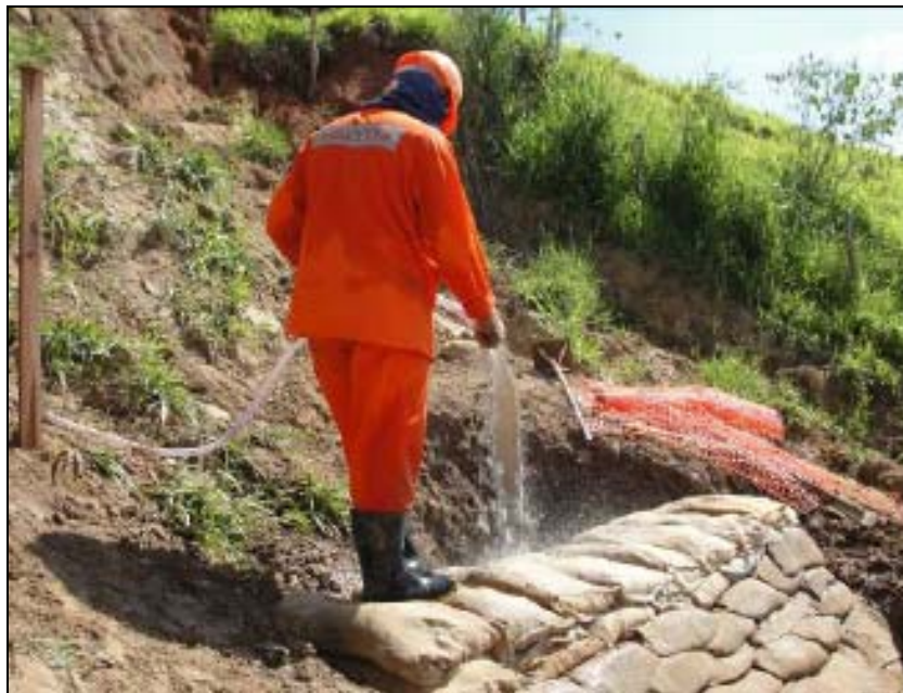
FOTO 6.2-29: Construção de dique de contenção no km 77, coordenadas em UTM N=7.537.429 / E= 658.366 (Fonte: Remma – Azevedo Travassos, jan/10).
