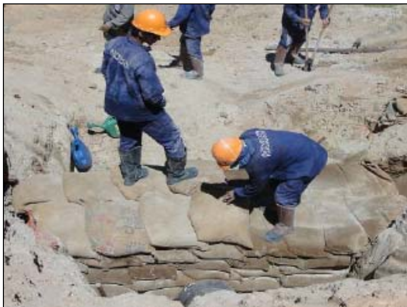
FOTO 6.2-39: Construção de dique de contenção no km 04+6,00, coordenadas em UTM N= 7.507.367/ E= 602.637 (Fonte: Remma – Azevedo Travassos, fev/10).
