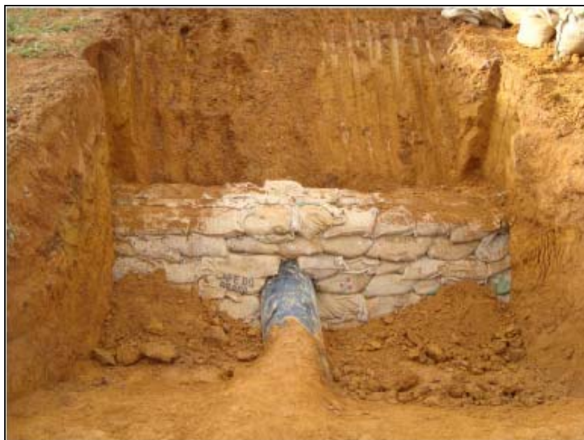
FOTO: 6.2-48: Construção de dique no km 126+318, coordenadas em UTM N= 7.571.777/E= 656.103 (fonte: Remma – GDK, mar/10).
