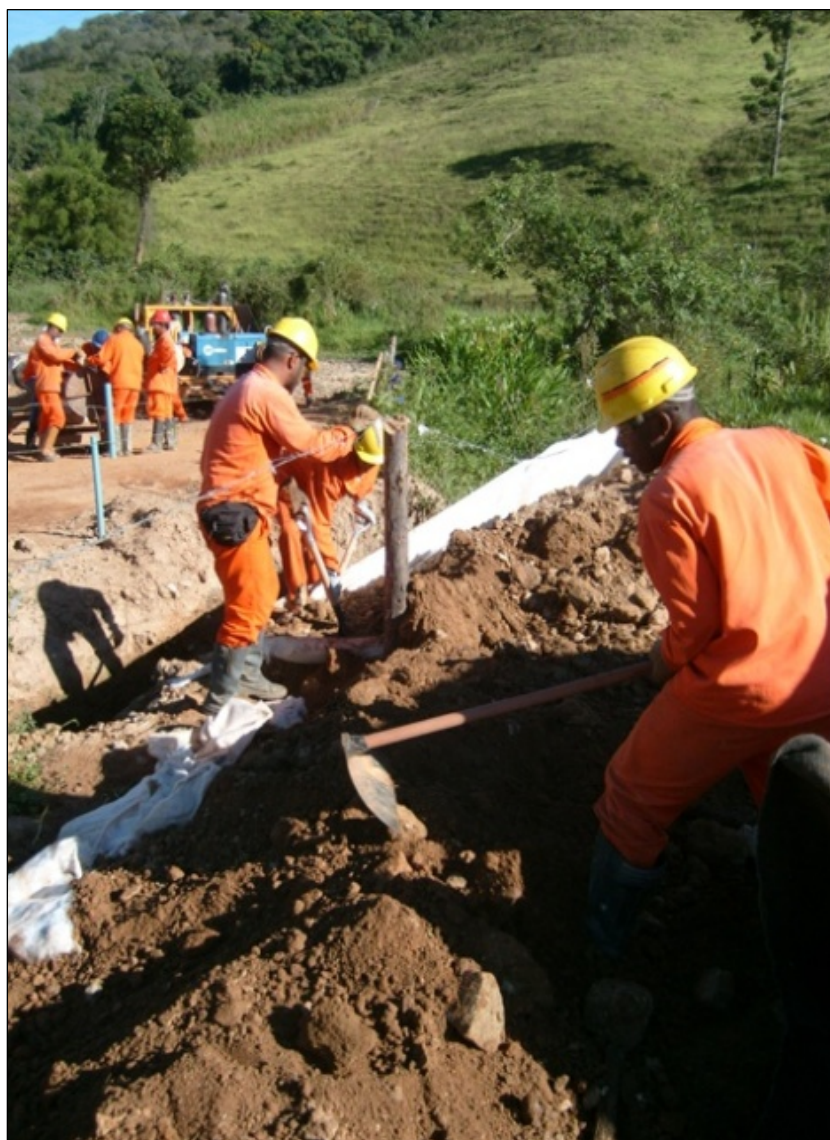
FOTO 6.2-45: Implantação de proteção com manta geotêxtil contra carreamento de sedimentos sólidos, no km 208, coordenadas em UTM N= 7.643.101/E= 643.711(fonte: Remma - Egesa, fev/10).
