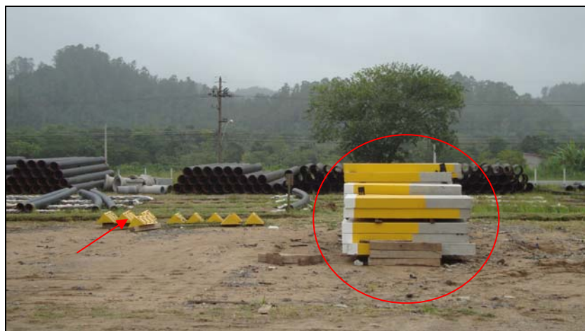
FOTO 6.1.1-112: Marcos para demarcação da faixa de servidão após a conclusão da obra, coordenadas em UTM N=7.512.069/E=601.305 (Fonte: Lenc, fev/10).
