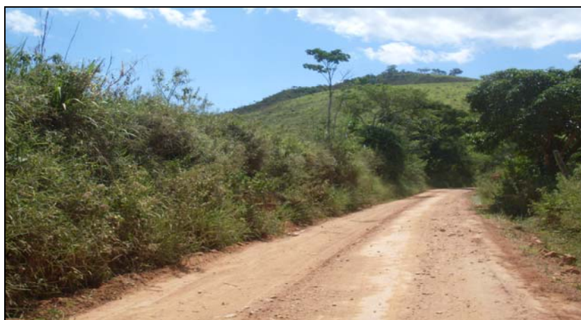
FOTO 6.3-94: Melhoria do acesso ao km 115 da faixa de servidão, coordenadas em UTM N= 7.561.002/E= 655.465 (Fonte: Remma – Construcap, jan/10).
