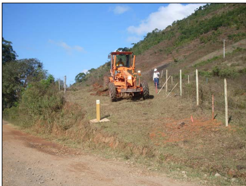
FOTO 6.2-98: Abertura de pista no km 142, coordenadas em UTM: N= 7.587.629/E= 655.264 (Fonte: Remma Construcap, out/09).
