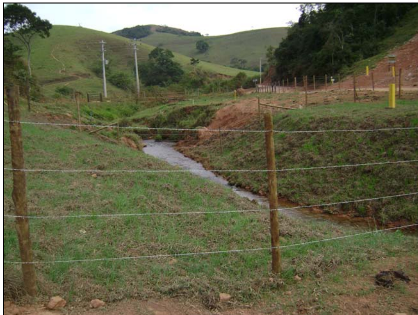
FOTO 6.3-83: Recuperação de curso d'água – recomposição vegetal no km 109+600, coordenadas em UTM N= 7.556.141/E= 656.786 (Fonte: Lenc, mai/10).
