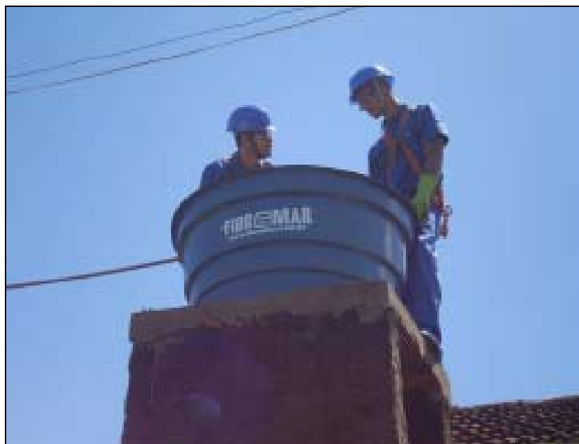
FOTO 6.1.1-90: Limpeza, higienização e desinfecção das caixas d'água, coordenadas em UTM N=7.519.877/E=627.938 (Fonte: Remma Azevedo & Travassos, fev/10).
