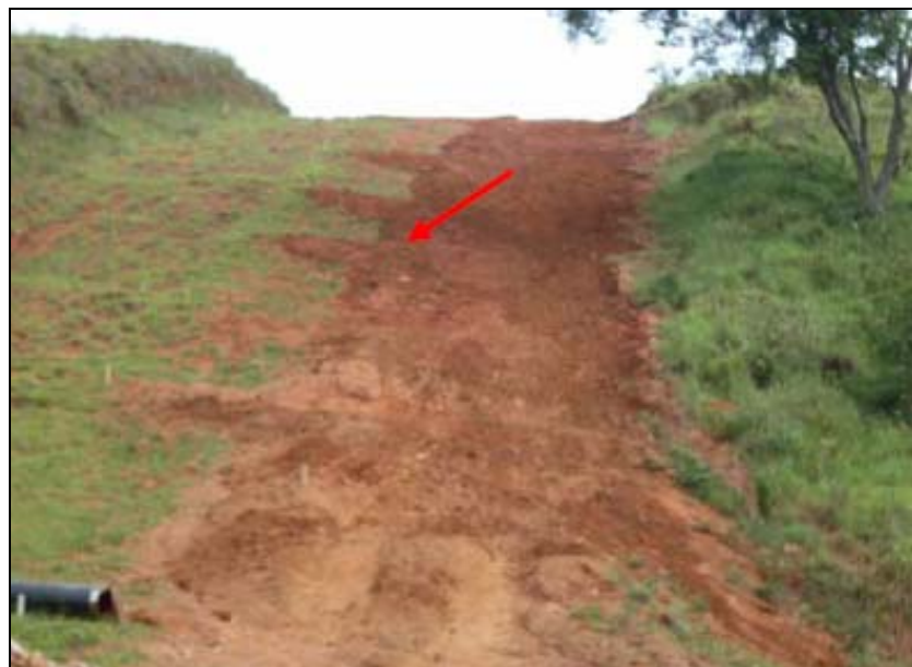
FOTO 6.2-113: Sistema de drenagem provisória (leiras transversais) no km 115+800, coordenadas em UTM: N= 7.561.780 /E= 655.335 (Fonte: Remma – Construcap, jan/10).
