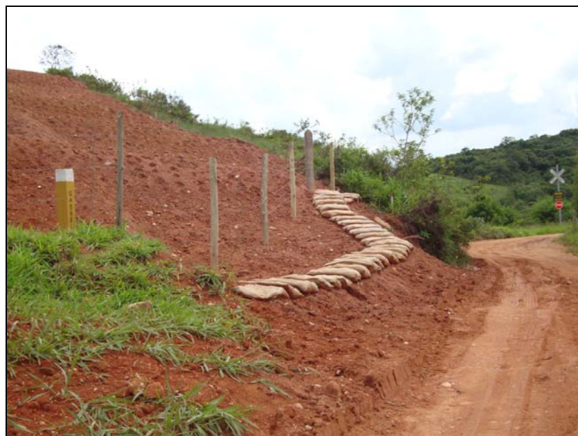
FOTO 6.2-33: Contenção de sedimentos junto à estrada de acesso, com sacos de rafia (solo-solo) no km 256+270, coordenadas em UTM N= 7.683.632 / E= 621.812 (Fonte: Lenc, jan/10).
