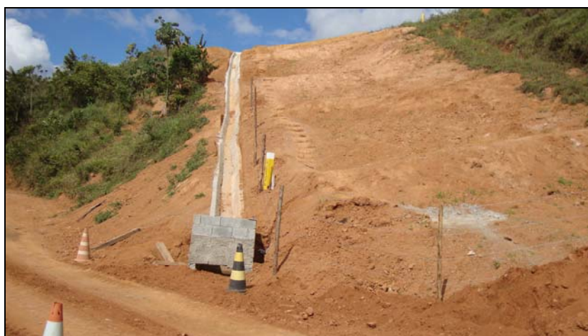
FOTO 6.3-36: Dispositivo definitivo de drenagem, canaletas de direcionamento de água na faixa de servidão no km 136, coordenadas em UTM N= 7.581.613/E= 656.161 (Fonte: Lenc, mai/10).
