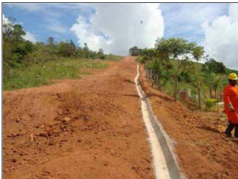
FOTO 6.3-13: Canaletas definitivas de direcionamento de águas pluviais no km 245, coordenadas em UTM N= 7.673.094 /E= 624.429 (Fonte: Remma - Egesa, nov/09).
