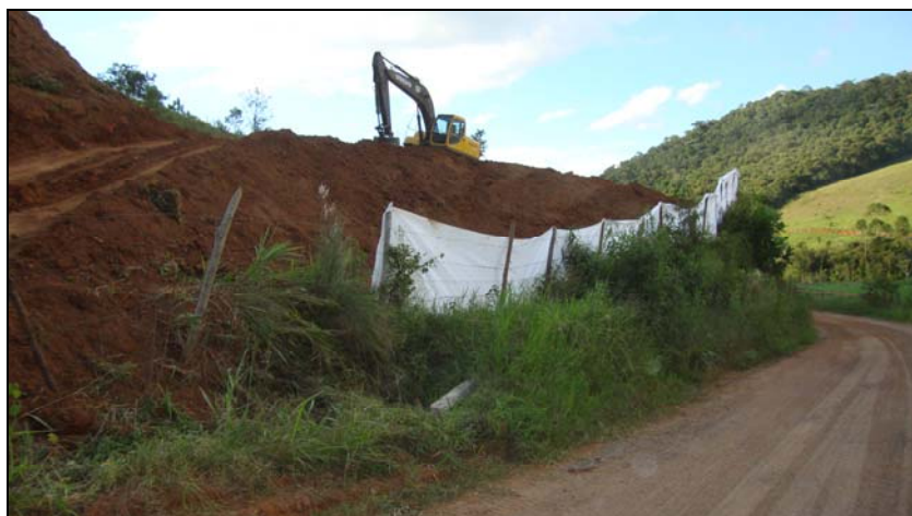
FOTO 6.2-41: Barreira de proteção para evitar o carreamento de sedimentos sólidos para a estrada de acesso, no km 142, coordenadas em UTM N= 7.588.122/E= 655.393 (Fonte: Lenc, mar/10).
