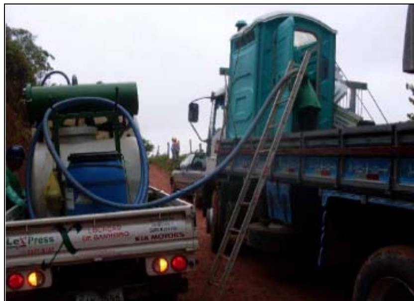
FOTO 6.4.4-6: Limpeza de banheiro químico no km 162, coordenadas em UTM N=7.624.686/E=647.697(Fonte: Remma – Construcap, nov/09).
