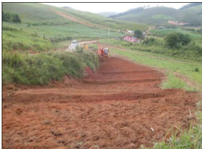
FOTO 6.1.2-31: Área designada para bota-fora (32), durante atividades de recuperação da área, coordenadas em UTM N=7.629.549/E=648.424 (Fonte: Construcap, mar/10).
