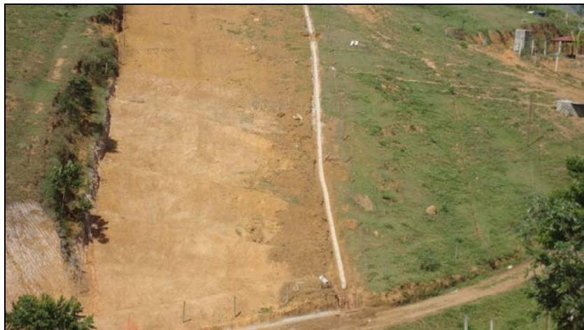
FOTO 6.3-37: Dispositivo definitivo de drenagem, canaletas de direcionamento de água na faixa de servidão no km 136, coordenadas em UTM N= 7.581.613/E= 656.161 (Fonte: Lenc, mai/10).
