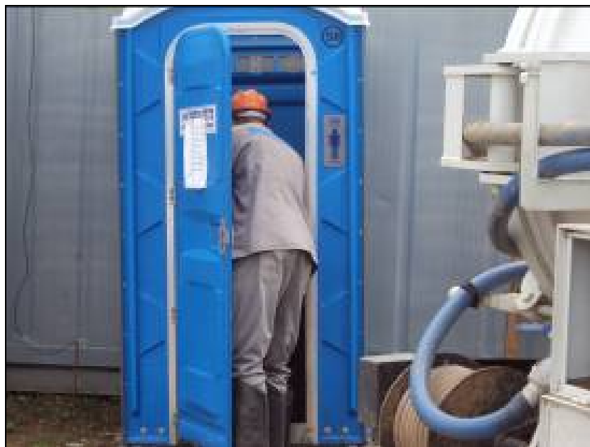
FOTO 6.4.4-2: Controle de efluente (limpeza de fossa) no canteiro de Itakamosy/RJ, coordenadas em UTM N= 7.519.877/E= 627.938( Fonte: Remma – Azevedo Travassos, out/09).
