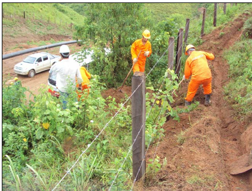
FOTO 6.2-9: Construção de canaleta na crista do talude no km 46, coordenadas em UTM N= 7.521.613/E= 635.041 (Fonte: Remma - Azevedo Travassos, jan/10).
