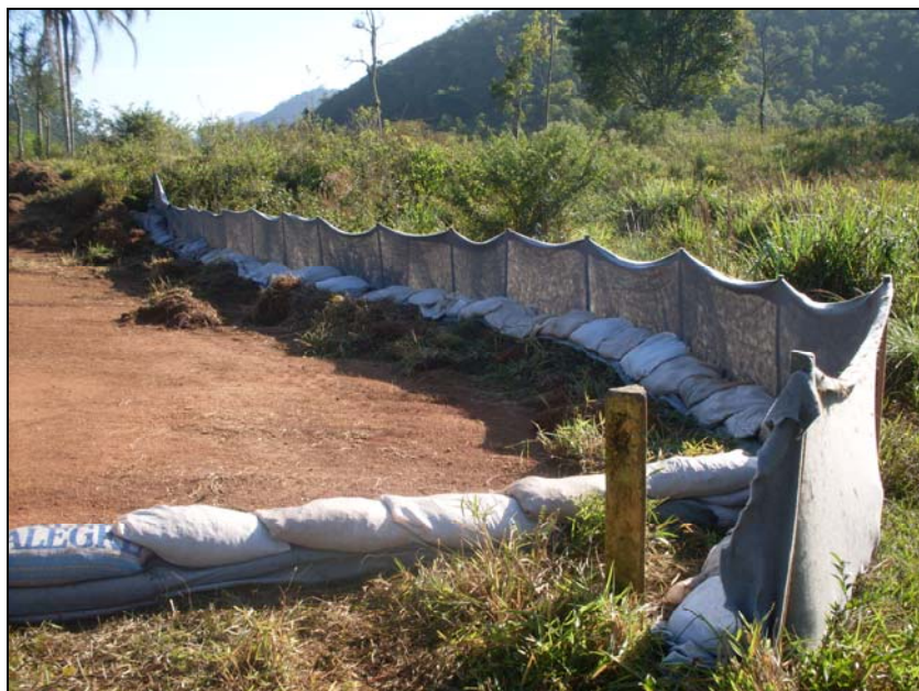
FOTO 6.2-19: Barreiras de bidim para evitar carreamento de sedimentos sólidos para fora da faixa de servidão no km 141, coordenadas em UTM N= 7.585.728/E= 655.493 (Fonte: Remma Construcap, out/09).
