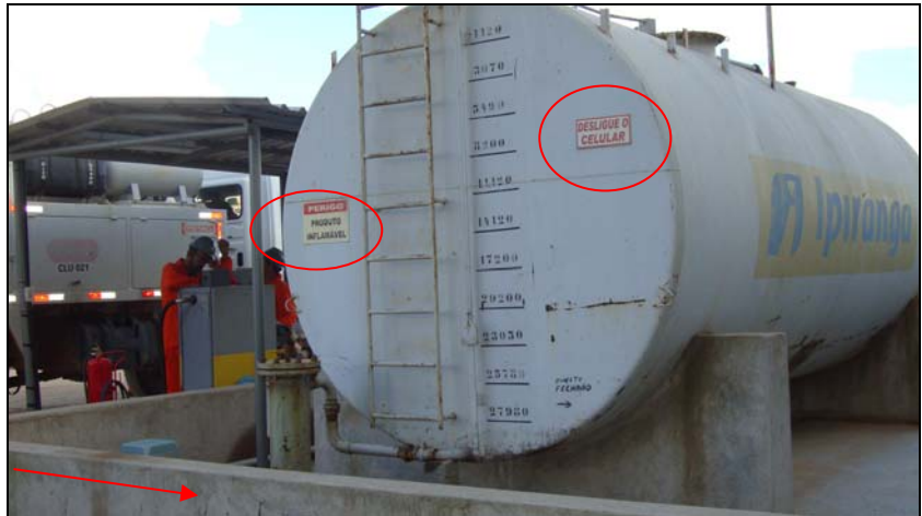
FOTO 6.1.1-18: Tanque de abastecimento de veículos, com bacia de contenção contra vazamentos (seta) e placas de alerta (círculos), coordenadas em UTM N=7.688.225/E=621.993 (Fonte: Lenc, mar/10).
