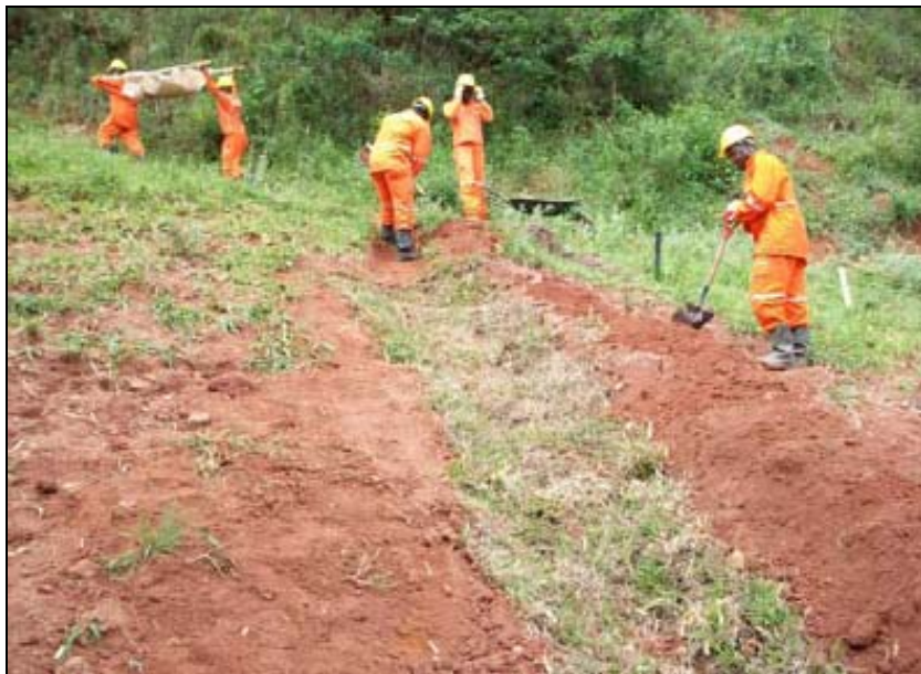
FOTO 6.3-18: Dispositivo de drenagem definitivo – canaleta tipo CT-C com revestimento vegetal, no km 101, coordenadas em UTM N= 7.547.730 /E= 658.291 (Fonte: Azevedo - Travassos, jan/10).
