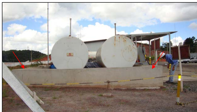
FOTO 6.1.1-26: Vista dos tanques de armazenamento de combustíveis. Destaque p/ bacia de contenção p/ possíveis vazamentos (setas), coordenadas em UTM N=7.652.927/E=630.639 (Fonte: Lenc, mar/10).
