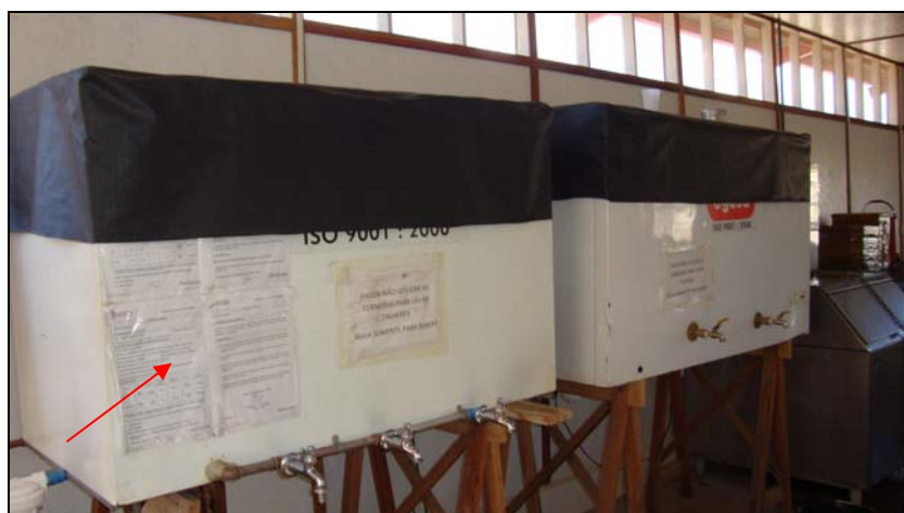
FOTO 6.1.1-12: Bebedouro dentro do refeitório do Canteiro de Carandá; no detalhe, as análises que indicam a potabilidade da água, coordenadas em UTM N=7.688.225/E=621.993 (Fonte: Lenc, mar/10).
