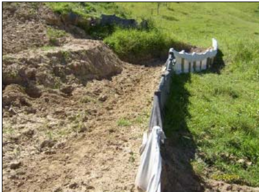
FOTO 6.2-37: Barreiras de contenção com manta geotêxtil para evitar o carreamento de sedimentos sólidos, no km 07+3,00, coordenadas em UTM N= 7.506.352/ E= 605.038 (Fonte: Remma – Azevedo Travassos, fev/10).
