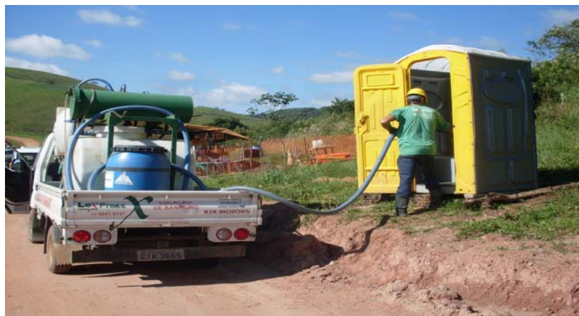
FOTO 6.4.4-19: Limpeza de banheiro químico localizado na faixa de servidão no km 158, coordenadas em UTM N= 7.601.460/E= 655.610(Fonte: Remma- Construcap, jan/10).
