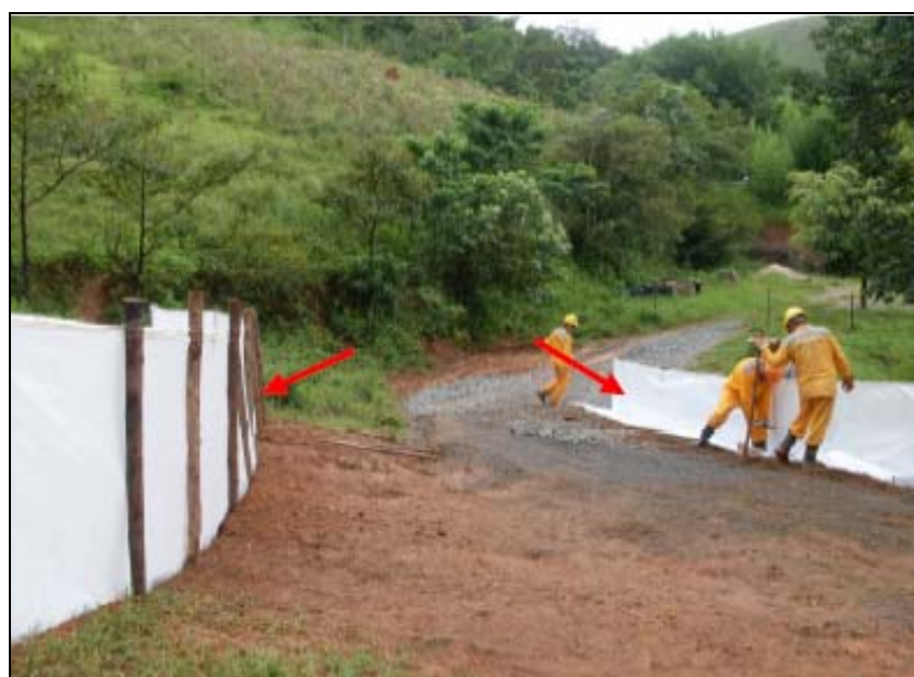
FOTO 6.2-47: Manutenção de barreira de contenção para conter carreamento de sedimentos sólidos aos acessos à faixa de servidão, no km 170, coordenadas em UTM N= 7.612.269/E= 653.447(fonte: Remma - Construcap, mar/10).
