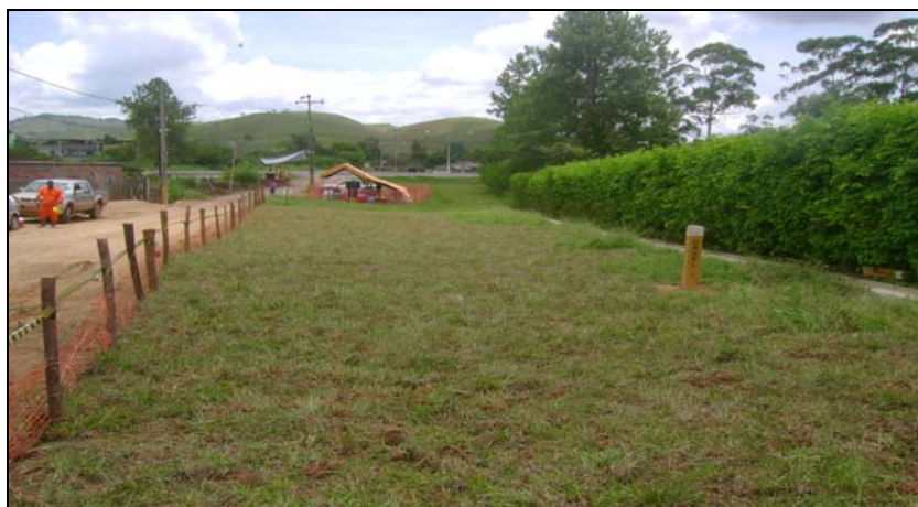
FOTO 6.3-51: Recomposição realizada com grama em placas para proteção da faixa no km 153+960, próximo a comunidade de Igrejinha, coordenadas em UTM N= 7.597.687/E= 655.916 (Fonte: Remma – Construcap, jan/10).
