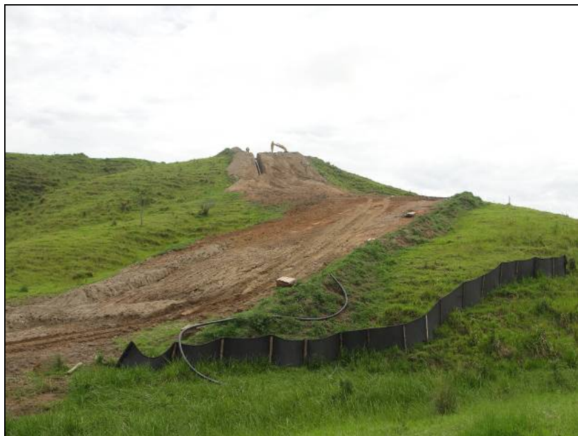
FOTO 6.2-22: Instalação de barreiras com manta geotêxtil visando evitar carreamento de sedimentos sólidos para APP, no km 15, coordenadas em UTM N= 7.508.699 /E= 611.922 (Fonte: Remma – Azevedo Travassos, dez/09).
