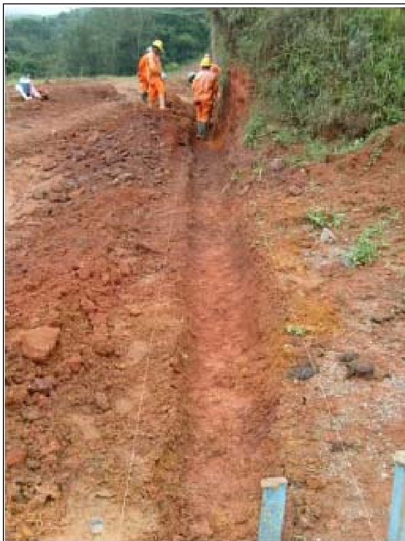
FOTO 6.3-32: Preparação do terreno para construção de canaletas no km 197, coordenadas em UTM N= 7.636.507/E= 648.149 (Fonte: Remma - Egesa, mar/10).
