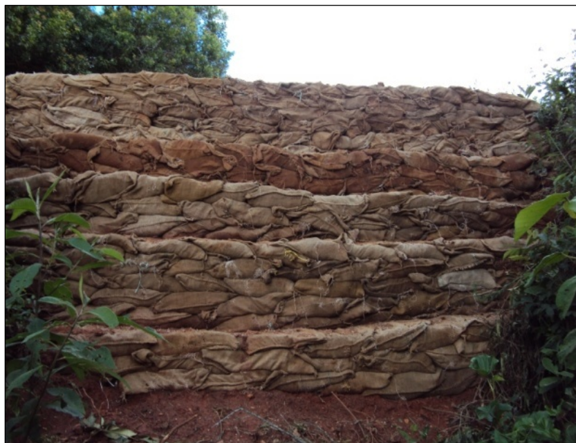
FOTO 6.2-26: Construção de escada hidráulica com sacaria e sementeira a lanço, para conter processo erosivo no km 233+960, coordenadas em UTM N= 7.662.942 /E= 628.404 (Fonte: Remma – Egesa, dez/09)
