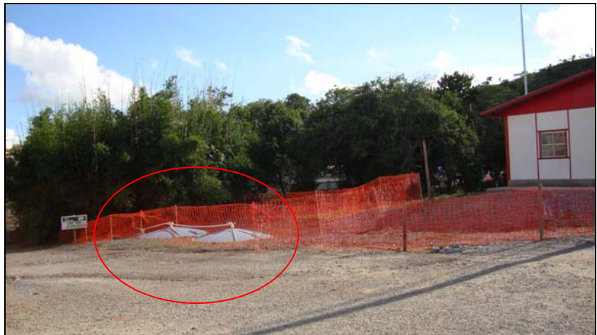
FOTO 6.1.1-14: Fossa séptica, ao fundo área verde, coordenadas em UTM N=7.688.225/E=621.993 (Fonte: Lenc, mar/10).
