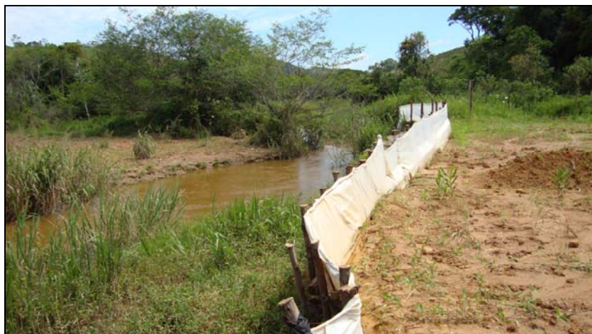
FOTO 6.2-67: Barreira de contenção de sedimentos sólidos e proteção do curso d'água, no km 140+670, coordenadas em UTM N= 7.585.476/ E= 656.618 (Foto: Lenc, jan/10).
