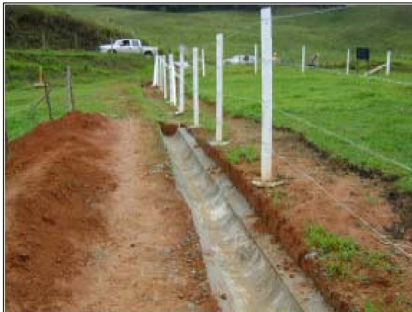
FOTO 6.3-12: Implantação de sistema de drenagem definitivo (canaletas de direcionamento de águas pluviais) no km 192, coordenadas em UTM N= 7.631.367= /E= 648.379 (Fonte: Remma - Construcap, nov/09).
