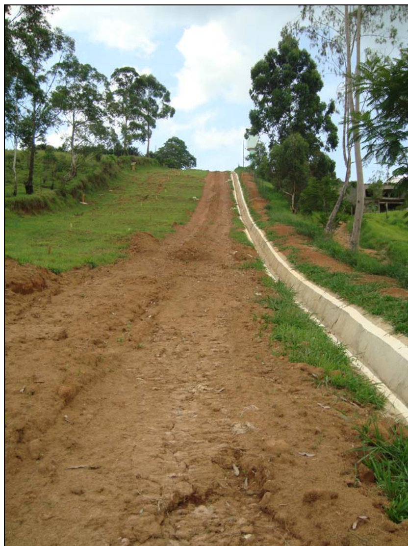
FOTO 6.3-26: Sistema de drenagem definitivo (canaleta de direcionamento de águas pluviais) no km 154+670, coordenadas em UTM N= 7.598.525/E= 656.191 (Fonte: Lenc, dez/09).
