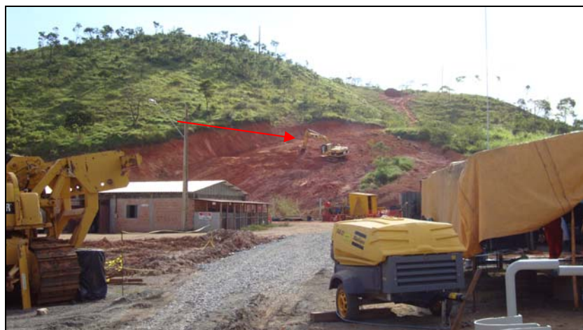
FOTO 6.1.1-19: Máquinas trabalhando na recuperação da voçoroca, coordenadas em UTM N=7.688.225/E=621.993 (Fonte: Lenc, mar/10).
