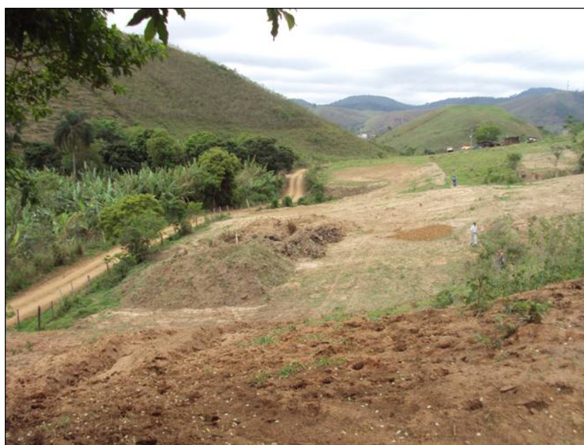
FOTO 6.1.2-17: Área designada para bota-fora (20), em utilização, coordenadas em UTM N=7.521.889/E=635.927(Fonte: Remma Azevedo&Travassos, mar/10).
