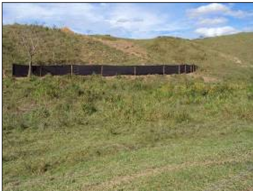
FOTO 6.2-16: Contenção de sedimentos sólidos com manta geotêxtil no km 16, coordenadas em UTM N= 7.509.284/E= 612.646 (Fonte: Remma Azevedo Travassos, ago/09).
