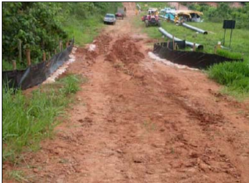
FOTO 6.2-92: Estiva para passagem de máquinas e equipamentos, no km 162+380, coordenadas em UTM: N= 7.605.537 /E= 655.491 (Fonte: Remma – Construcap, dez/09).
