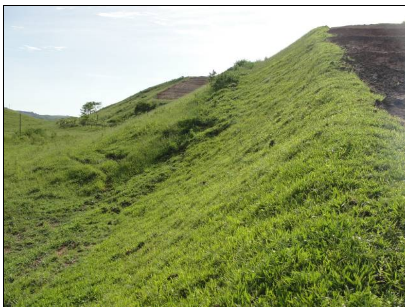
FOTO 6.2-6: Saia de aterro recomposta com grama em placas, no km 7, coordenadas em UTM N= 7.506.302 /E= 604.743 (Fonte: Remma - Azevedo Travassos, dez/09).
