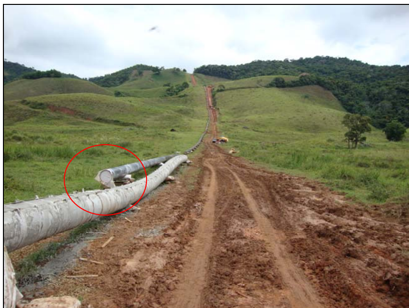
FOTO 6.1.2-43: Tampão na extremidade do tubo após soldagem da coluna, coordenadas em UTM N= 7.571.360/E=656.245 (Fonte: Lenc, fev/10).
