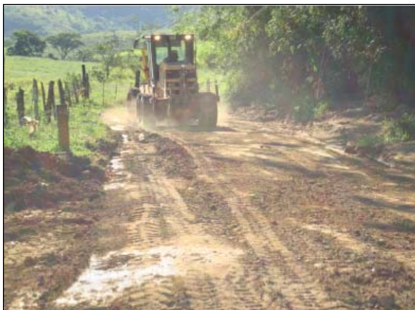
FOTO 6.3-98: Melhoria do acesso ao km 120 da faixa de servidão, coordenadas em UTM N= 7.565.854/E= 655.122 (Fonte: Remma – Construcap, fev/10).
