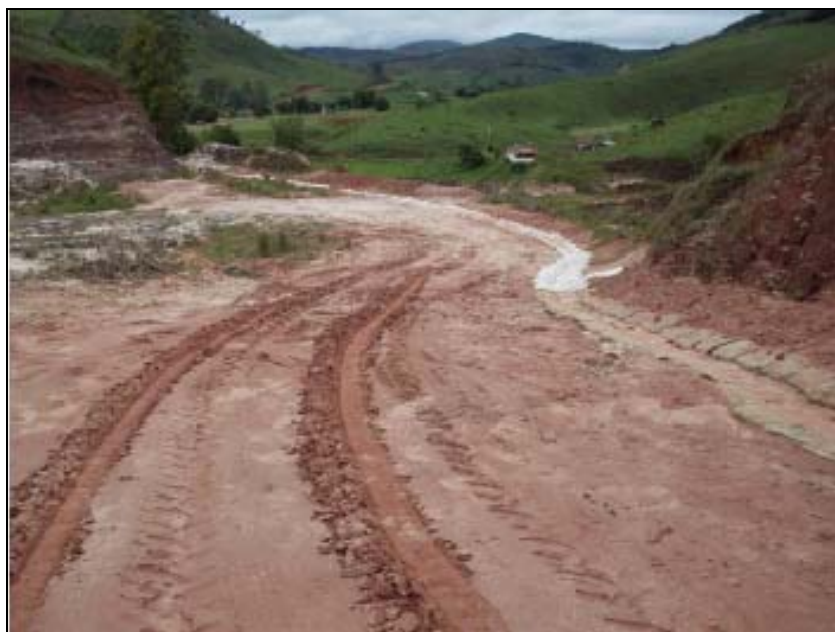
FOTO 6.3-120: Instalação de sacaria para direcionamento de águas pluviais no bota-fora de Humaitá no 148+500, no município de Juiz de Fora-MG, coordenadas em UTM N= 7.592.618/E= 655.032 (Fonte: Remma Construcap, nov/09).
