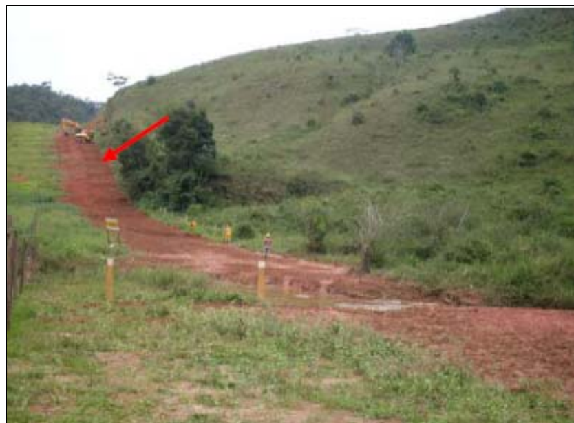
FOTO 6.2-115: Limpeza da faixa e sistema de drenagem provisória (leiras transversais) no km 143+080, coordenadas em UTM: N= 7.587.780 /E= 655.320 (Fonte: Remma – Construcap, jan/10).
