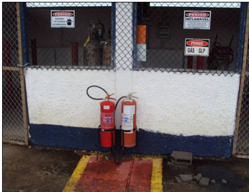
FOTO 6.4.3-14: Acondicionamento de resíduos inflamáveis, canteiro central Pinheiral - RJ, coordenadas em UTM N= 7.512.069/E= 601.305 ( Fonte: Remma – Azevedo Travassos, dez/09).
