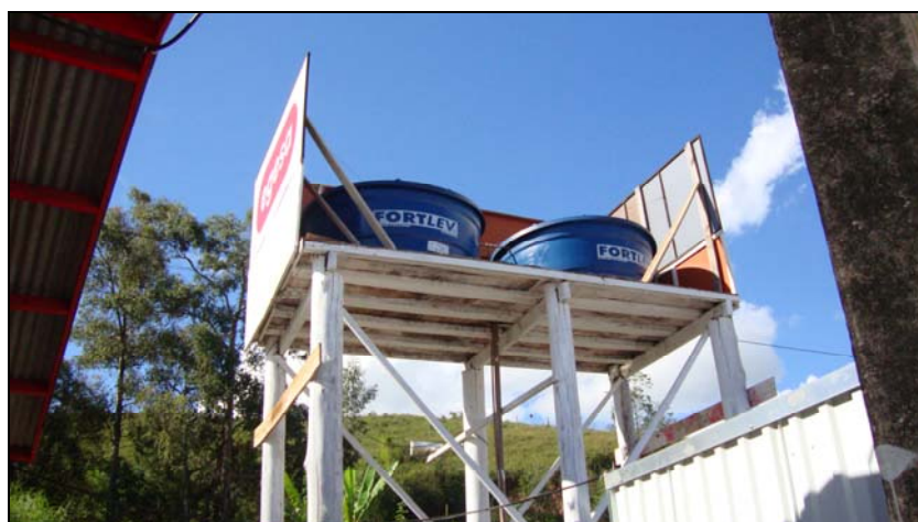
FOTO 6.1.1-11: Caixas d'água localizadas no Canteiro Central de Carandá, coordenadas em UTM N=7.683.285/E=624.859 (Fonte: Lenc, mar/2010).
