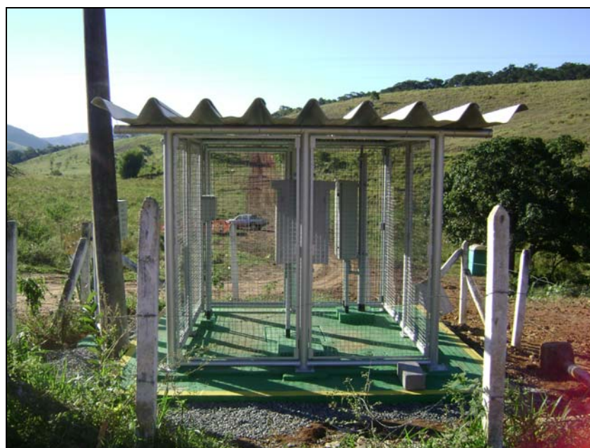
FOTO 6.1.2-64: Ponto de teste eletrolítico, km 119, coordenadas em UTM N= 7.564.906/ E=655.186 (Fonte: Lenc, maio/10).
