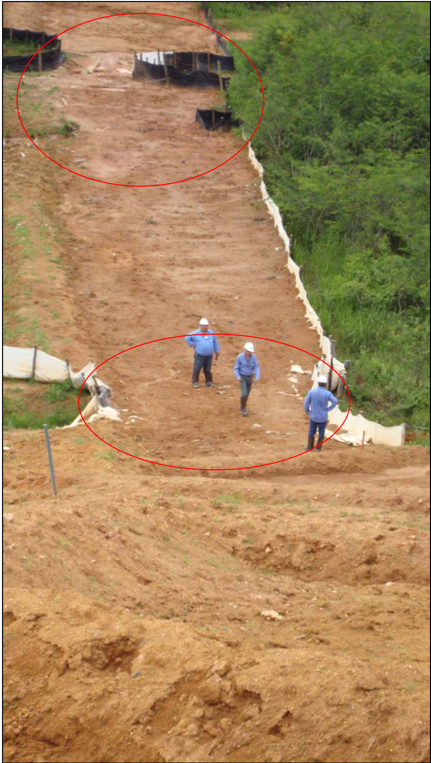
FOTO6.1.2-5 : Raspagem do solo superficial apenas na largura correspondente ao percurso da vala (círculos), em terras cultivadas ou úmidas, km 132, coordenadas em UTM N= 7.586.385/E=655.529 (Fonte: Lenc, jan/10).
