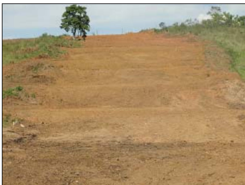
FOTO 6.3-15: Dispositivo de drenagem definitivo (leiras) no km 12, coordenadas em UTM N= 7.507.865 /E= 609.263 (Fonte: Remma - Azevedo Travassos, jan/10).
