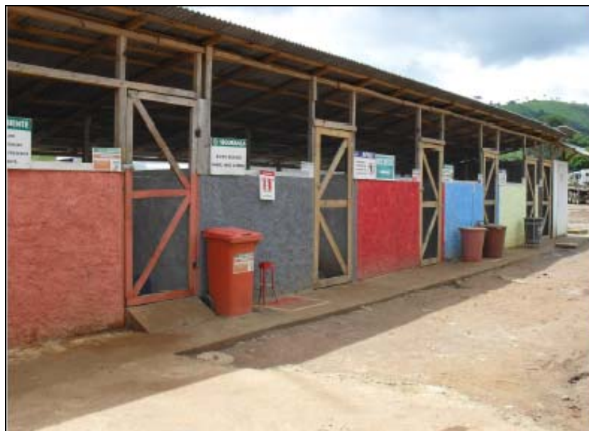
FOTO 6.4.3-35: Baías de acondicionamento de resíduos, canteiro operacional de Juiz de Fora/MG, coordenadas em UTM N= 7.597.871/E= 661.013 (Fonte: Remma – Construcap, fev/10).
