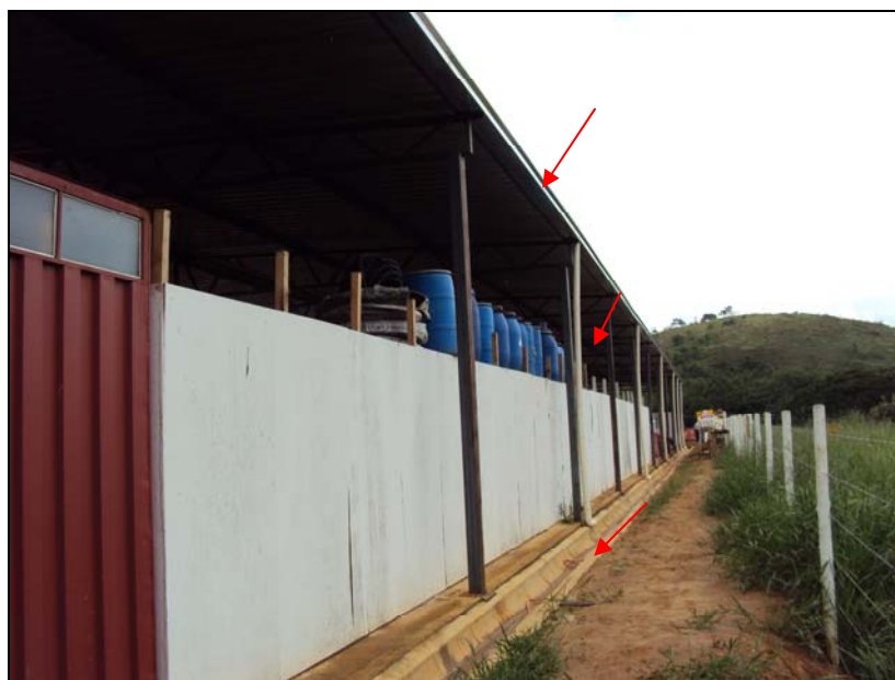
FOTO 6.1.1-65: Sistema de captação de águas pluviais, coordenadas em UTM N=7.556.706/E=648.650 (Fonte: Lenc, abr/10).
