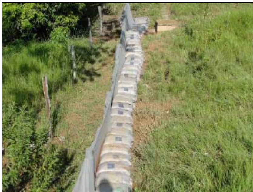
FOTO 6.2-38: Barreiras de contenção com manta geotêxtil para evitar o carreamento de sedimentos sólidos, no km 04+8,00, coordenadas em UTM N= 7.507.348/ E= 602.836 (Fonte: Remma – Azevedo Travassos, fev/10).
