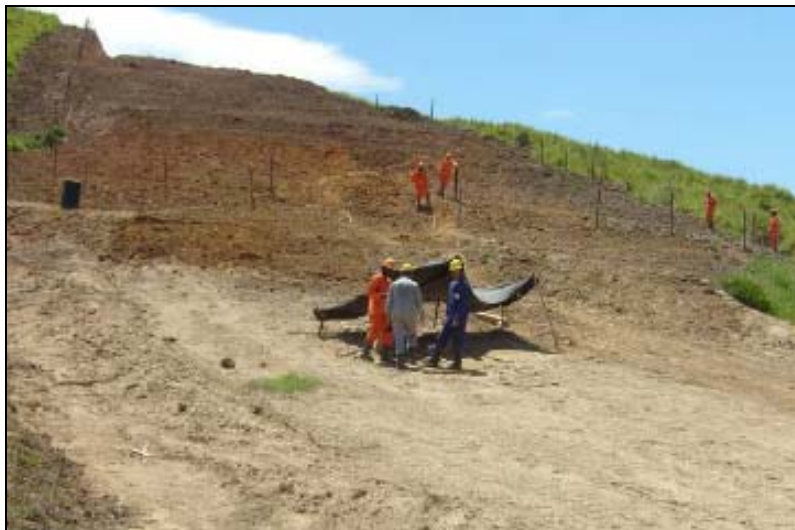
FOTO 6.3-16: Dispositivo de drenagem definitivo (leiras) no km 16+080, coordenadas em UTM N= 7.509.360 /E= 612.743 (Fonte: Remma - Azevedo Travassos, fev/10).
