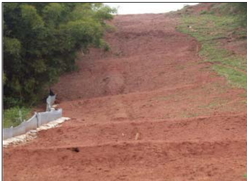
FOTO 6.2-104: Sistema de drenagem provisória (leiras transversais) no km 101, coordenadas em UTM: N= 7.547.730/E= 658.291(Fonte: Remma Construcap, nov/09).
