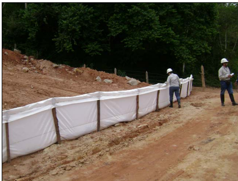
FOTO 6.2-30: Barreira de contenção de sedimentos sólidos no km 109, coordenadas em UTM N= 7.556.184/ E= 656.718 (Foto: Lenc, jan/10).
