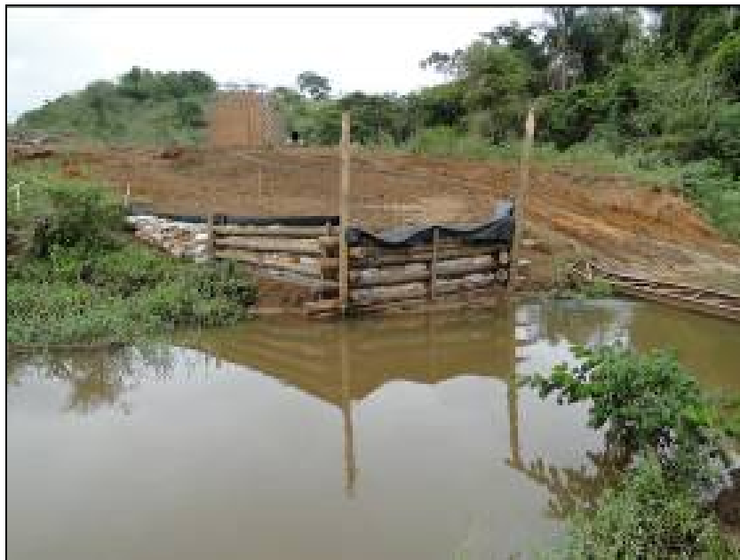
FOTO 6.2-56: Estrutura de proteção de curso d'água no km 64, coordenadas em UTM N= 7.530.376/E= 649.561 (Fonte: Remma Azevedo Travassos, out/09).
