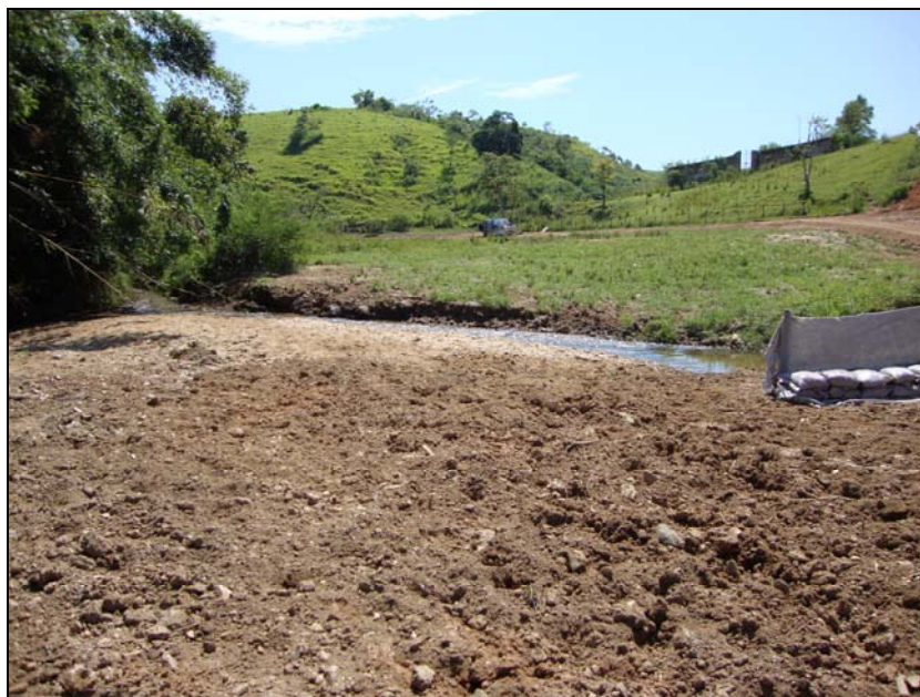
FOTO 6.3-58: Faixa de servidão em fase de recomposição da vegetação no km 9, coordenadas em UTM N= 7.507.196/E= 607.040 (Fonte: Lenc, fev/10).
