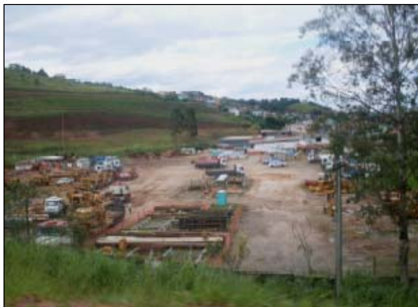
FOTO 6.1.1-44: Vista panorâmica do canteiro Operacional de Juiz de Fora, coordenadas em UTM N=7.597.952/E=661.072 (Fonte: Remma Construcap, mar/10).
