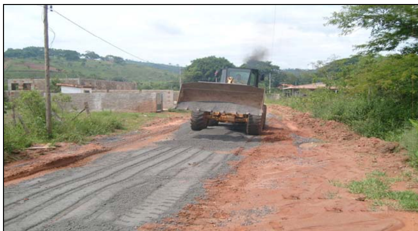
FOTO 46.3-92: Melhoria do acesso ao km 167 da faixa de servidão, coordenadas em UTM N= 7.609.700/E= 654.650 (Fonte: Remma – Construcap, dez/09).
