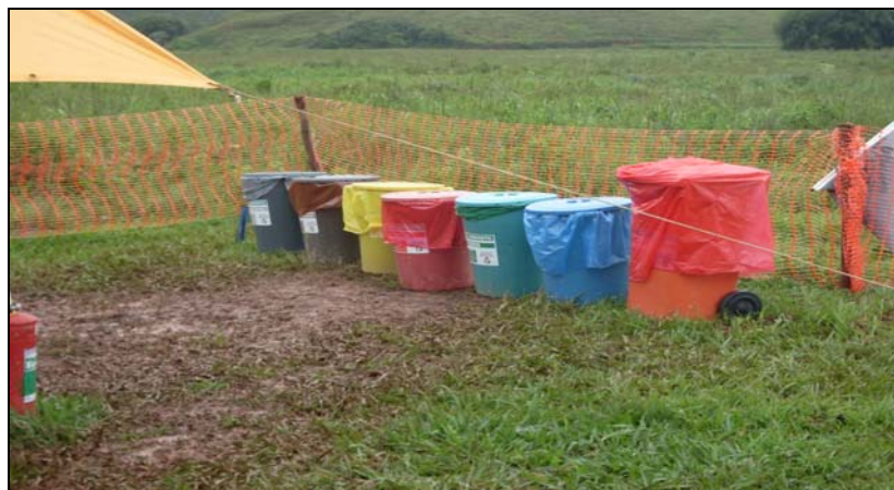
FOTO 6.4.3-29: Kit de coleta seletiva na área de vivência no km 169, coordenadas em UTM N= 7.611.542/ E= 654.082 (Fonte: Remma - Construcap, dez/09).
