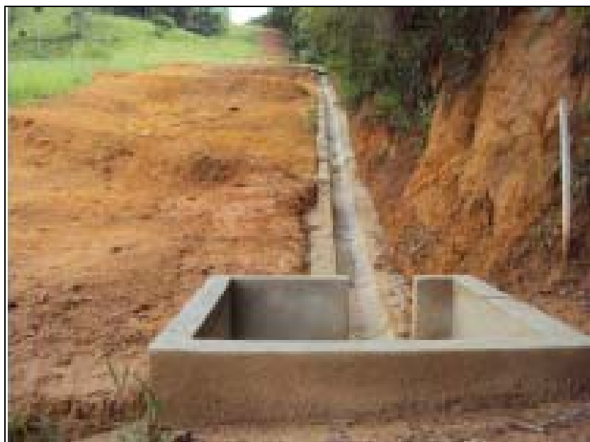
FOTO 6.3-28: Dispositivo definitivo de drenagem pluvial no km 203+400, coordenadas em UTM N= 7.639.198/E= 646.288 (Fonte: Remma - Egesa, jan/10).
