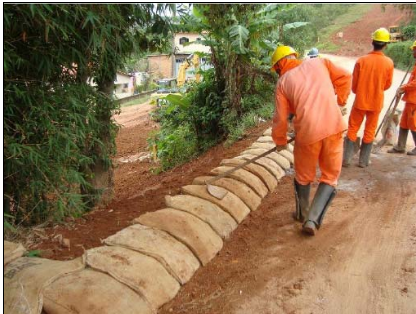
FOTO 6.2-27: Contenção com sacos de aniagem com solo-cimento, próximo ao km 255+425, coordenadas em UTM N= 7.682.866 /E= 621.806 (Fonte: Remma - Egesa, dez/09).
