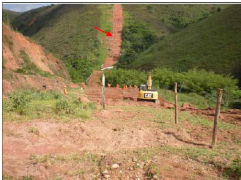
FOTO 6.3-17: Dispositivo de drenagem definitivo (leiras) no km 101, coordenadas em UTM N= 7.547.730 /E= 658.291 (Fonte: Remma - Construcap, dez/09).
