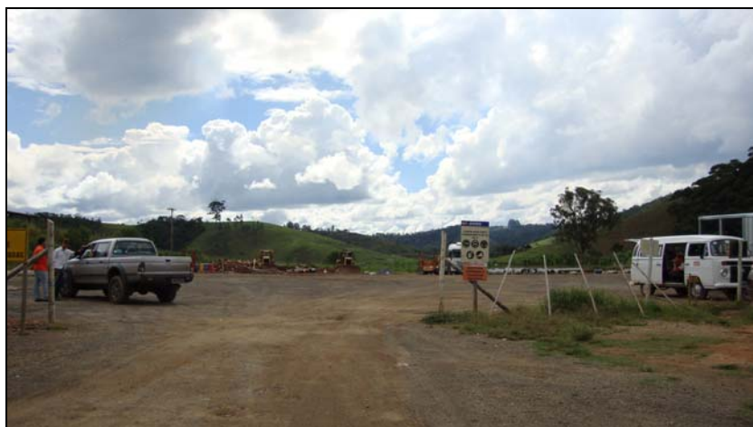
FOTO 6.1.1-35: Vista da entrada do canteiro de Santos Dumont/MG em abril de 2010, com as instalações da montadora Egesa, coordenadas em UTM N=7.628.775/E=649.474 (Fonte: Lenc, abr/10).
