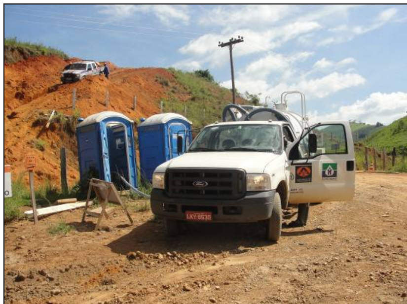
FOTO 6.4.4-14: Recolhimento de efluentes e limpeza de banheiros químicos localizados na frente de obra do km 82, coordenadas em UTM N= 7.542.219/E= 658.271 (Fonte: Remma – Azevedo Travassos, jan/10).
