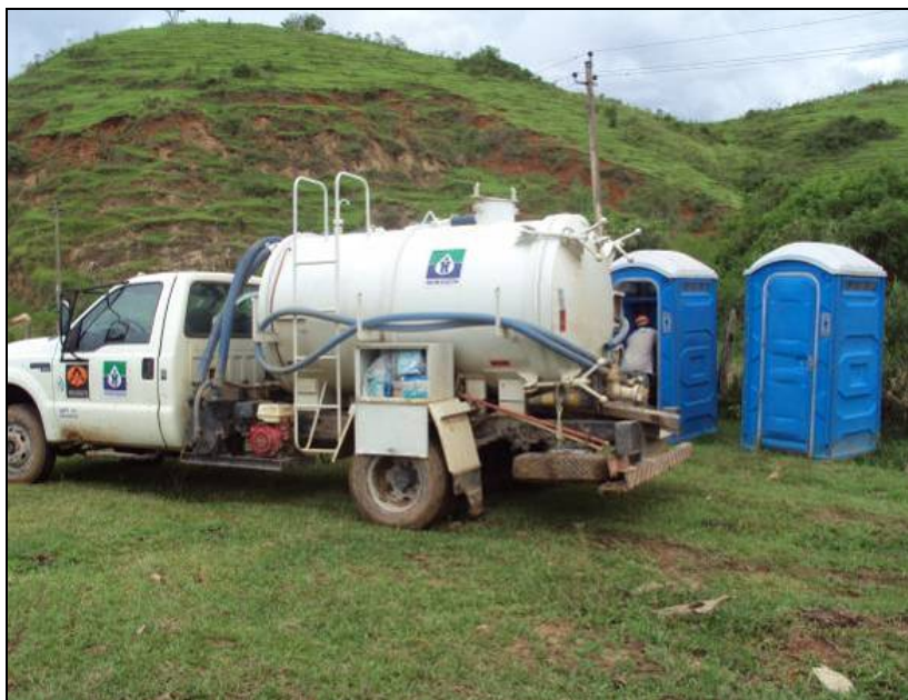
FOTO 6.4.4-9: Recolhimento de efluentes e limpeza de banheiros químicos localizados na frente de obra do km 26+640, coordenadas em UTM N= 7.510.294/E= 621.525 (Fonte: Remma – Azevedo Travassos, dez/09).
