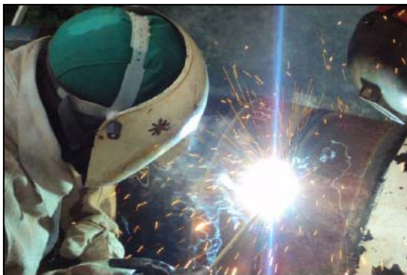
FOTO 6.1.2-41: Atividade de solda, coordenadas em UTM N=7.545.961/ E=658.765 (Fonte: Remma Azevedo & Travassos, jan/10).
