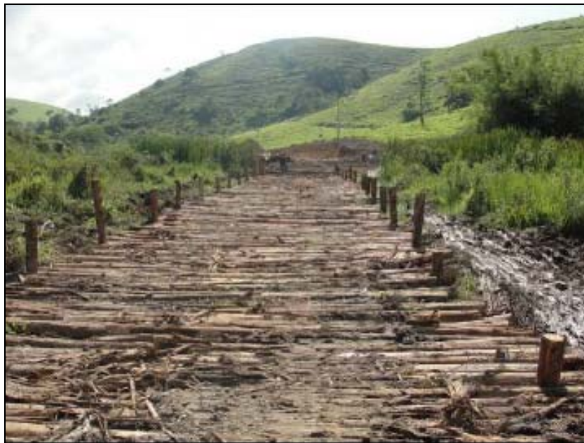
FOTO 6.2-88: Construção de estiva para passagem de máquinas e equipamentos, no km 64, coordenadas em UTM: N= 7.529.860 /E= 649.162 (Fonte: Remma – Azevedo Travassos, dez/09).
