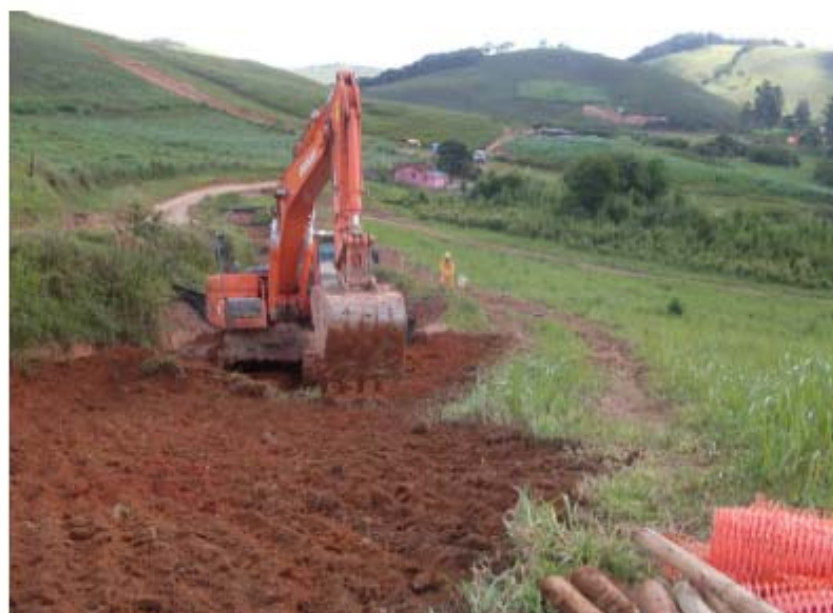
FOTO 6.3-122: Início das atividades de recuperação da área utilizada como bota-fora em Santos Dumont - MG, coordenadas em UTM N= 7.629.549/E= 648.424 (Fonte: Remma - Construcap, mar/10).
