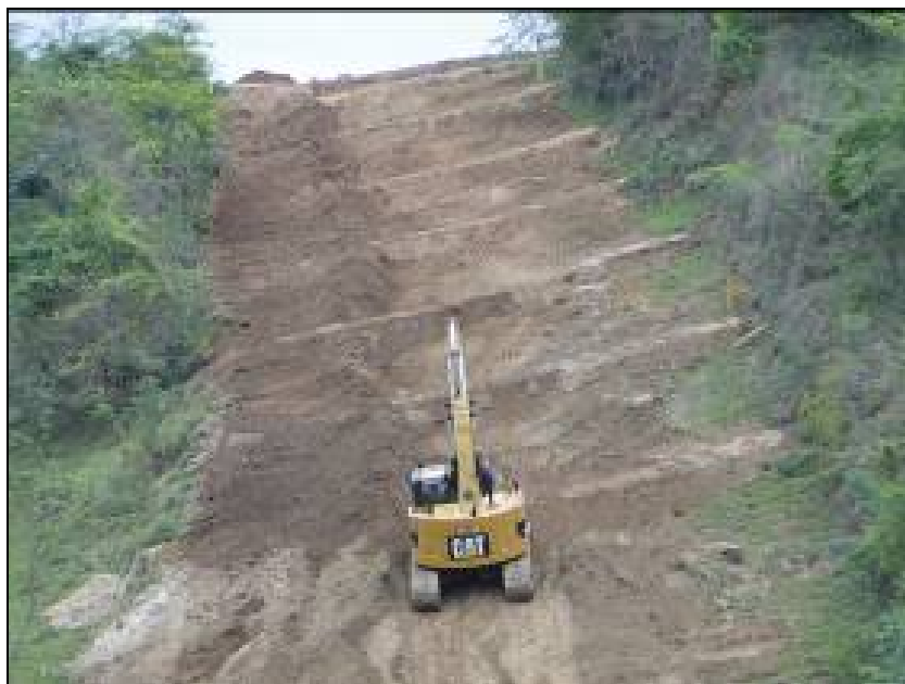
FOTO 6.2-103: Construção de leiras transversais (dispositivo de drenagem provisória) no km 81, coordenadas em UTM: N= 7.541.308/E= 657.872 (Fonte: Remma Azevedo Travassos, out/09).
