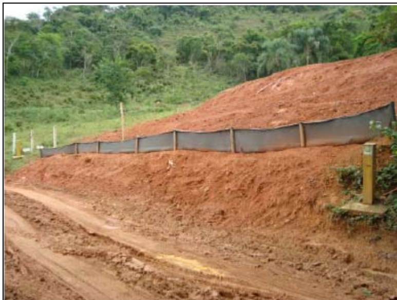
FOTO: 6.2-52: Barreiras de contenção no km 125+235, coordenadas em UTM N= 7.570.790/E= 656.483 (fonte: Remma – GDK, mar/10).
