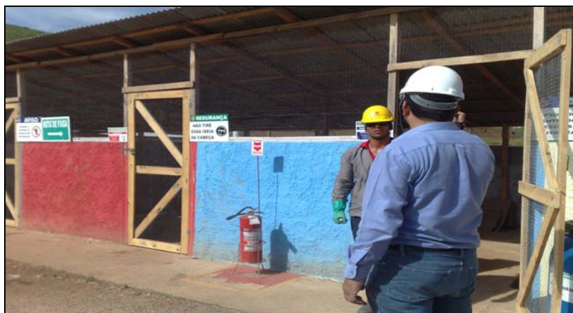
FOTO 6.4.3-19: Baía de acondicionamentos de resíduos, canteiro operacional de Juiz de Fora/MG, coordenadas em UTM N= 7.599.146/E= 661.818 (Fonte: Remma - Construcap, dez/09).
