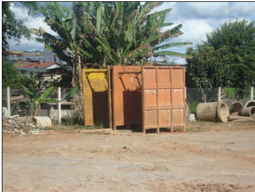
FOTO 7.1.7.2-3: Equipamentos de proteção coletiva utilizados para escoramento de vala, coordenadas em UTM: N= 7.683.285/E= 624.859 (Fonte: LENC, mar/10).
