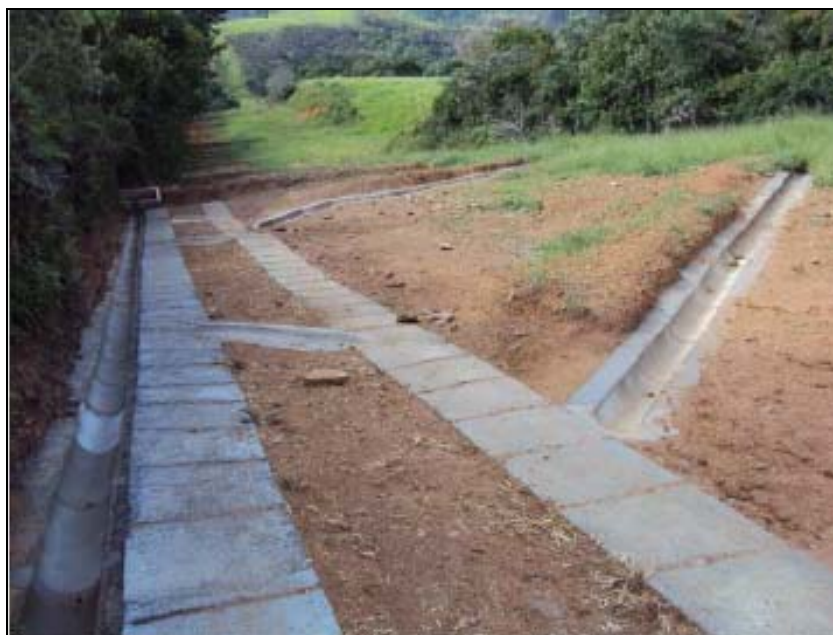
FOTO 6.3-29: Dispositivo definitivo de drenagem pluvial no km 203+605, coordenadas em UTM N= 7.639.577/E= 643.327 (Fonte: Remma - Egesa, jan/10).
