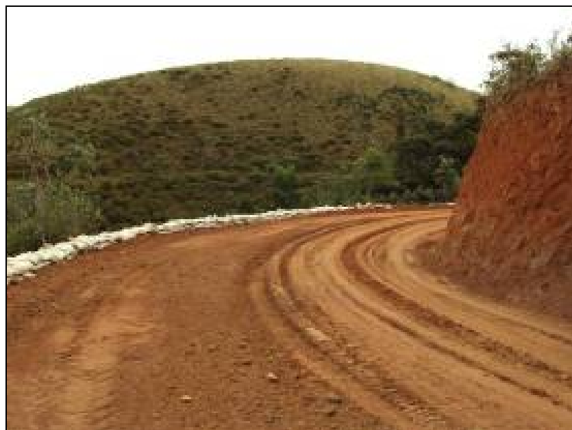
FOTO 6.3-83: Melhoria do acesso ao km 20, com nivelamento da pista e estabilização da borda com saco-solo, coordenadas em UTM N=7.510.072/E=615.615(Fonte: Remma Azevedo Travassos, ago/09).
