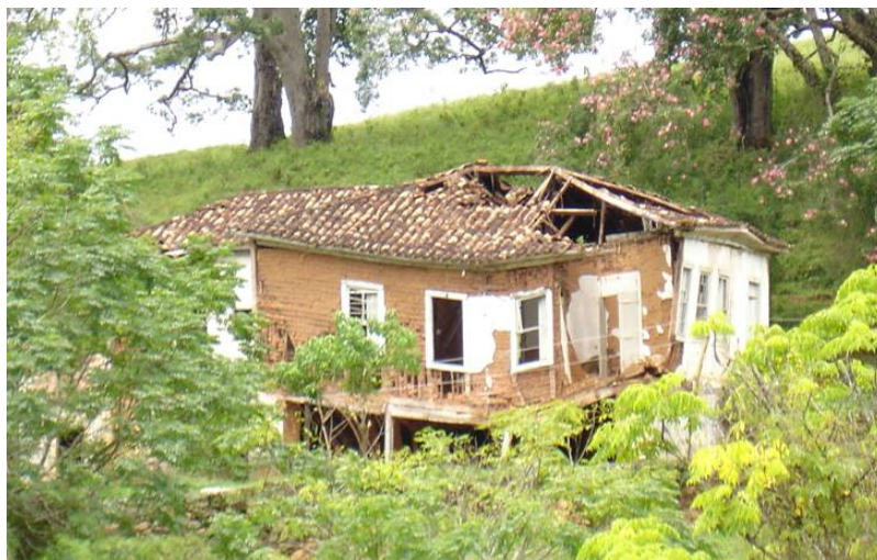
Foto 28 – Antiga sede da Fazenda do Porto (Bairro da Fartura), em estado de deterioração.
