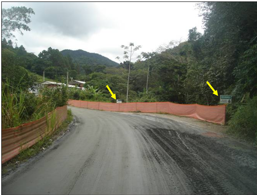
FOTO 2.6.17-7: Placa de sinalização e proteção de pista (Fonte: Remma GDK, mai/10).
