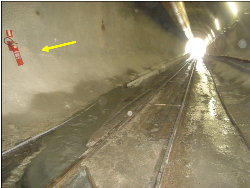
FOTO 2.6.17-3: Extintor localizado no interior do tunel (Fonte: Remma Schahin, fev/10).
