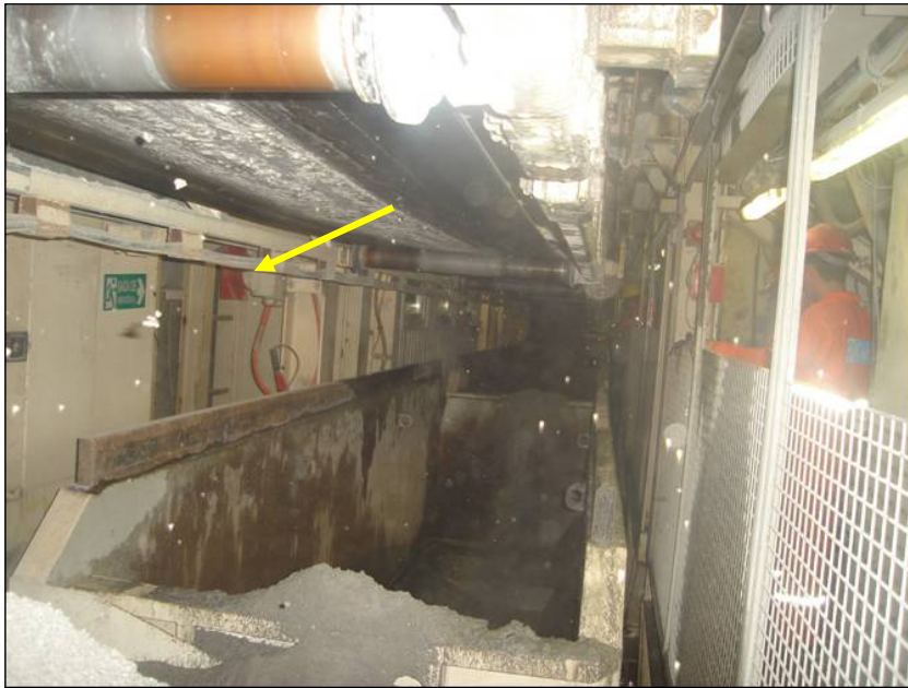
FOTO 2.6.17-6: Placa de sinalização dentro da tuneladora (Fonte: Remma Schahin, mai/10).
