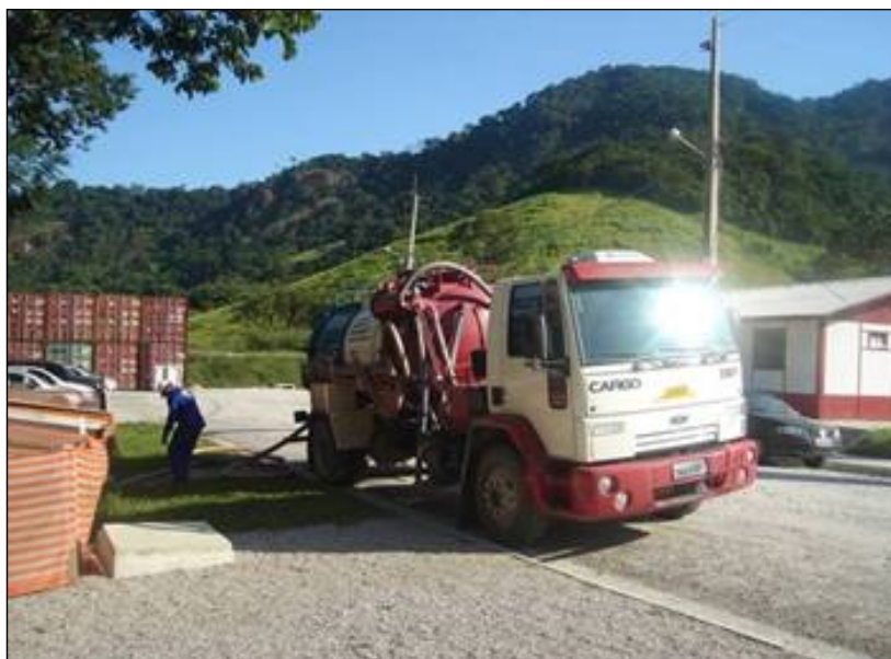
FOTO 2.6.14-33: Esgotamento de fossa séptica localizada no canteiro de obras da Schahin (Fonte: Remma Schahin, fev/10).
