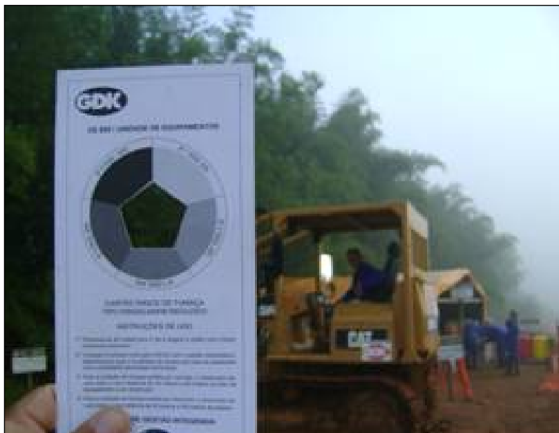
FOTO 2.6.14-48: Monitoramento de fumaça preta no km 77+160 (Fonte: Remma GDK, jan/10).
