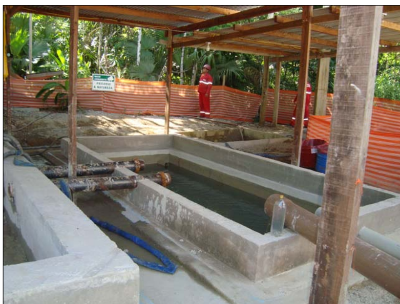
FOTO 2.6.14-36: Vista do leito de secagem do STAR instalado no canteiro de obras da Schahin (Fonte: Lenc, jan/10).
