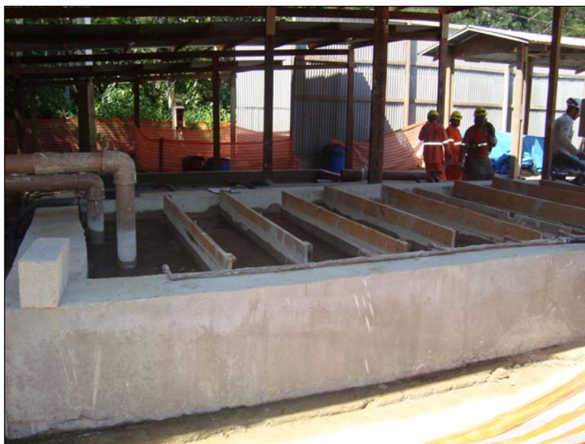
FOTO 2.6.14-35: Vista do tanque de floculação do STAR – Sistema de Tratamento de Águas Residuárias (Fonte: Lenc, jan/10).
