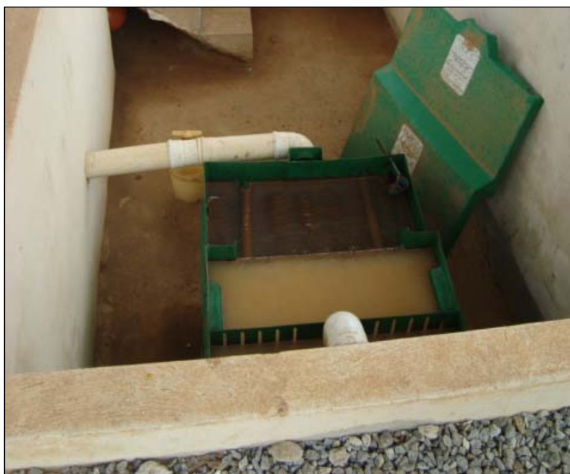
FOTO 2.6.14-34: Caixa separadora de água e óleo no Canteiro de obras do Consórcio Gastau (Fonte: Lenc, mar/10).
