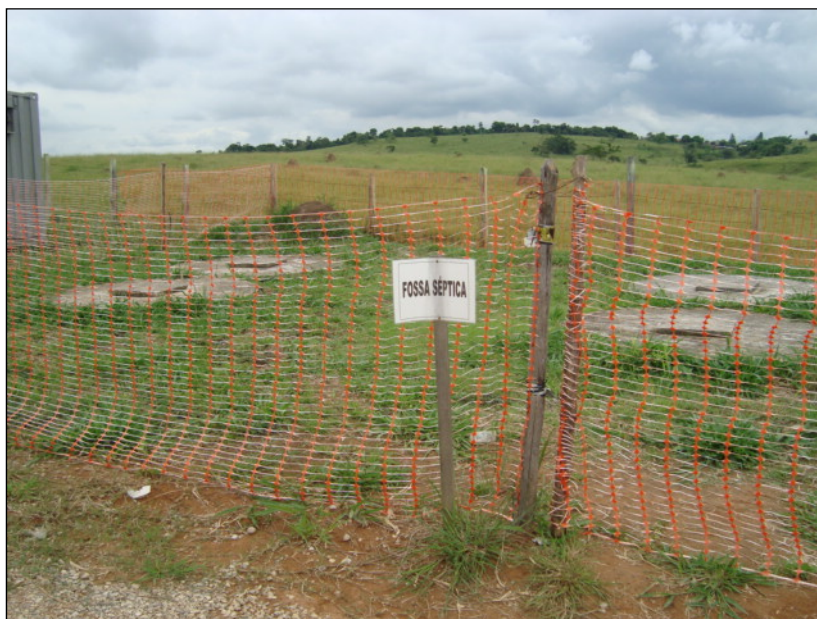
FOTO 2.6.14-31: Fossa séptica de armazenamento de efluentes localizada no canteiro de obras do Consórcio Gastau (Fonte: Lenc, mar/10).
