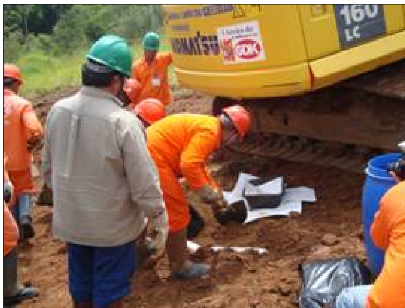
FOTO 2.6.14-5: Simulado sobre derramamento de óleo combustível no km 76+160 (Fonte: Remma GDK, jan/10).
