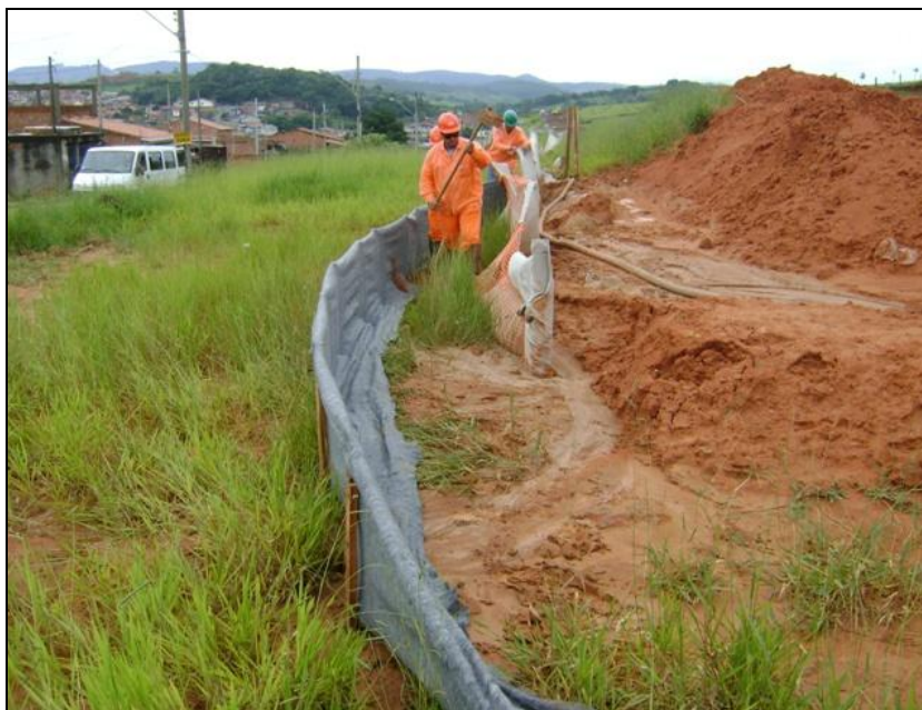
FOTO 2.6.12-21: Contensões de telas-filtro instaladas, para a proteção de carreamento de sedimentos, km 67+160 (Fonte: Remma GDK, jan/10).
