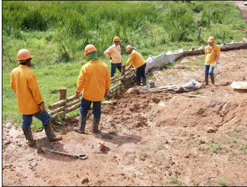
FOTO 2.6.12-69: Manutenção das contenções de sedimentos, executada pela equipe de monitoramento ambiental, km 38+100 (Fonte: Remma Consórcio Gastau, jan/10).
