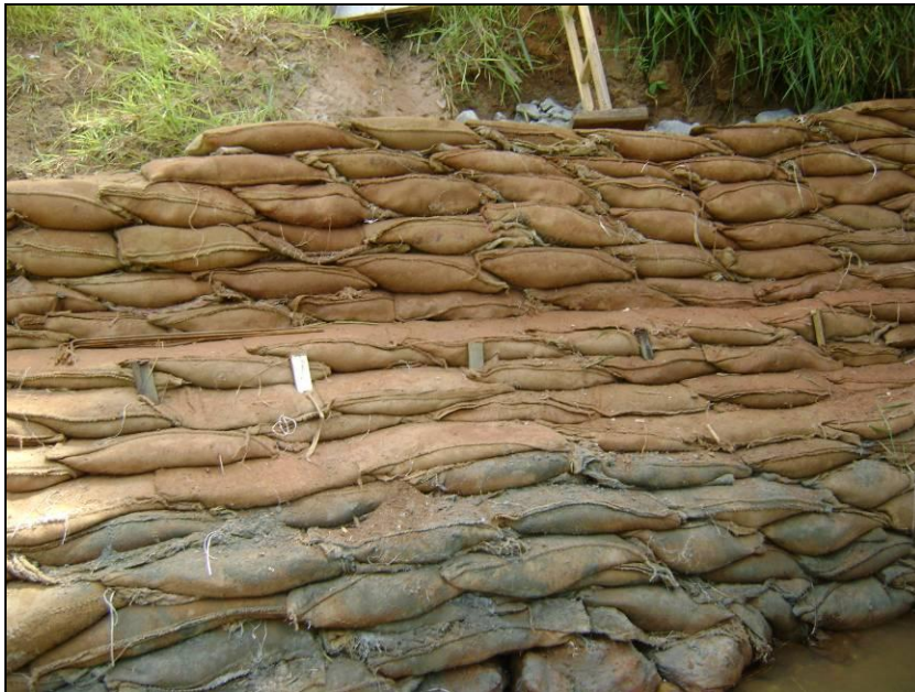
FOTO 2.6.12-25: Conclusão da implantação de contenções as margens de curso d'água, com sacarias e fragmento de rochas, km 94+660 (Fonte: Remma GDK, fev/10).
