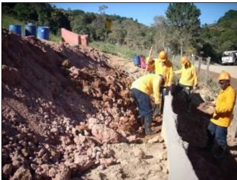
FOTO 2.6.12-13: Detalhe para a execução de contenção lateral de estiva, km 34 (Fonte: Remma Consórcio Gastau, fev/10).
