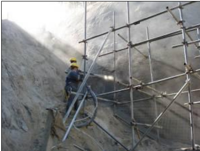
FOTO 2.6.12-14: Procedimento de grampeamento de solo para contenção de processos erosivos, km 35 (Fonte: Remma Consórcio Gastau, fev/10).
