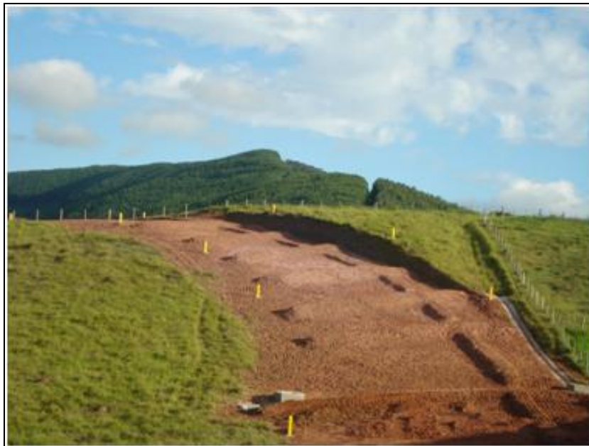
FOTO 2.6.12-37: Leiras definitivas e drenagens implantadas na faixa de servidão no km 41 (Fonte: Remma Consórcio Gastau, abr/10).
