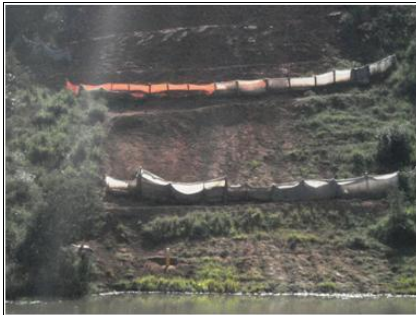
FOTO 2.6.12-18: Contenção de sedimentos com tela-filtro em área íngreme, nas margens da Represa Santa Branca, km 44 (Fonte: Consórcio Gastau, abr/10).
