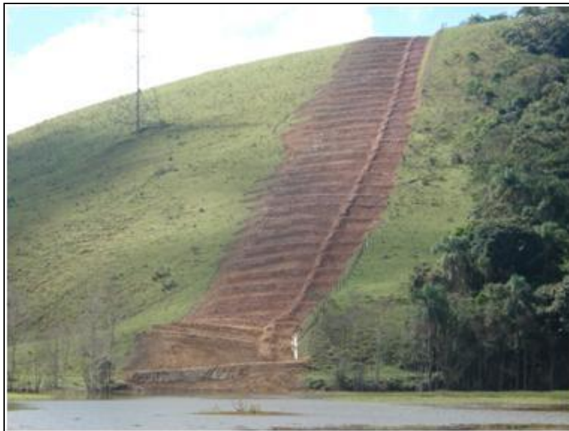
FOTO 2.6.12-32: Recomposição da faixa de servidão, com execução de leiras definitivas, próximo ao rio Lourenço Velho I, no km 13 (Fonte: Remma Consórcio Gastau, abr/10).
