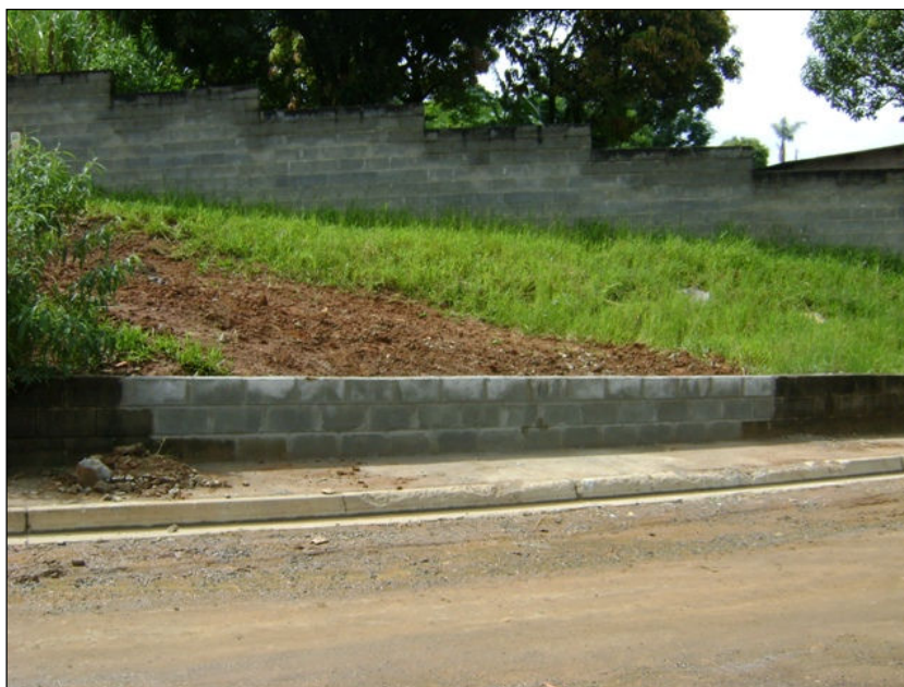
FOTO 2.6.11-33: Recuperação de mureta no acesso ao km 71+160 do Gasoduto (Fonte: Remma GDK, jan/10).
