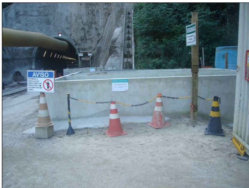
FOTO 2.6.11-99: Início do sistema de tratamento físico-químico do efluente do Túnel (pré-decantador), coordenadas em UTM: N=7.385.818/E= 446.254 (Fonte: Remma Schahin, abr/10).
