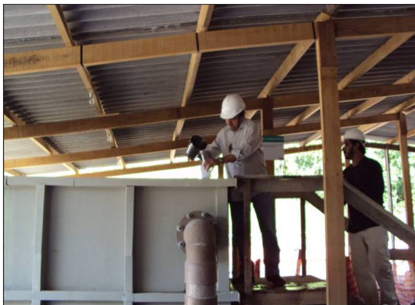
FOTO 2.6.11-103: Amostragem da água do sistema de tratamento de efluentes, coordenadas em UTM: N=7.385.818/E= 446.254 (Fonte: Remma Schahin, abr/10).
