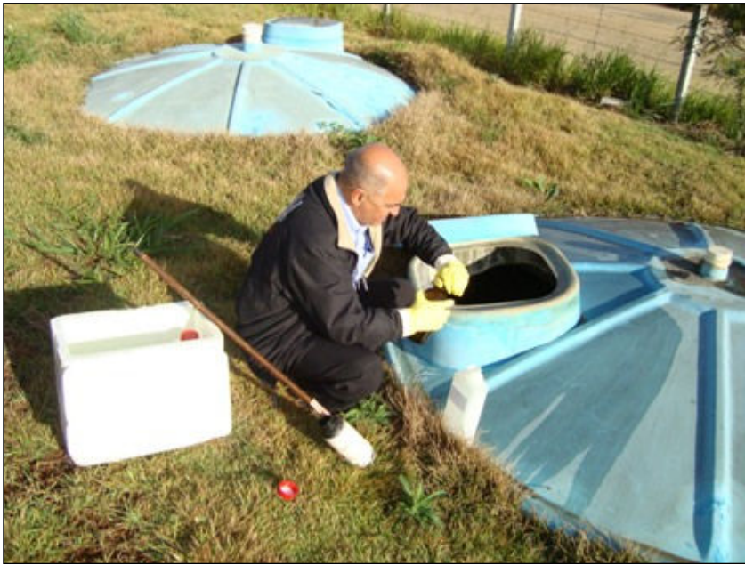
FOTO 2.6.11-13: Sistema de tratamento de efluentes (fossa séptica) implantado no canteiro da GDK (Fonte: Remma GDK, mai/10).
