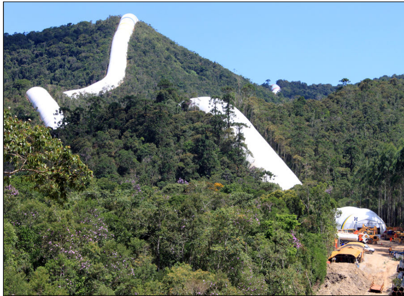
FOTO 2.6.11-115: Vista parcial da cobertura insuflável implantada no trecho entre o km 08+300 e km 11+600 da faixa (Fonte: Petrobras, fev/10).
