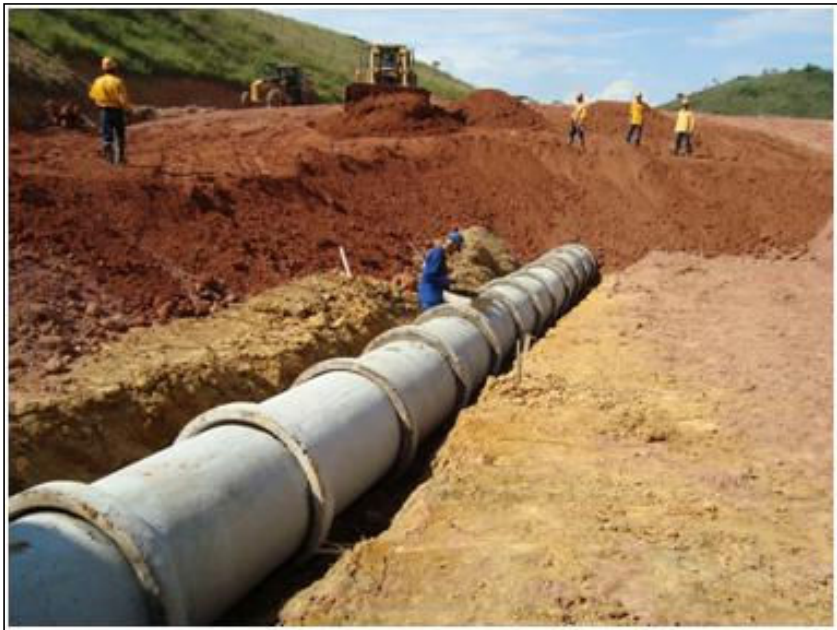
FOTO 2.6.11-48: Instalação de sistema de drenagem no bota-fora 07, coordenadas em UTM: N=7.393.306/E=438.429 (Fonte: Remma Consórcio Gastau, mar/10).
