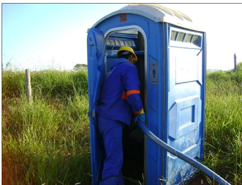
FOTO 2.6.11-31: Higienização de banheiro químico próximo à área de vivência, km 80+160 da faixa (Fonte: Remma GDK, abr/10).
