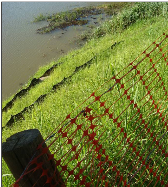
FOTO 2.6.11-87: Detalhe para o desenvolvimento da vegetação nas margens da Represa Santa Branca (Fonte: Lenc, mar/10).
