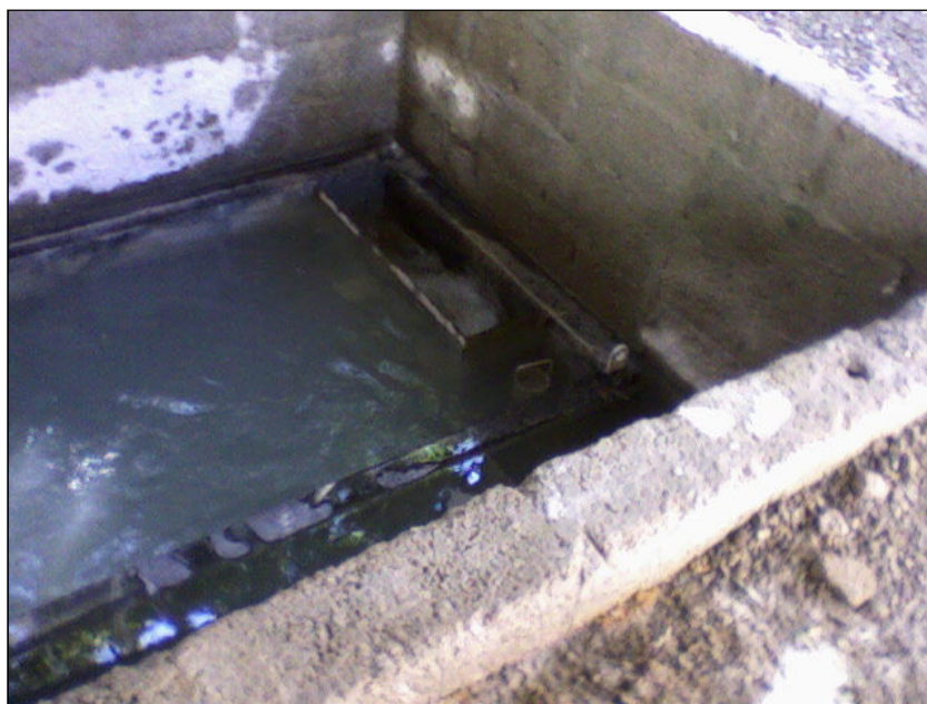
FOTO 2.6.11-102: Vista da saída do sistema de tratamento de efluentes, coordenadas em UTM: N=7.385.818/E= 446.254 (Fonte: Lenc, jun/10).
