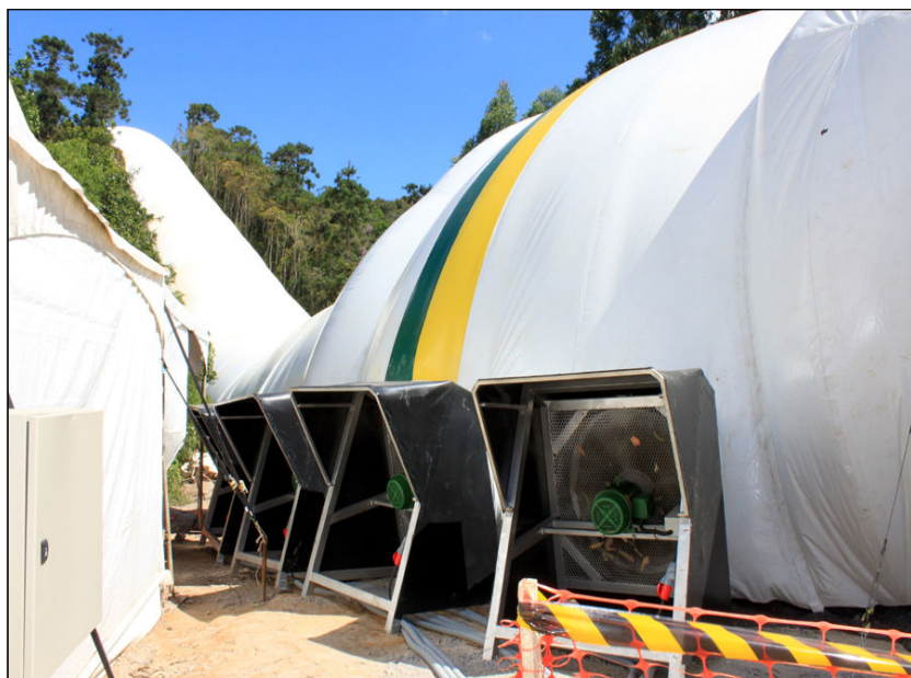
FOTO 2.6.11-110: Detalhe dos insufladores no trecho entre o km 08+300 e km 11+600 da faixa (Fonte: Petrobras, fev/10).
