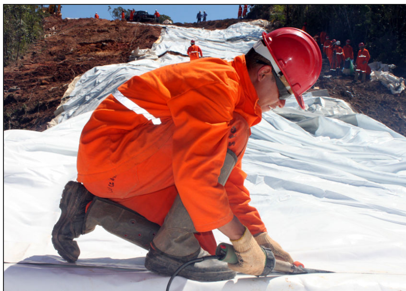
FOTO 2.6.11-105: Soldagem das lonas no trecho entre o km 08+300 e km 11+600 da faixa (Fonte: Petrobras, jan/10).
