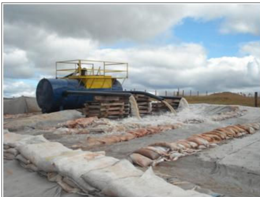
FOTO 2.6.11-60: Estrutura do ponto de descarte da água do teste hidrostático, km 67 da faixa (Fonte: Remma Consórcio Gastau, abr/10).
