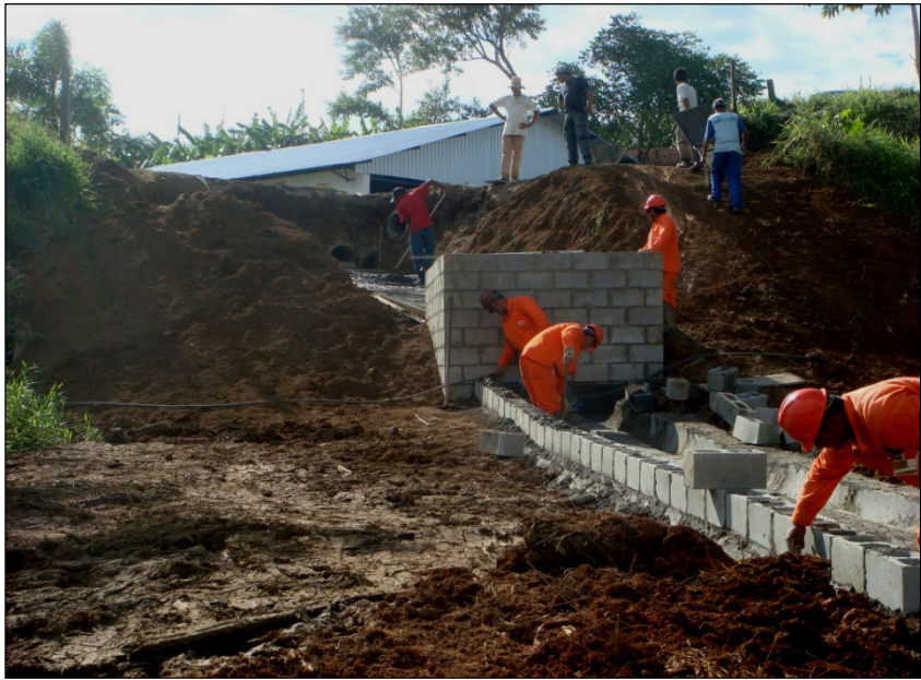
FOTO 2.6.11-70: Construção de sistema de drenagem definitivo no km 82+160 da faixa (Fonte: Remma GDK, abr/10).
