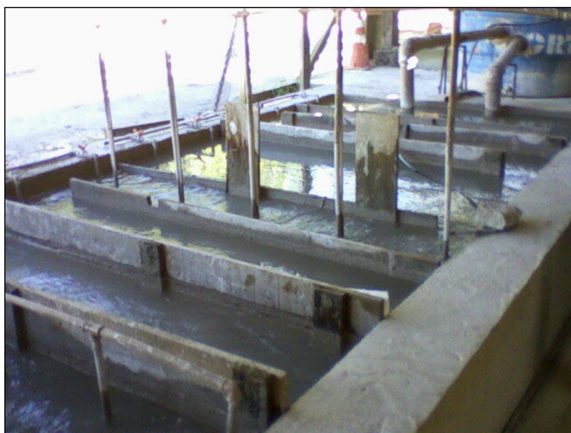
FOTO 2.6.11-100: Vista do tanque de floculação, coordenadas em UTM: N=7.385.818/E= 446.254 (Fonte: Lenc, jun/10).
