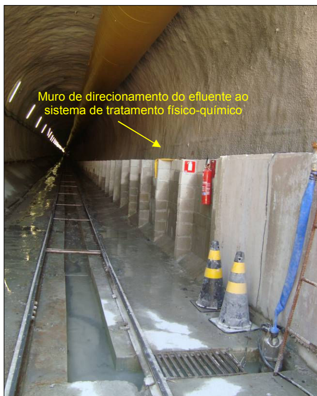
FOTO 2.6.11-98: Vista geral do sistema de drenagem do túnel (Fonte: Lenc, jan/10).
