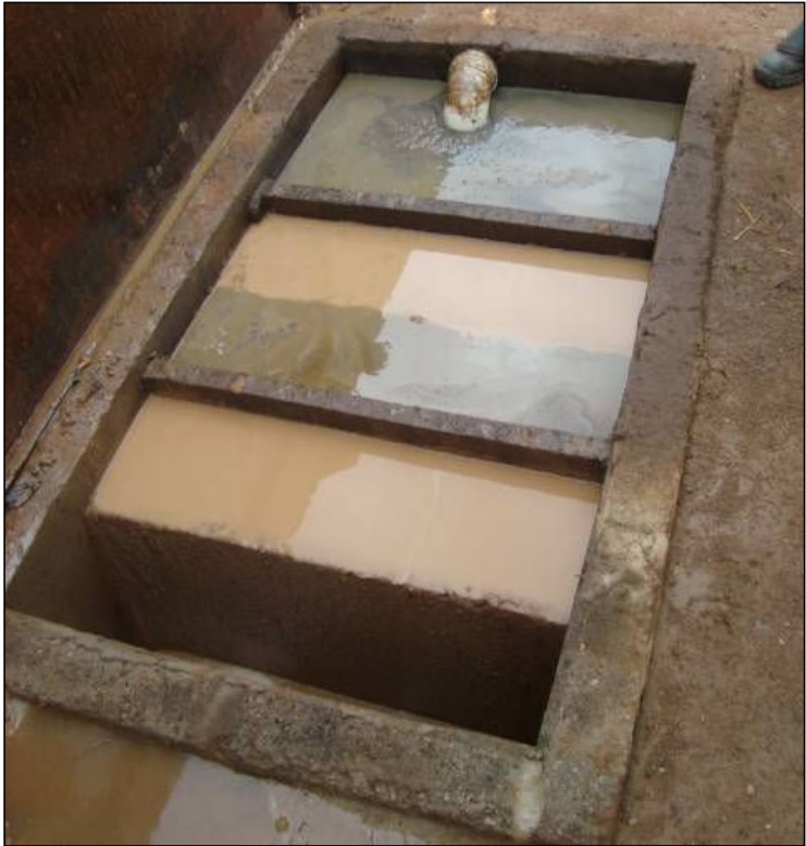
FOTO 2.6.11-12: Detalhe para o sistema de separação água e óleo implantado na área de lavagem de veículos, no canteiro do Consórcio Gastau (Fonte: Lenc, mar/10).
