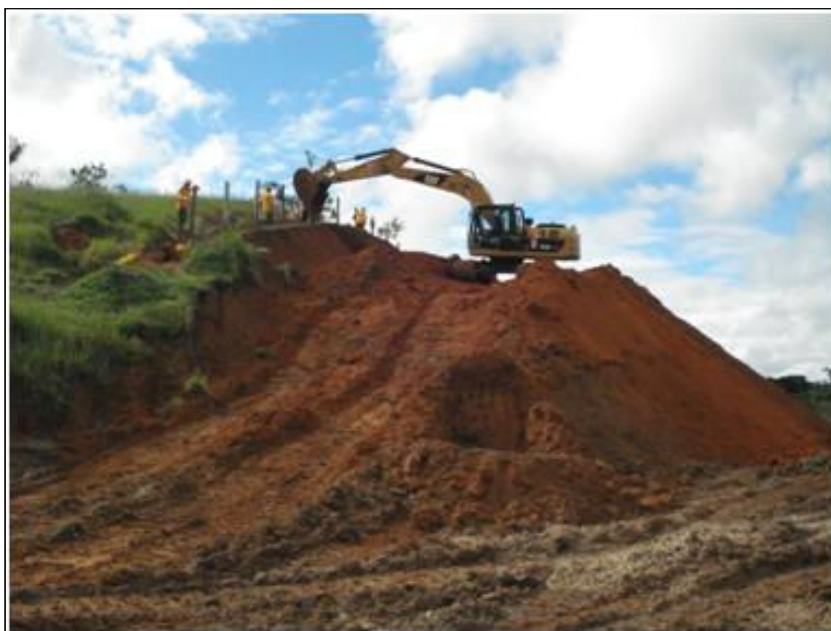
FOTO 2.6.11-44: Corte de talude no km 65+000 (Fonte: Remma Consórcio Gastau, abr/10).
