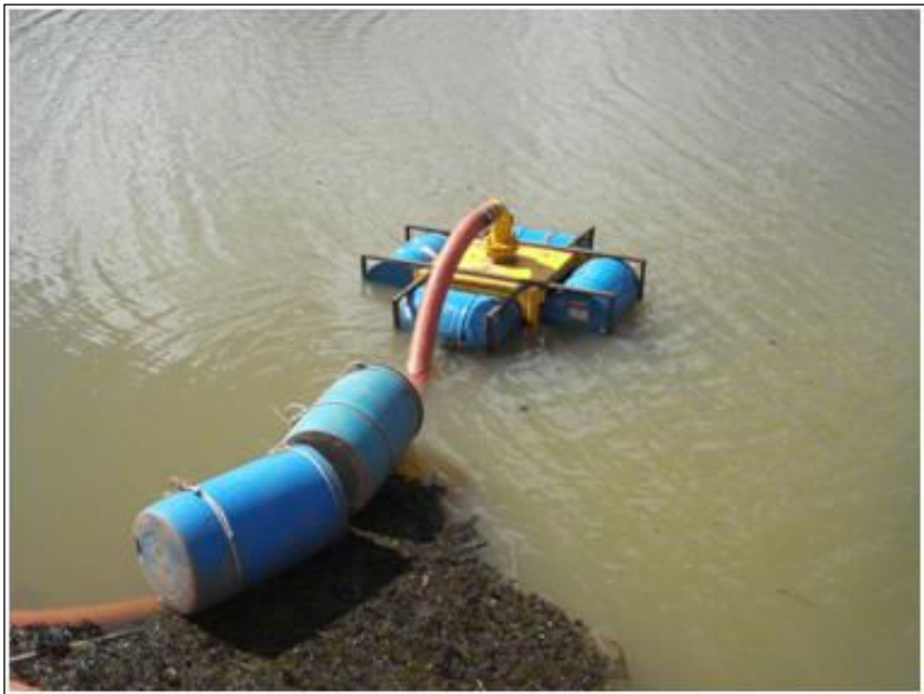
FOTO 2.6.11-59: Utilização de filtro para captação de água, km 46+000 (Fonte: Remma Consórcio Gastau, abr/10).
