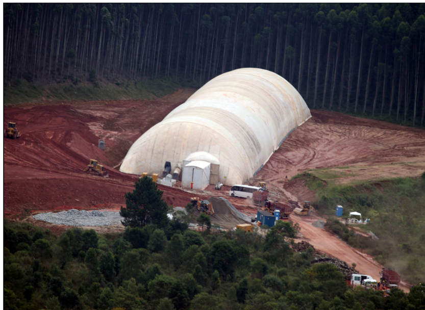
FOTO 2.6.11-116: Vista do bota-fora 03B após implantação da cobertura insuflável (Fonte: Petrobras, fev/10).
