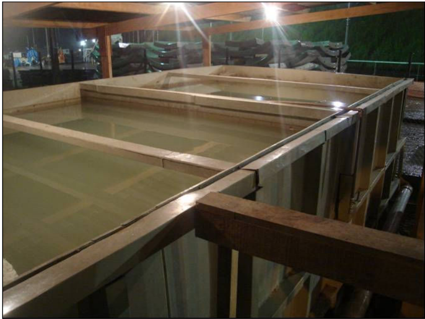
FOTO 2.6.11-15: Sistema de tratamento de efluentes no canteiro operacional da Schahin (Fonte: Remma Schahin, abr/10).
