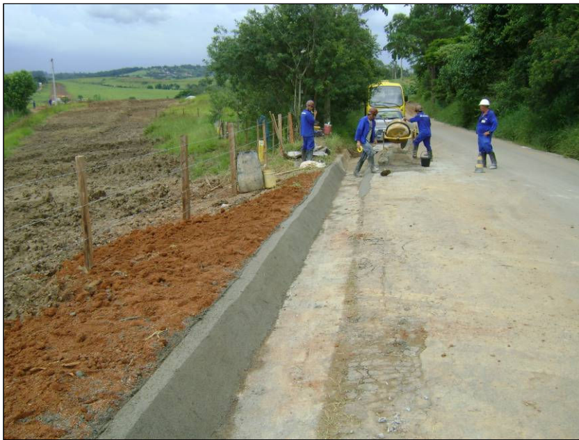
FOTO 2.6.11-36: Construção de guia no acesso ao km 76+160 do Gasoduto (Fonte: Remma GDK, jan/10).
