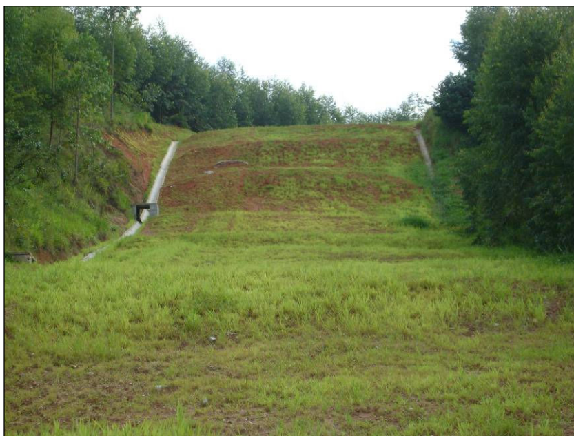
FOTO 2.6.11-72: Instalação de sistema de drenagem definitivo e desenvolvimento da vegetação, após recuperação, km 91+160 da faixa (Fonte: Remma GDK, jan/10).
