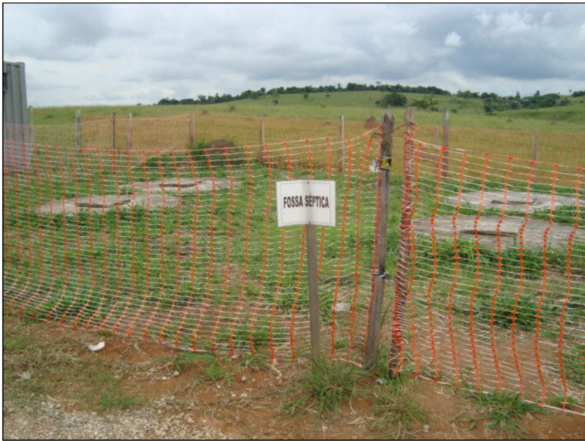
FOTO 2.6.11-14: Sistema de tratamento de efluentes (fossa séptica) implantado no canteiro do Consórcio Gastau (Fonte: Lenc, mar/10).
