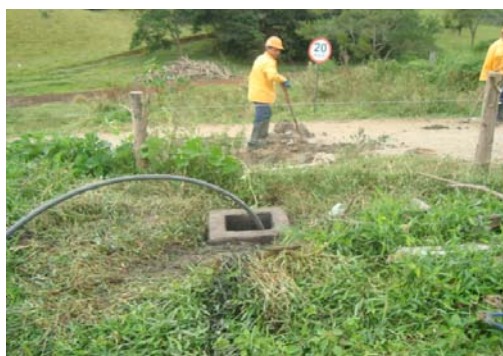
Equipe do Encarregado Zoio, realizado o reparo na rede de esgoto do Sr. Reginaldo -acesso 5 lajeado km 26+600
