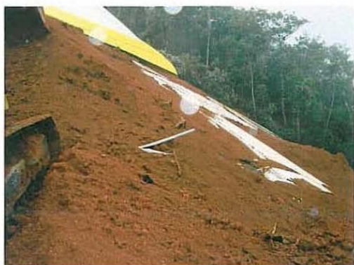
Foto 01 – Vista geral da área afetada
