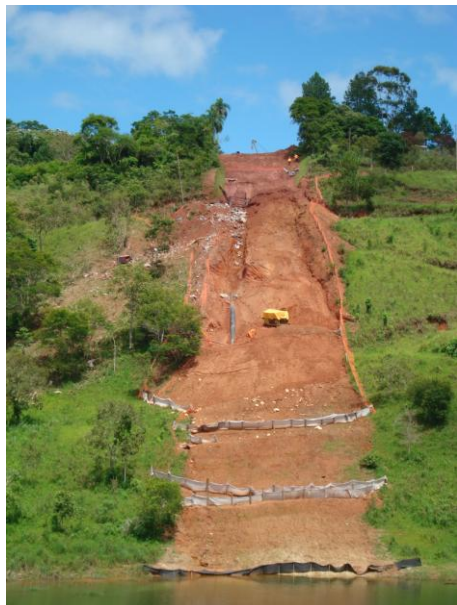
Foto 01 – Vista geral da área afetada
