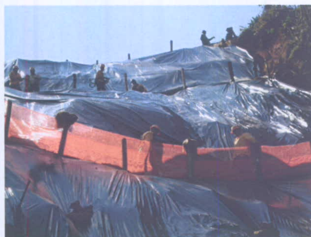
Equipe de monitoramento ambiental instalando lona plástica e contenções provisórias para proteção do talude
