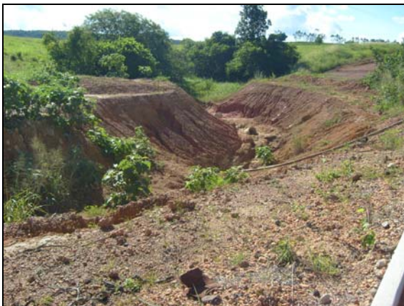
Foto 27 - Erosão em drenagem de estrada mal planejada. Coordenadas 4,5206S 47,5037W
