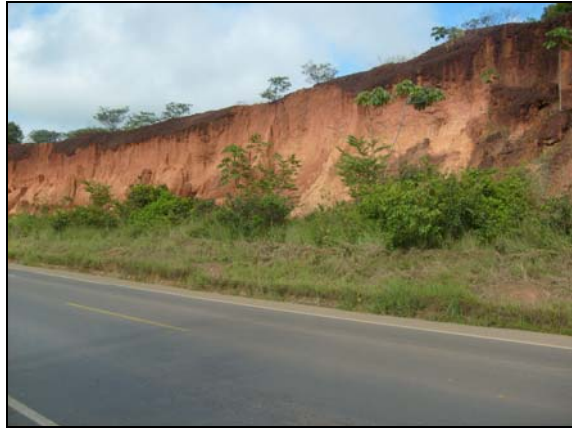
Foto 30 - Corte de estrada em Latossolo Amarelo Distrófico textura argilosa relevo suave ondulado com escorrimento (LAd2). Superfície com concreções. Coordenadas 4,1679S 47,5444W
