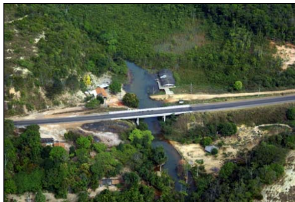
Figura II.5.1-29 - Depósito aluvionar sob a ponte
