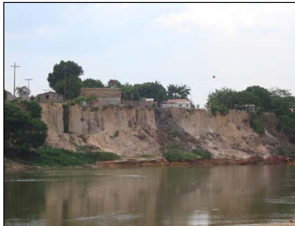
Figura II.5.1-47 - Movimentos de massa do tipo rotacional na margem côncava do canal, deflagrados pelo solapamento da base pela ação do rio
