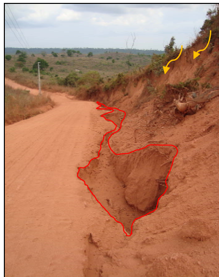
Figura II.5.1-46 - Ravina na base do talude de corte de uma estrada vicinal. O aprofundamento do sulco erosivo (polígono em vermelho) acaba por induzir o colapsamento do material na encosta (linhas laranja)
